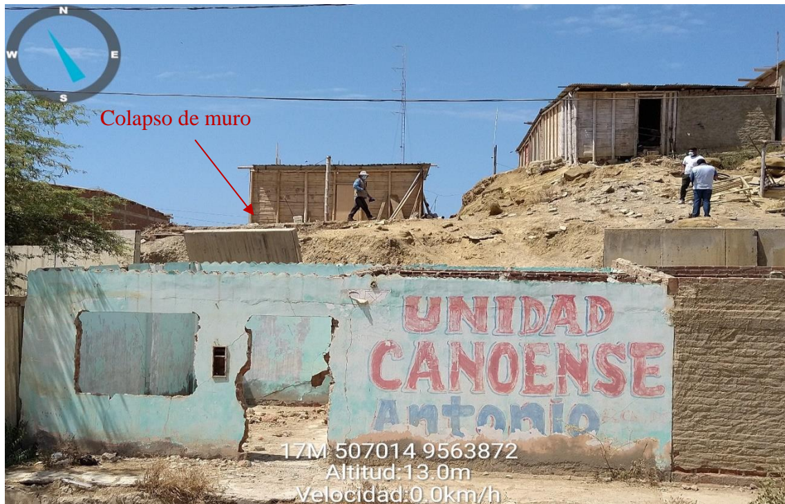
Figura 7.- Muro ubicado en la parte baja de una loma y posterior a viviendas de la Calle 1 del sector Sr. De Los Milagros que colapsó probablemente por erosión de laderas durante las precipitaciones pluviales intensas
