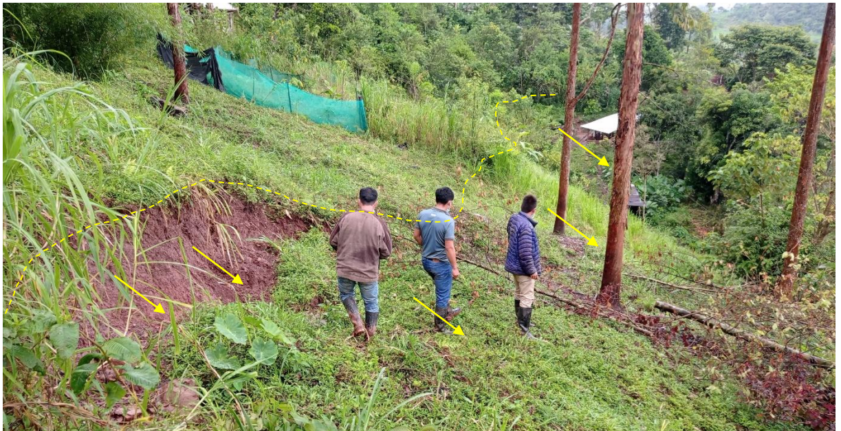
Figura 21. Vista lateral de la zona de arranque del deslizamiento.
