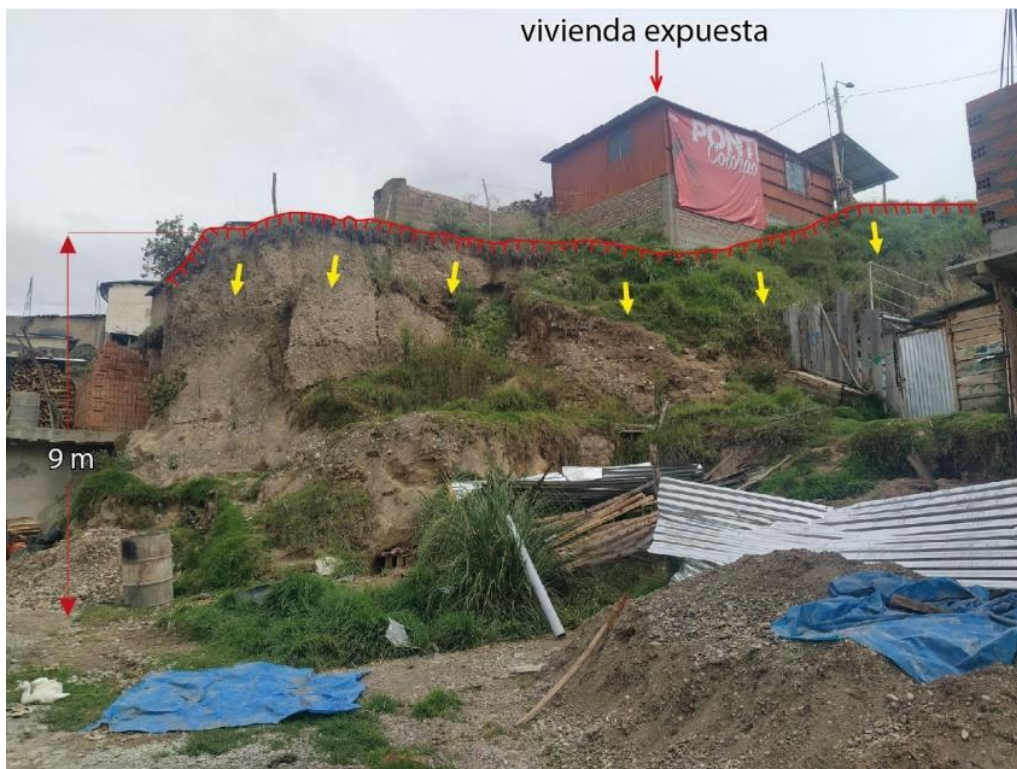
Figura 23. Derrumbes recientes en el Talud del barrio de Palia.
