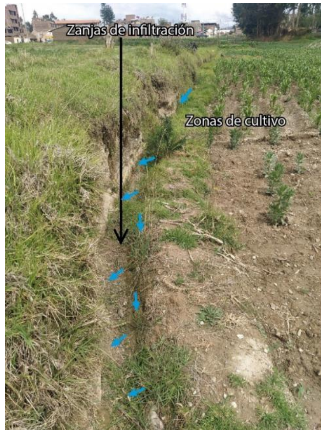
Figura 26. Infiltración de agua en la plataforma del talud 1.
