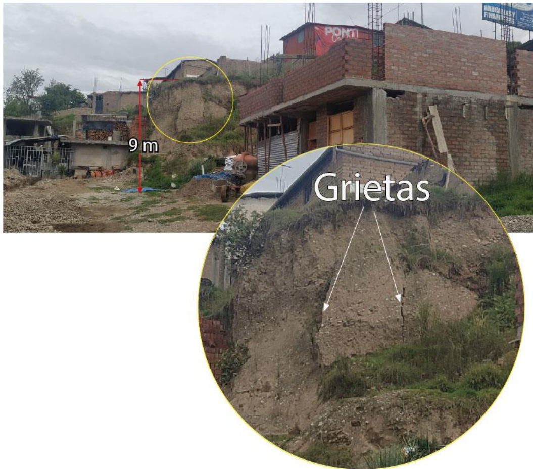
Figura 25. Grietas en el Talud del barrio de Palia.
