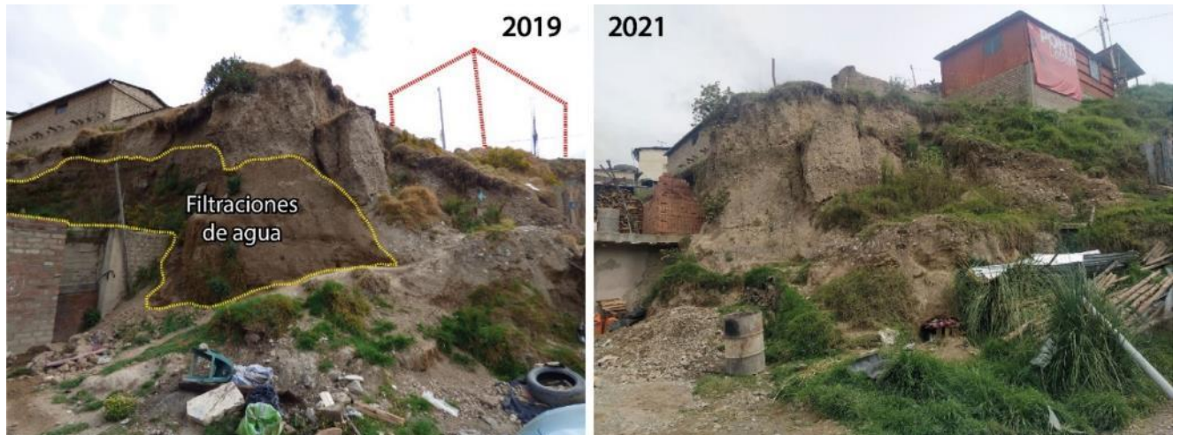
Figura 22. Diferencia de filtraciones de agua entre el 2019 y 2021 en el talud del barrio Palia.
