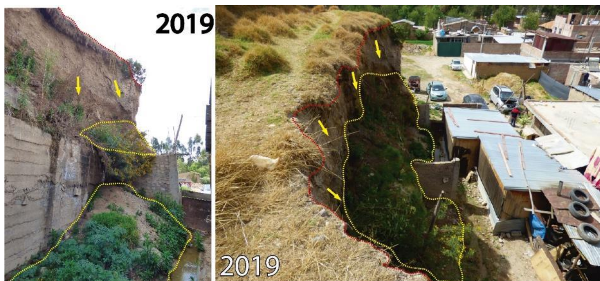
Figura 20. Derrumbes en el talud del barrio de Palia (fotografías: Nuñez & Albinez 2019)
