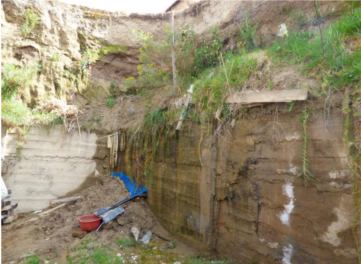
Fotografía 1. Derrumbes en el talud del barrio de Palia (fuente: Nuñez & Albinez 2019)
