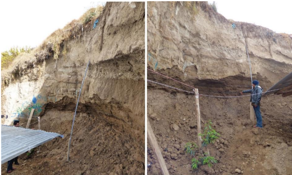
Figura 21. Socavamientos en el pie del talud del barrio de Palia, producto de la filtración de aguas (Fuente: Nuñez & Albinez 2019)
