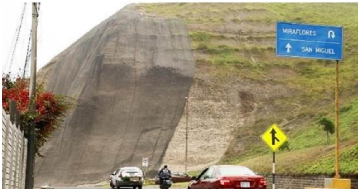
Fotografía 6. Ejemplo Combinación de geomallas y vegetación en los acantilados de la Costa Verde (Lima)
