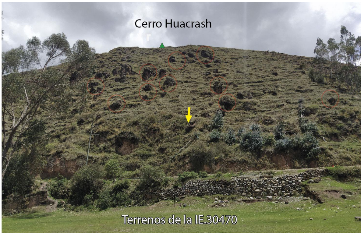
Figura 13. Ladera suroeste del cerro Huacrash, evidencia bloques de rocas (conglomerados), sobresalientes susceptibles a caer.
