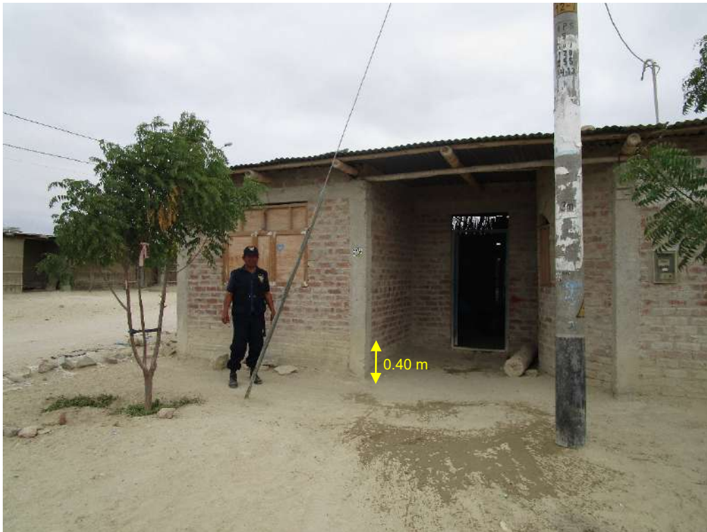
Foto 10. El agua llegó a los 40 cm de altura, afectó a las viviendas localizadas en el sector Tablazo Norte.
