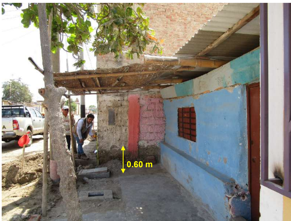
Foto 08: Vivienda localizada en el Sector urbano 8 de Diciembre, afectado por inundaciones, se evidencia la marca de la altura de agua que llegó a 0.60 m.
