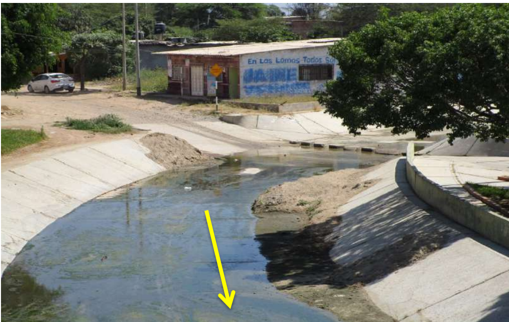
Foto 14: Sedimentación en el Canal Vía, esto impide el fácil flujo de las aguas hasta su desembocadura (río Chipillico). La flecha amarilla indica la dirección del flujo
