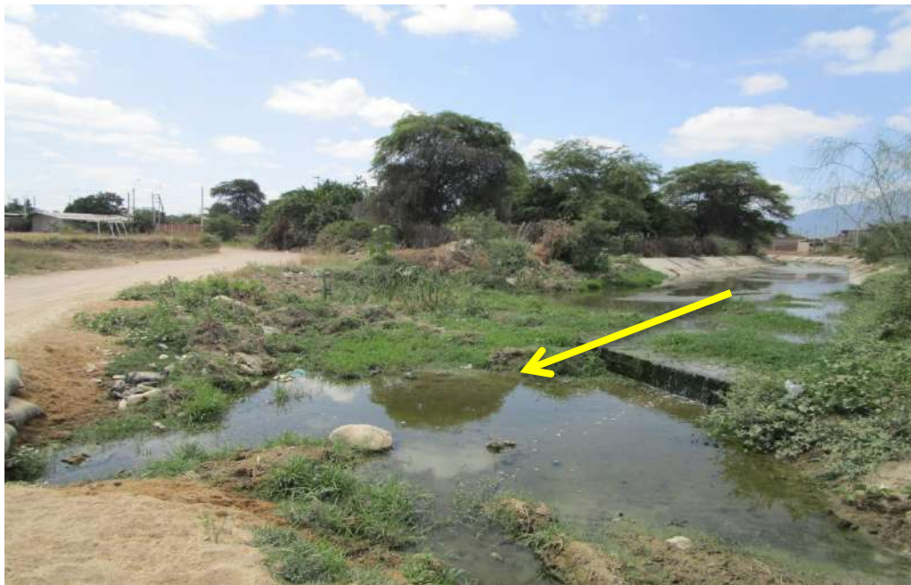
Foto 12: Hasta el límite del AA.HH. Bellavista con Juan Velazco esta canalizada la quebrada, luego se encuentra estrecho y obstruido que, en épocas de lluvias se desborda e impide el paso de vehículos a otros anexos. La flecha amarilla indica la dirección del flujo
