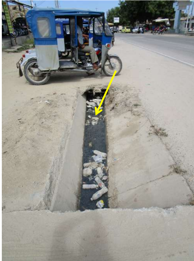
Foto 15: Falta de mantenimiento en las cunetas, genera las inundaciones pluviales
