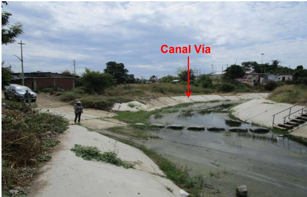
Foto 11: Canal Vía, en épocas de precipitaciones se desborda afectando a los AA.HH. de Buenos Aires, Miraflores, Santa Rosa, Juan Velazco y casco urbano de la ciudad de Las Lomas
