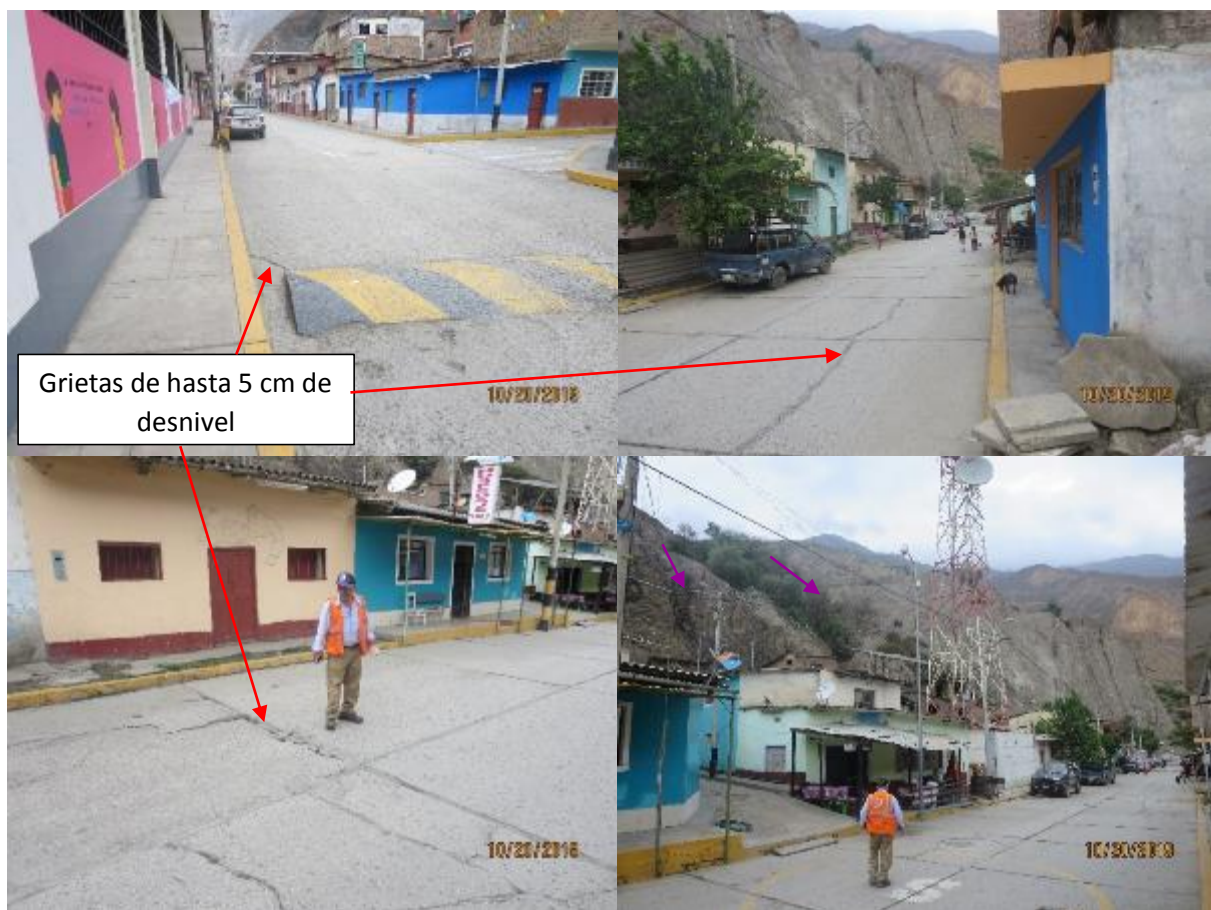
Figura 69. Evidencias de agrietamiento en el pavimento, con desniveles de 5 cm; así como de 3m y 8m de longitud, se presentan también fisuras en las viviendas de Buenos Aires y 4 de abril; las mismas que se prolongan en menor cantidad hasta el colegio e instituto secundario industrial
