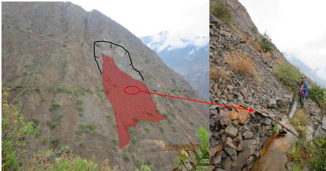
Figura 42. Identificación de caída de rocas que afectó el canal de riego artesanal, hace 10 años aproximadamente y que hoy sigue afectando, dicho canal distribuye agua hacia las áreas agrícolas y a la población de C.P. Pampa La Libertad. Fuente: Elaboración propia 2019.
