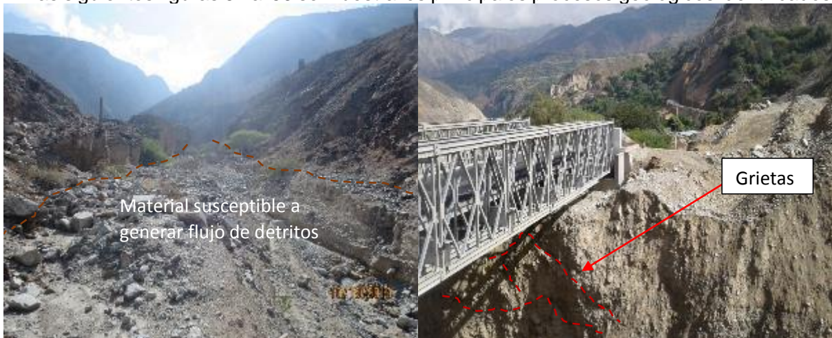
Figura 52. Material inconsolidado y poco consolidado, que se ubica en la quebrada seca, al generarse puede ocasionar la destrucción de este puente temporal, donde los suelos se están agrietando: Elaboración Propia, 2019
