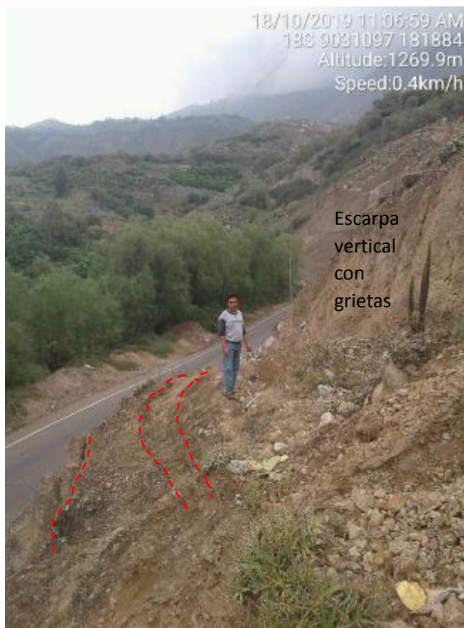
Figura 59. Fuera de la zona de influencia del C.P. Yungaypampa se identificó una zona con agrietamientos en el talud superior, formado por material no consolidado, susceptible a procesos por movimientos en masa, que afecta tramo de carretera asfaltado Yungaypampa-Yuracmarca.
