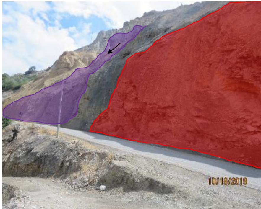
Figura 55. Identificación de un área susceptible a flujos de detritos y derrumbes que pueden dejar incomunicado el tramo de carretera Yungaypampa-Yuracmarca.
