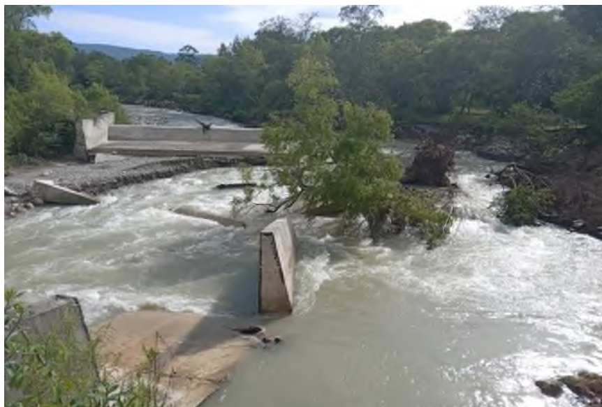
Fotografía N° 04: Erosión del talud en la margen izquierda del río Doña Ana .
