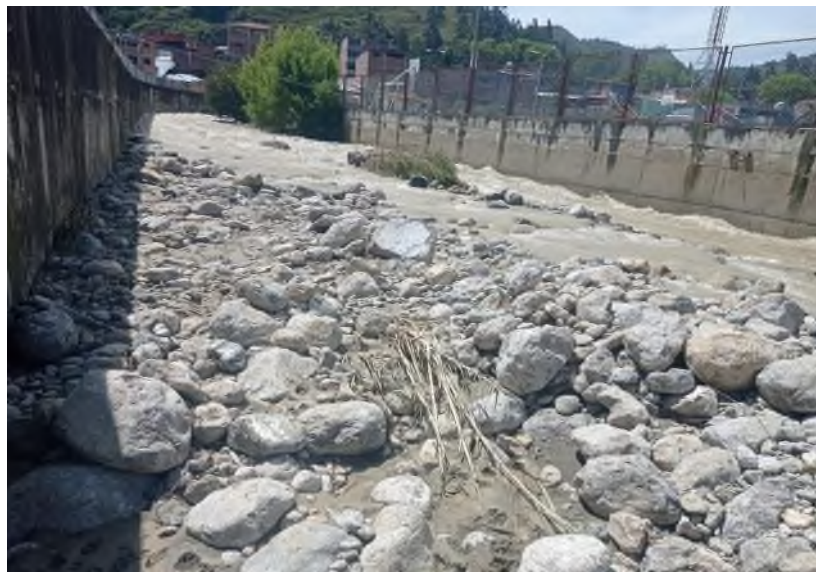
Fotografía N°01: : Acumulacion de roca y sedimento en el cauce del río Chotano .
