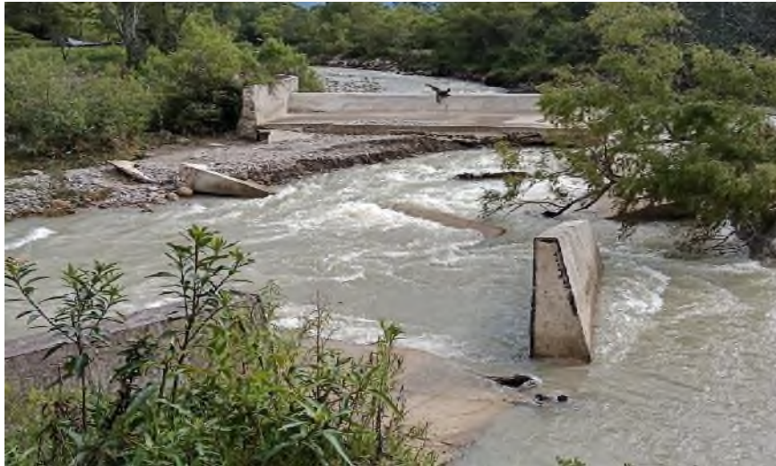
Fotografía N° 02: :Erosión del cauce y del talud en el sector Pingobamba del río Doña Ana .
