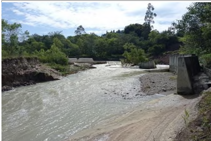
Fotografía N° 03: Afectación a las bocatomas d los canales San José y Santa Isabel
