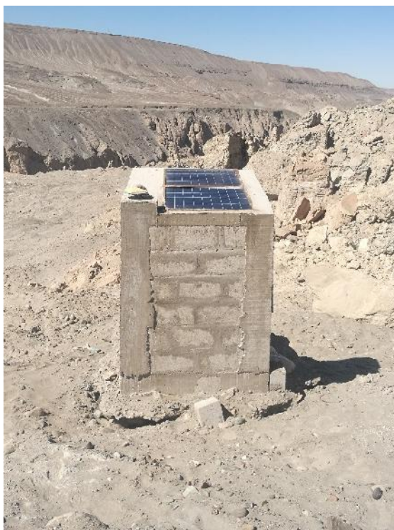
Figura 6. Estación GNSS de registro continuo y transmisión en tiempo real, dentro de una caseta de concreto.
