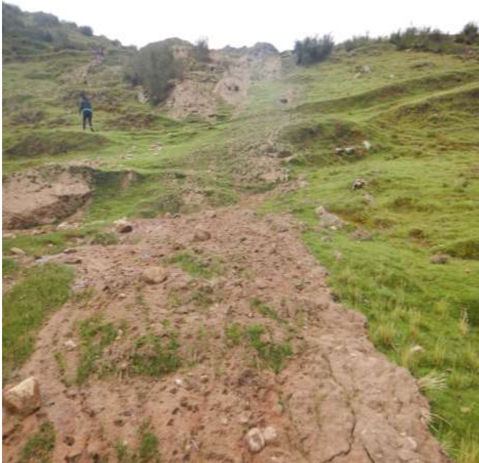
Fotografía 1. Se observa material fino que cubre parte de la ladera, producto de las precipitaciones pluviales
