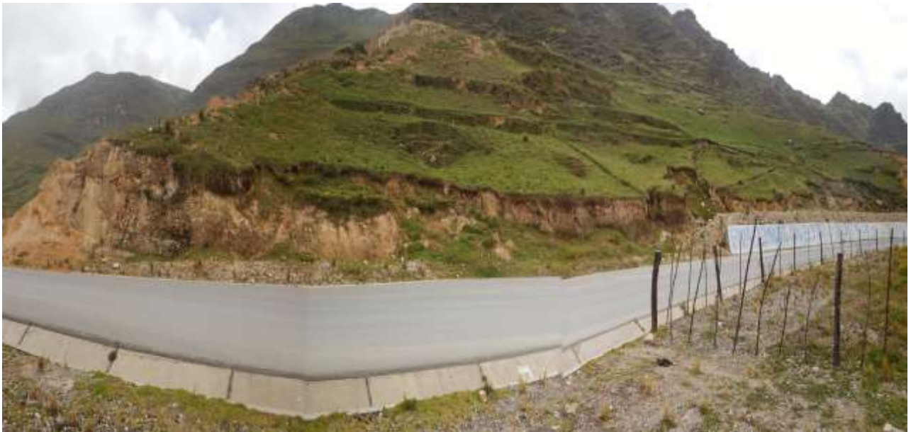
Fotografía 9. Muro de contención en un tramo de la carretera Chipipata-Huanca como medida de mitigación ante derrumbes
