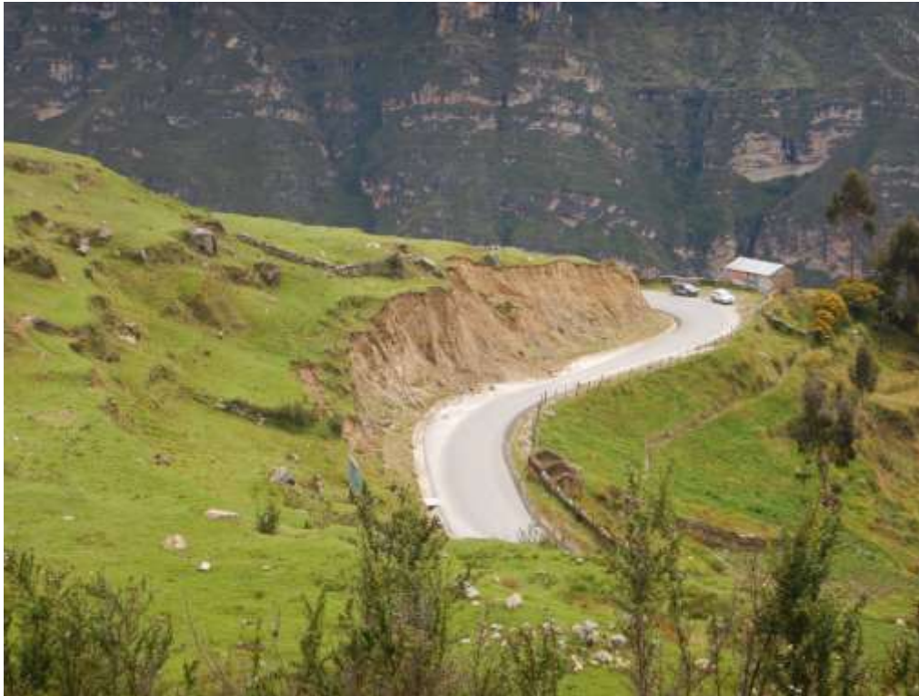
Fotografía 8. Derrumbes a lo largo de la carretera Chipipata-Huanca
