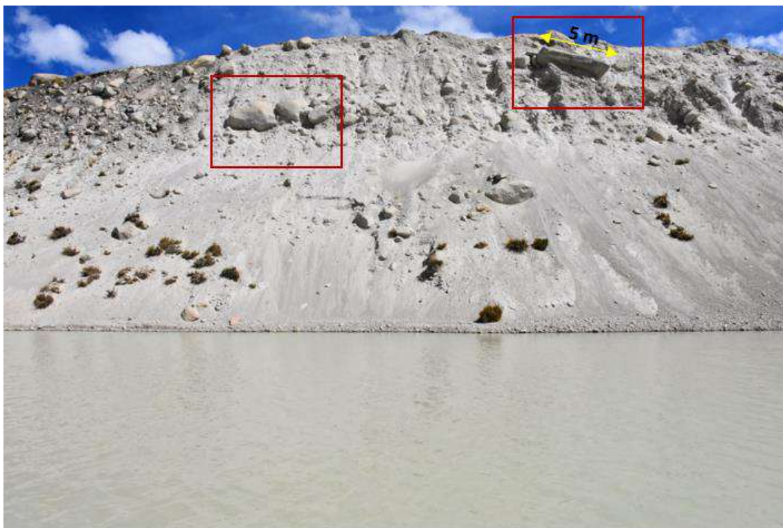
Figura 11. Flanco derecho, identificación de rocas con potencial a caídas y presencia de vegetación como indicador de estabilidad en los taludes (Foto del 18/06/2021, Vilca O.)
