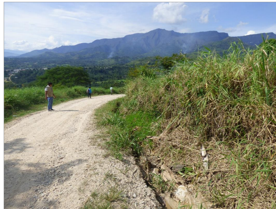
Fotografía 1. Se aprecia cuneta de la vía sin revestimiento, cubierta por vegetación, lo que origina estancamientos de agua y por ende filtración.
