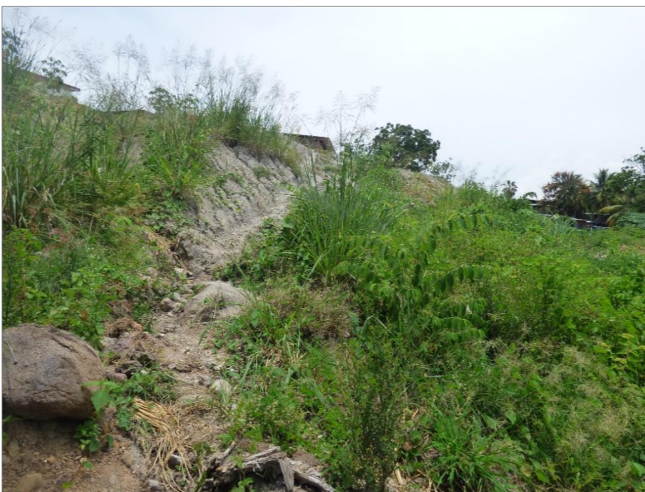
Fotografía 11. Procesos de erosión de ladera, que afectó el frente de la zona de relleno.
