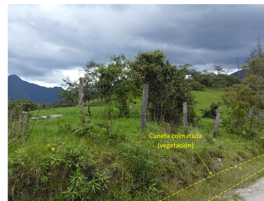
Figura 13. Se aprecia cuneta de la vía sin revestimiento, cubierta por vegetación, lo que origina estancamientos de agua.
