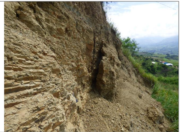
Fotografía 14. Escarpe principal del deslizamiento, se muestra el fracturamiento de la roca.
