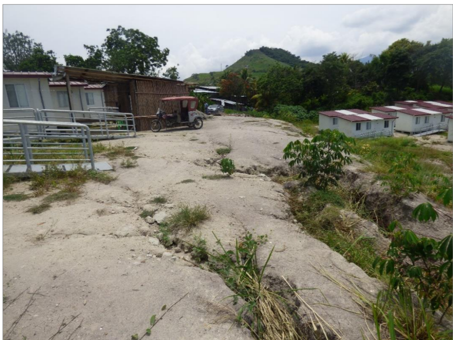
Fotografía 10. Procesos de erosión de ladera, que afectó zona de relleno.
