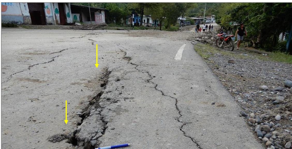
Figura 8. Grietas en carretera de ingreso al caserío El Salao.
