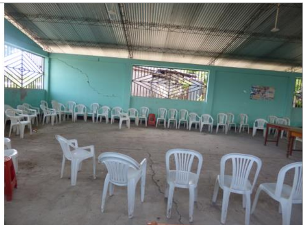
Fotografía 6. Agrietamiento de las paredes y el piso, local comunal.
