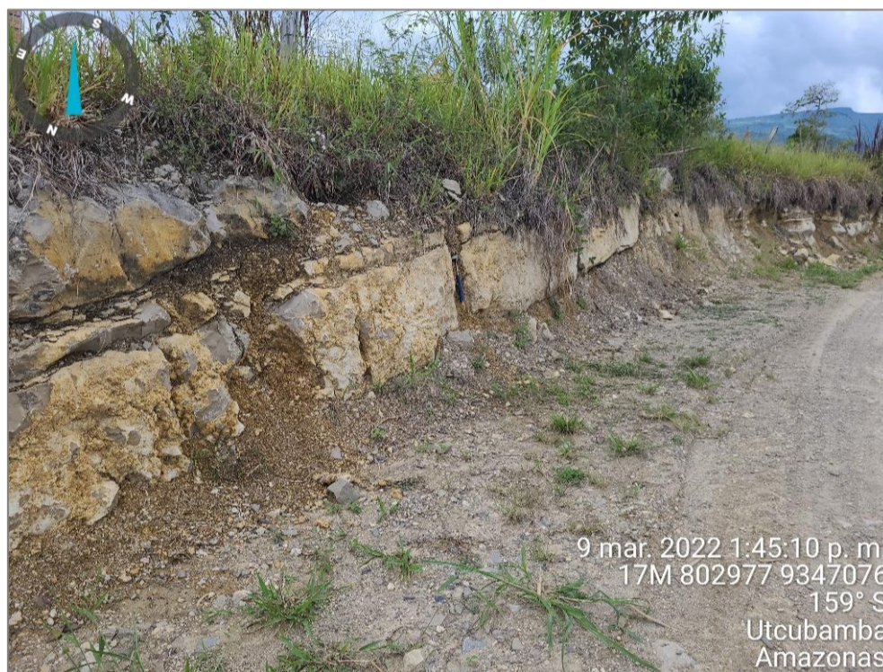
Fotografía 20. Se aprecia ausencia de drenaje tipo cuneta en la vía Pururco hacia cuneta de la vía sin revestimiento, cubierta por vegetación, lo que origina estancamientos de agua.
