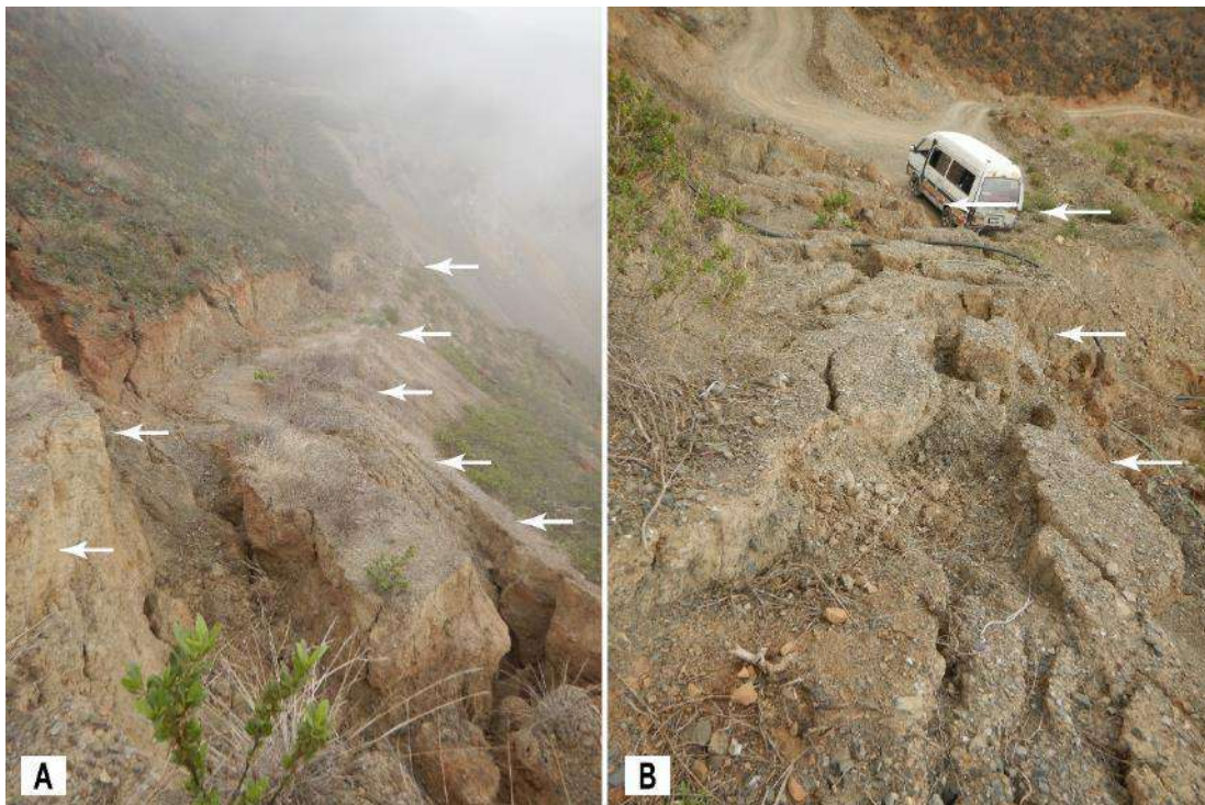
Figura 17. Vestigios de la trocha carrozable (flechas blancas) evidenciados en el cuerpo del deslizamiento. A. Presenta la destrucción de 215 m lineales de trocha carrozable. B. Muestra la destrucción de 135 m líneas de trocha.
