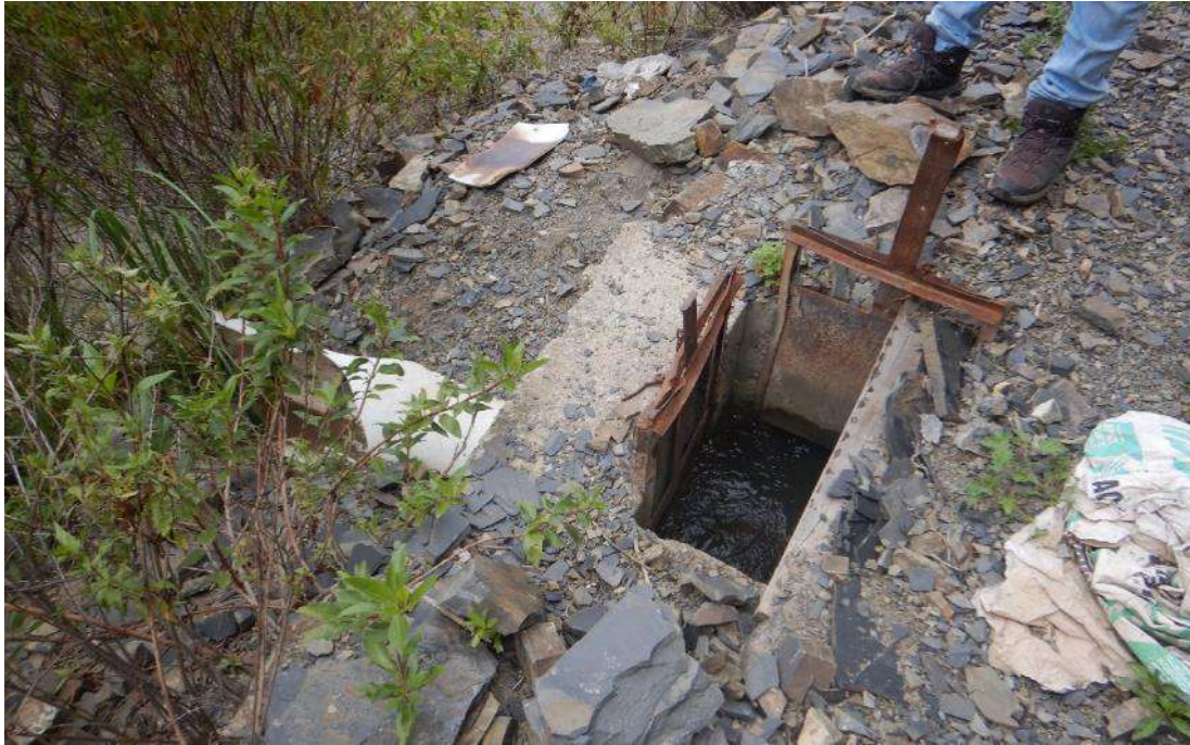
Fotografía 1. Tuberías de irrigación que pasan por encima de la corona del deslizamiento.
