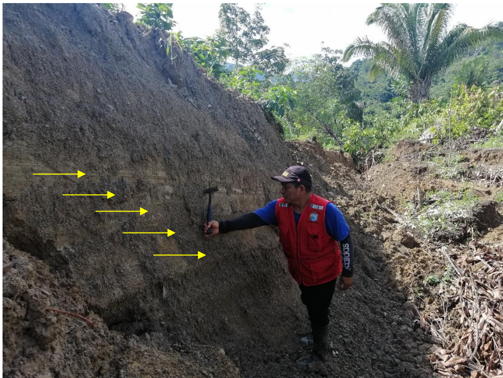
Figura 13: Estrías de movimiento ubicadas en la escarpa lateral izquierda.
