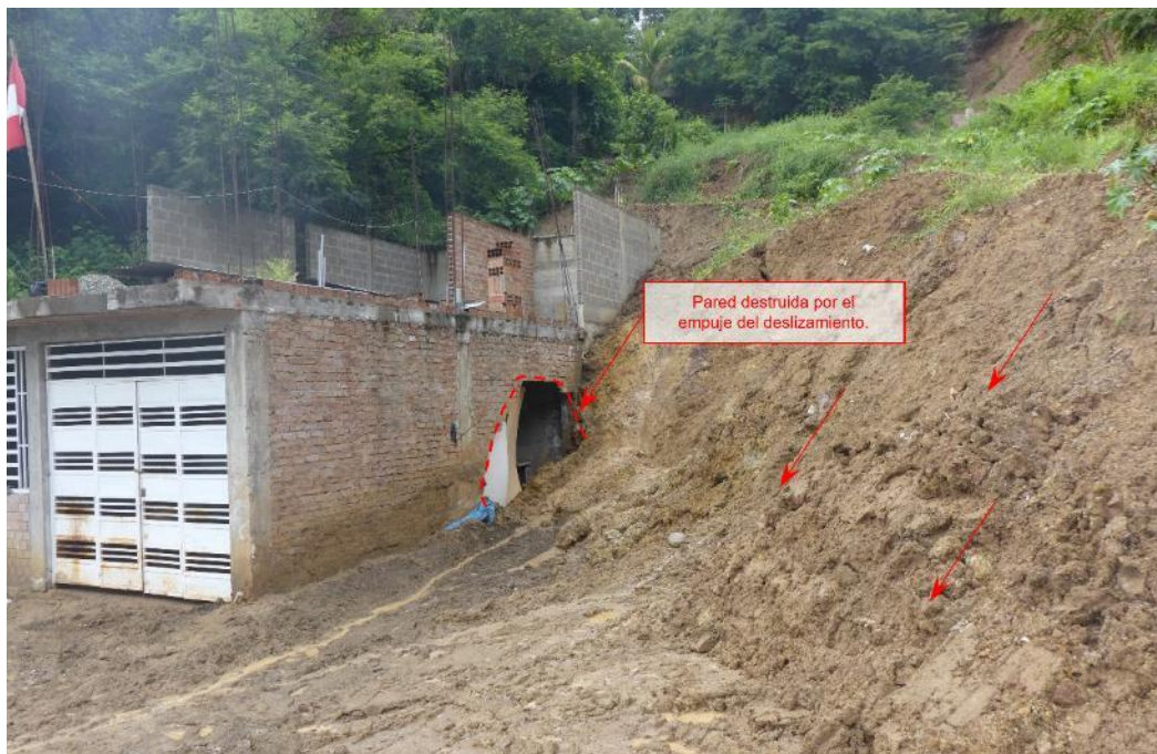
Figura 11. Vivienda afectada por el empuje del deslizamiento. Coordenadas UTM WS-84 -17S, Norte: 9369346 – Este: 741946.
