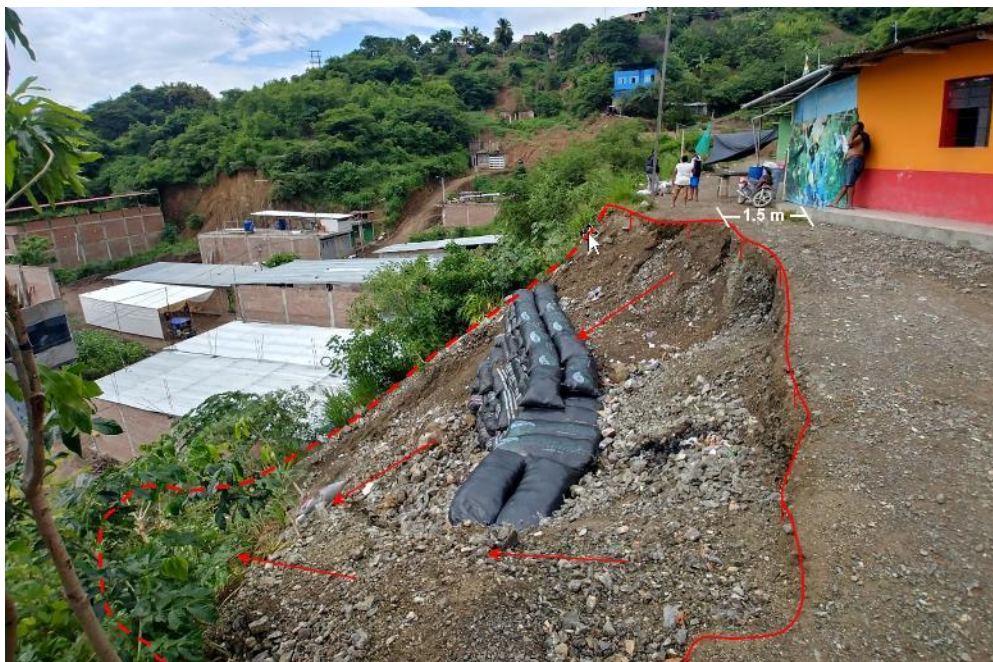
Figura 14. El derrumbe afectó la carretera en la prolongación Gabriel Carrasco en un tramo de 15 m. Coordenadas UTM WS-84 -17S, Norte: 9385508 – Este: 778919
