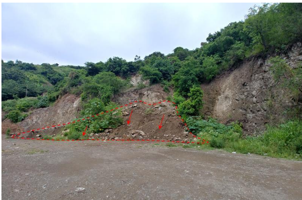
Figura 8. Los cortes de los taludes (para construcción de viviendas) en forma vertical, donde se tienen afloramientos de rocas volcánicas muy fracturadas, con cobertura (suelo) inconsolidada, son propensos a derrumbes.
