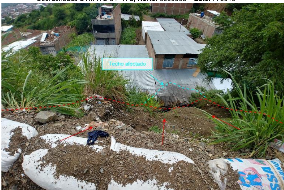
Figura 15. Vivienda ubicada en la parte baja del derrumbe afectada en la parte posterior por el material transportado.
