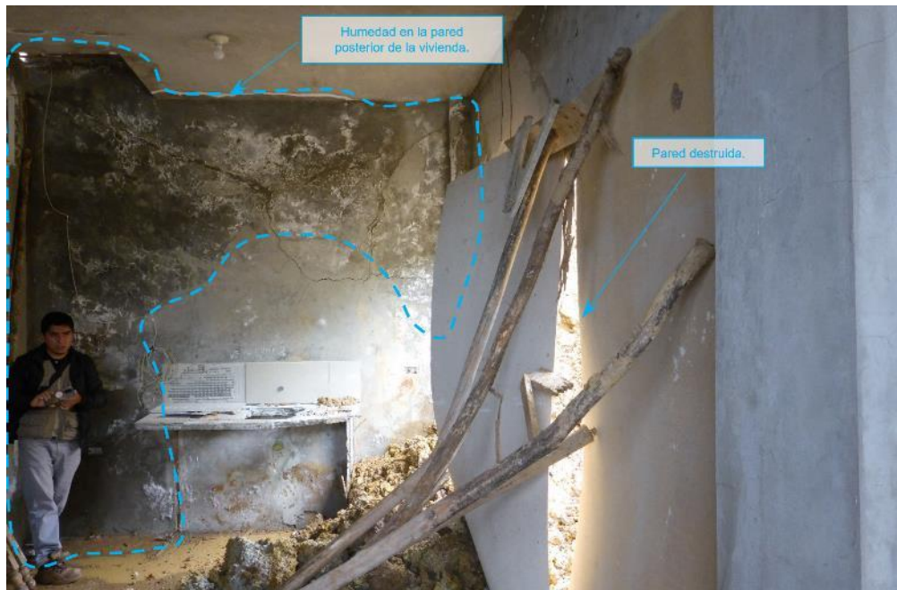
Figura 12. Pared lateral colapsada y presencia de humedad en la pared posterior, debido al material deslizado. Coordenadas UTM WS-84 -17S, Norte: 9369346 – Este: 741946.
