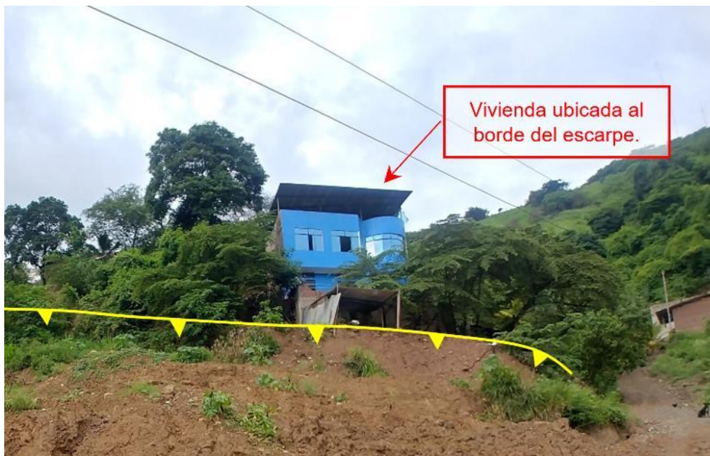
Figura 13. Vivienda ubicada al borde del escarpe principal, podría ser afectada por reactivación del deslizamiento. Coordenadas UTM WS-84 -17S, Norte: 9369351 – Este: 741920.
