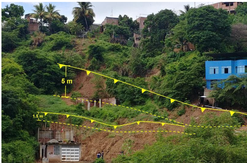
Figura 5. Se observa el escarpe principal con un salto promedio de 5 m y escarpe secundario con un salto de 1 m. Coordenadas UTM WS-84 -17S, Norte: 9369346 – Este: 741930.
