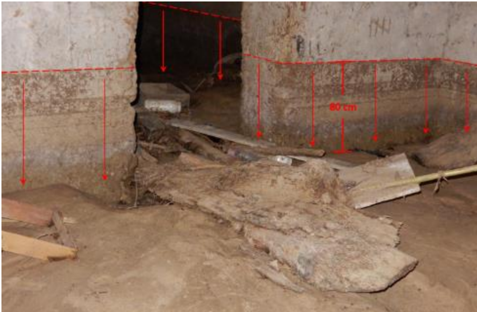
Figura 13. Flujo de detritos ingresó a vivienda alcanzando una altura de 80 cm, ocasionando pérdidas materiales y dejando la vivienda inhabitable.
