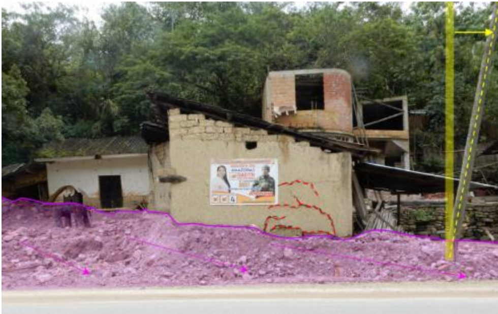
Figura 14. Flujo de detritos en la parte baja afectó postes de tendido eléctrico y viviendas dejándolas inhabitables.
