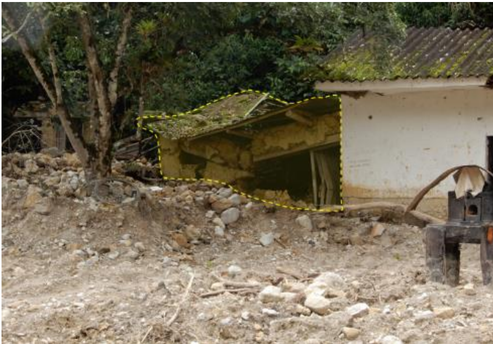
Figura 15. Parte de la vivienda quedó destruida por la llegada del flujo de detritos.
