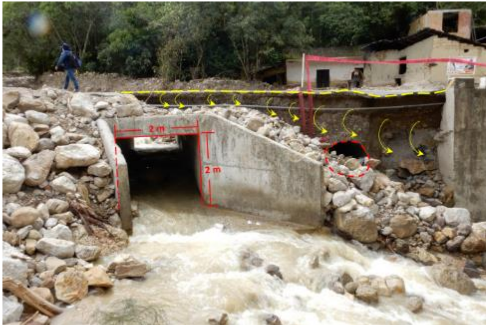
Figura 16. Durante el evento del 3 de abril de 2021, el flujo de detritos obstruyó la alcantarilla de concreto, y socavó la base de la carpeta de asfalto de la carretera, esta alcantarilla se construyó con la finalidad de remplazar una alcantarilla de tubo metálico con menor tamaño.
