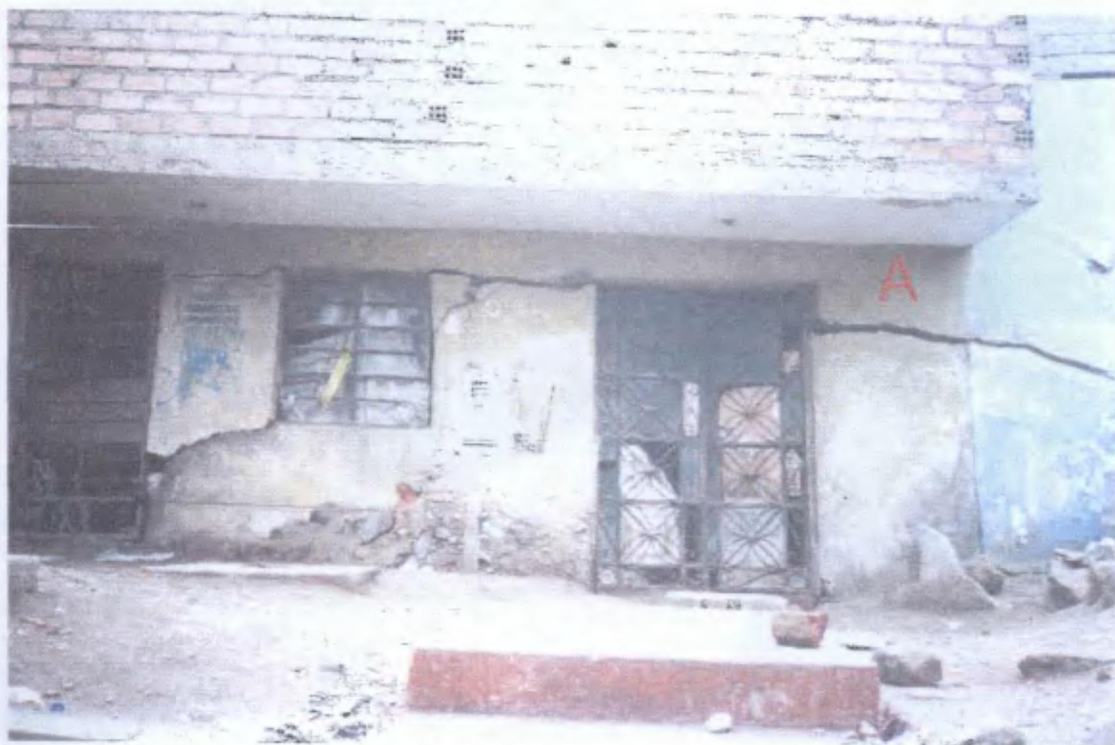
FOTO N° 10: Apréciense las grietas existentes (A) en la vivienda del pasaje José Olaya Mz F - Lt 4, que sufrió un asentamiento hace 18 años.
