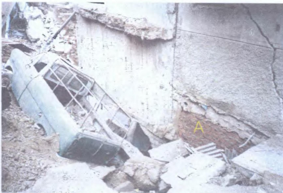
FOTO N° 9: Ubicación de una pared de concreto (A) del sótano de la vivienda del pasaje José Olaya Mz C - Lt 1, que en la segunda visita realizada a la zona ya se había derrumbado, evidenciando esto que la caída de las estructuras de las viviendas continúa.
