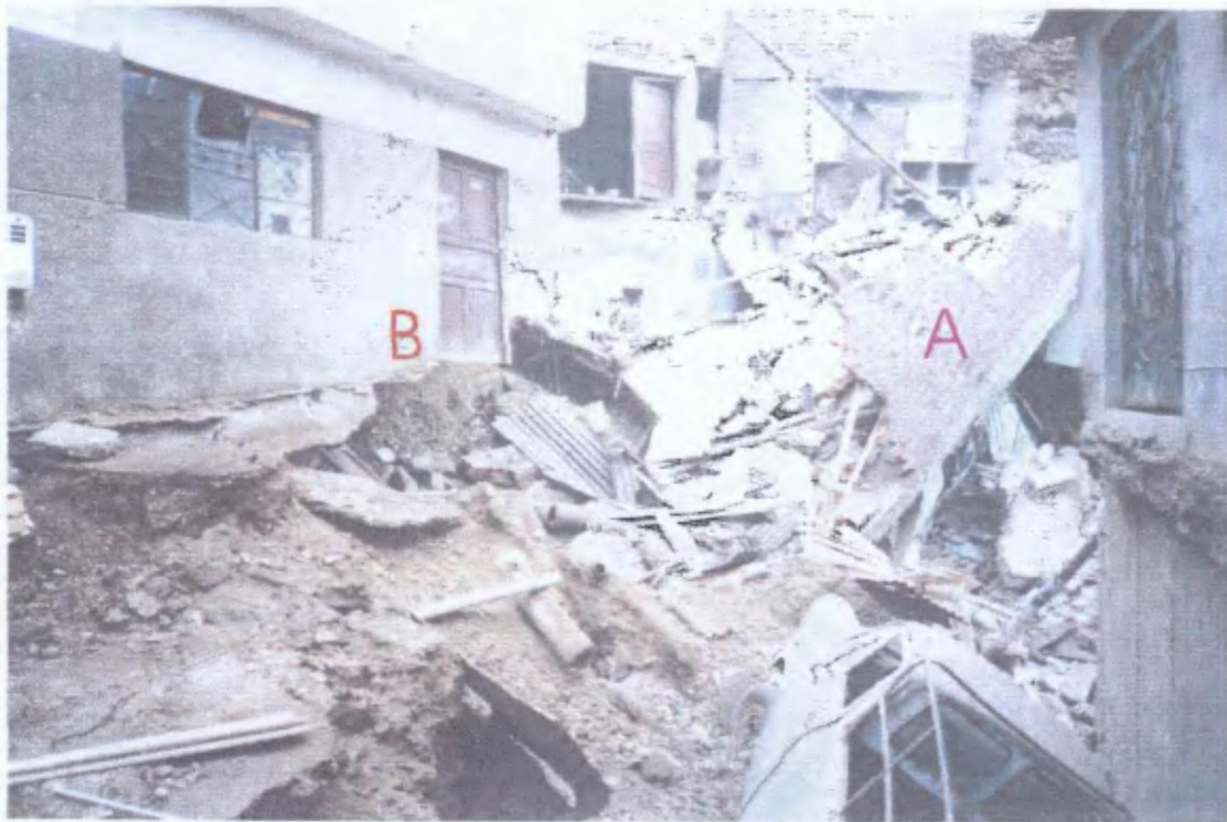
Foto N° 5: Vista donde se observa el desplome de las viviendas (A), y las estructuras que han quedado en el aire (B).
