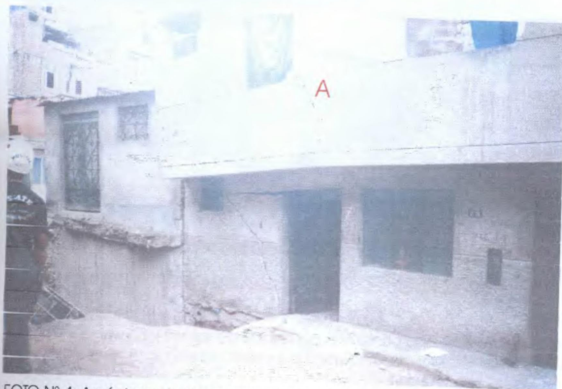
FOTO N° 4: Apréciase el estado actual de las viviendas, las cuales presentan agrietamiento en sus paredes (A) y pisos.
