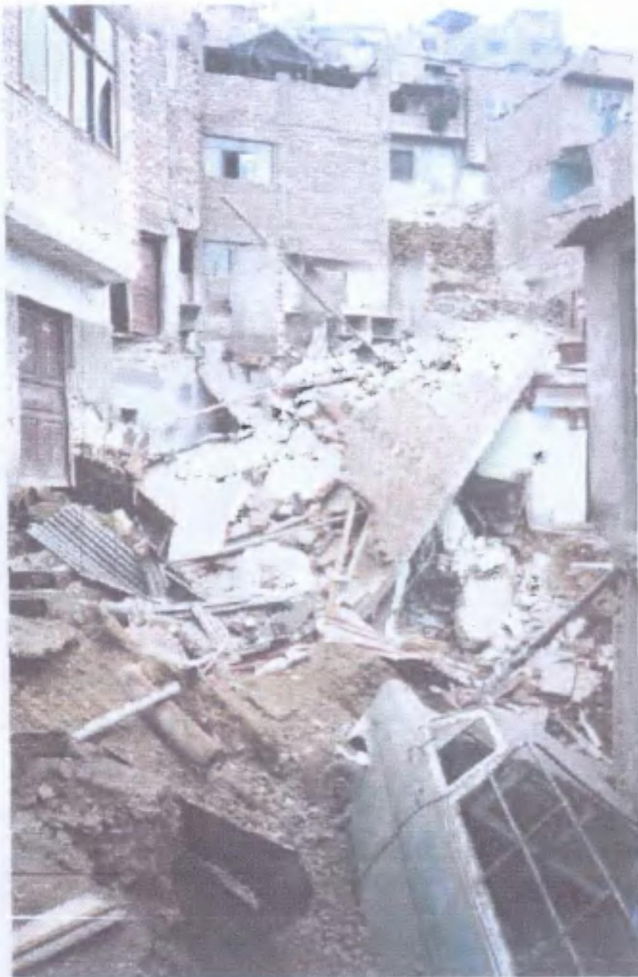
FOTO N° 1: Vista del Pasaje José Olaya en el A.A.H.H 9 de Octubre donde se produjo el hundimiento y el derrumbe de viviendas.
