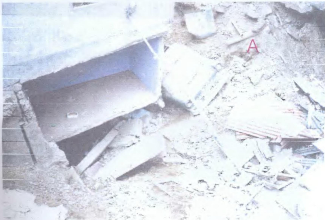
FOTO N° 2: Otra vista del hundimiento de la vivienda ubicada en el pasaje José Olaya Mz C - Lt 8, donde se aprecia los daños causados a las estructuras que conforman los sótanos de la vivienda. Apréciase el material de relleno (A).
