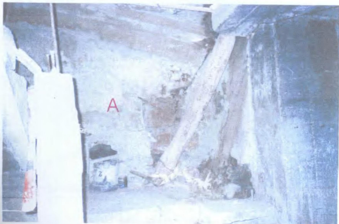
FOTO N°7 y 8: Ubicación de una de las entradas a las labores mineras antiguas (A) tapiadas con concreto dentro de la vivienda del pasaje José Olaya Mz B - Lt 11 y 12; obsérvese también el fracturamiento y la humedad en la roca (B).
