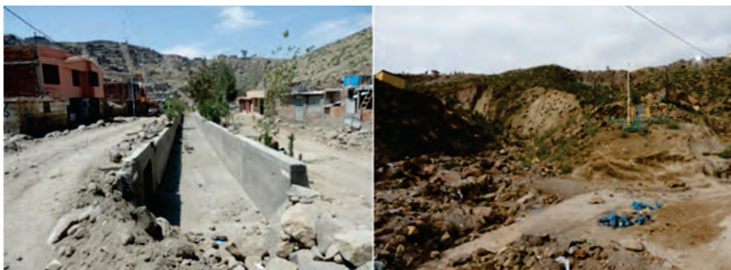
Figura 6.27 Cabecera de la torrentera Venezuela, presenta derrumbes, caída de rocas, erosión de laderas que en época de lluvias excepcionales como las del 08/02/2013 discurren huaicos por las laderas con material suelto, aportando material al cauce de la torrentera, además del mal diseño de obras, como se aprecia en la fotografía del lado izquierdo en el sector Mariano Bustamante, Villa Alto Cenepa; derrumbes y huaicos en el A. H. Villa El Triunfo.
