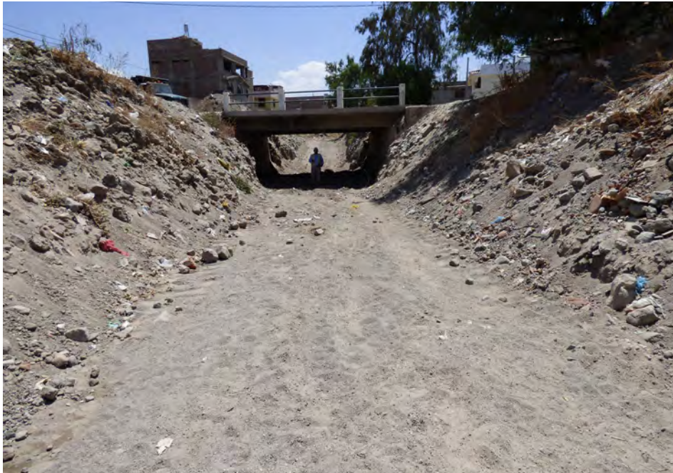
Fotografía 6.11 Vista aguas abajo de la quebrada Pozo Negro, también es posible distinguir la excavación realizada por debajo del puente vehicular.
