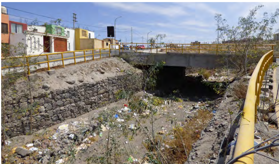
Fotografía 5.34 Vista hacia el sureste, se aprecia el cauce desviado y encauzado con muros de gaviones de un tributario de la quebrada Venezuela, en la urbanización Alameda de Salaverry, distrito Miraflores.
