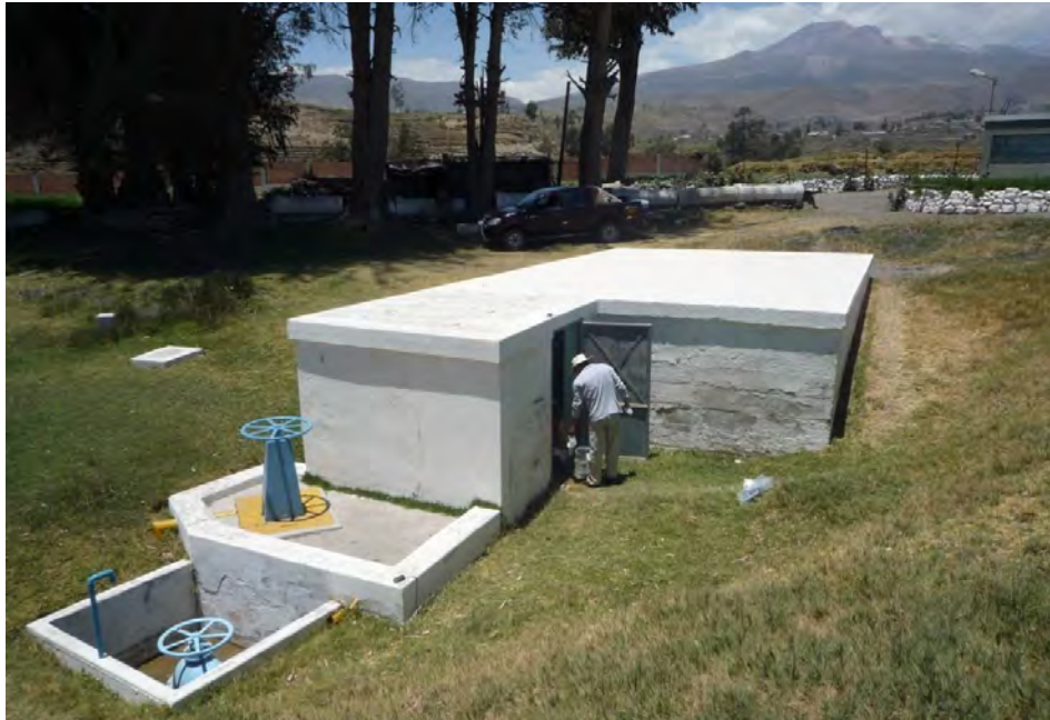
Fotografía 4.4 Manantial captado de la Bedoya en el distrito de Chiguata.
