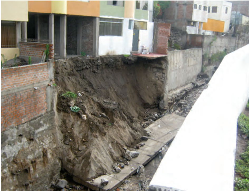
Fotografía 6.21 En la margen derecha de la quebrada San Lázaro, se aprecia una vivienda colapsada debido al incremento del caudal que ocasionan las lluvias excepcionales del 08/02/2013.
