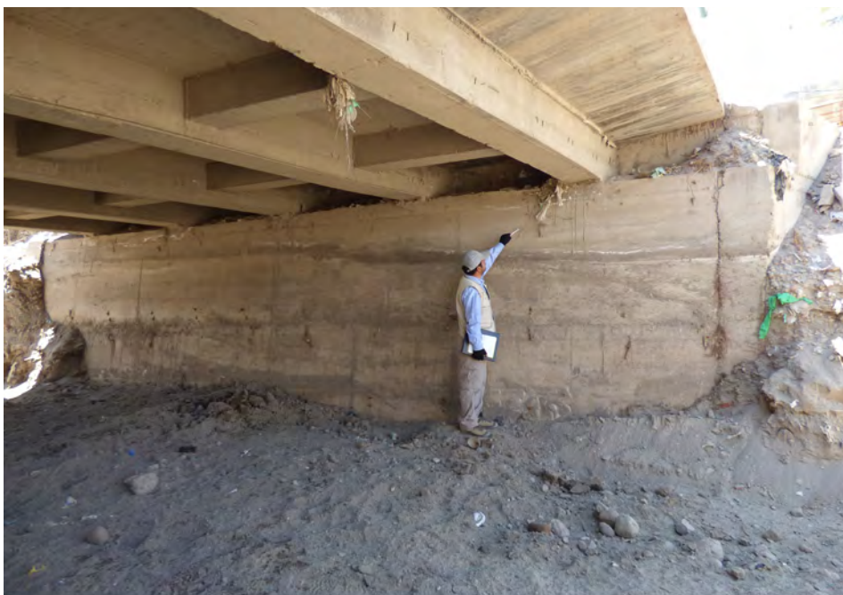
Fotografía 6.12 Vista donde se observa las marcas del agua en los estribos del puente, así como las bolsas de plástico y lodo que se acumula debajo de su estructura, los cuales marcan el nivel de carga que alcanza la quebrada por los flujos de lodo y agua que discurren por la quebrada.
