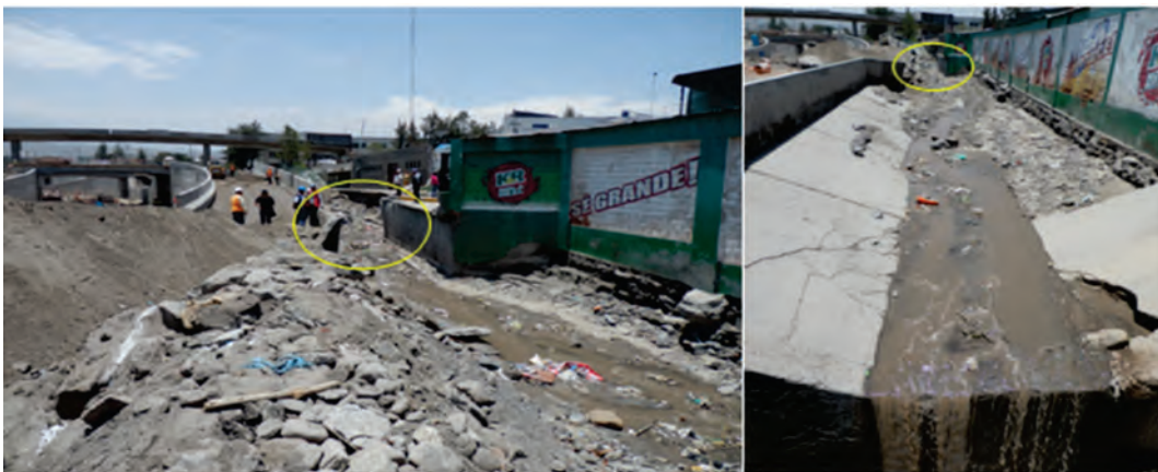
Figura 6.32 Vistas del estrangulamiento del cauce de la torrentera Venezuela, afectado por inundaciones de lodo; el depósito de flujo de lodo alcanzó hasta 1 m de altura.
