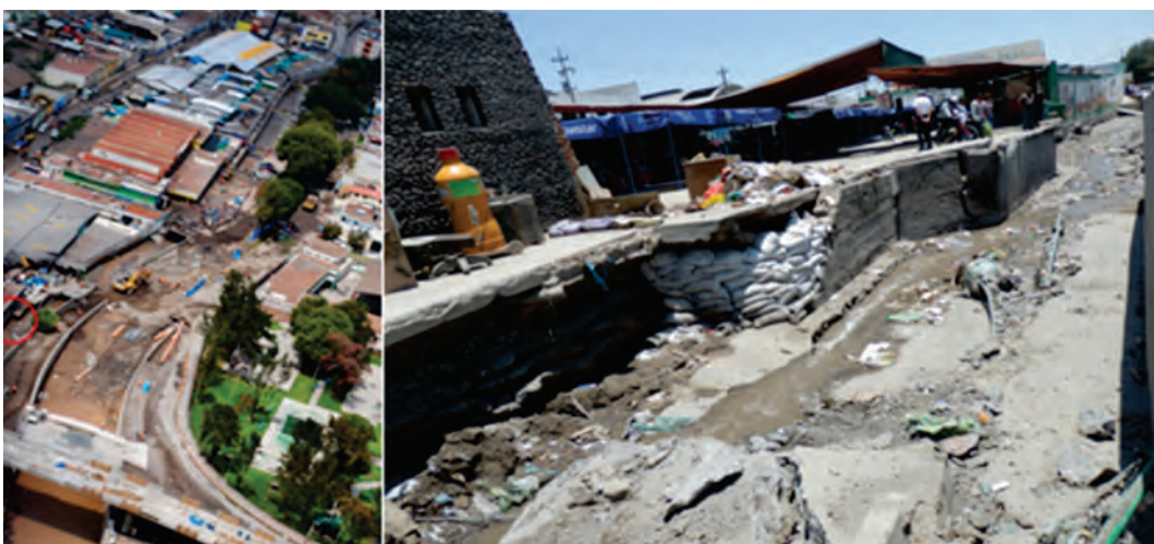
Figura 6.33 En la izquierda, vista aérea del sector del Terminal Pesquero, se observa la reducción del cauce en forma escalonada de 6 a 3 m de ancho. En la derecha, ampliación de la vista, se puede observar la erosión en la margen izquierda de la torrentera Venezuela.
