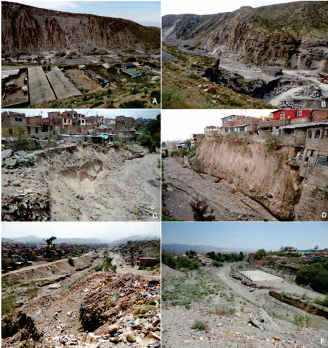
Figura 6.35 a) erosión en cárcavas y derrumbes en ambas márgenes de la quebrada San Lázaro (parte alta), aportan material suelto al cauce de la quebrada; b) presencia de canteras en el cauce de la quebrada San Lázaro, acumulan material suelto; c y d) viviendas ubicadas en el borde del acantilado, formado en la quebrada San Lázaro, algunas ya han colapsado; e) desmonte y basura acumulada en la parte alta de la quebrada San Lázaro; f) plataforma deportiva en terraza baja de la quebrada San Lázaro.
