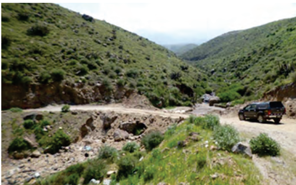
Fotografía 6.4 Alcantarilla destruida por flujos que discurren por la quebrada Pastoras. Vista con dirección al noreste.
