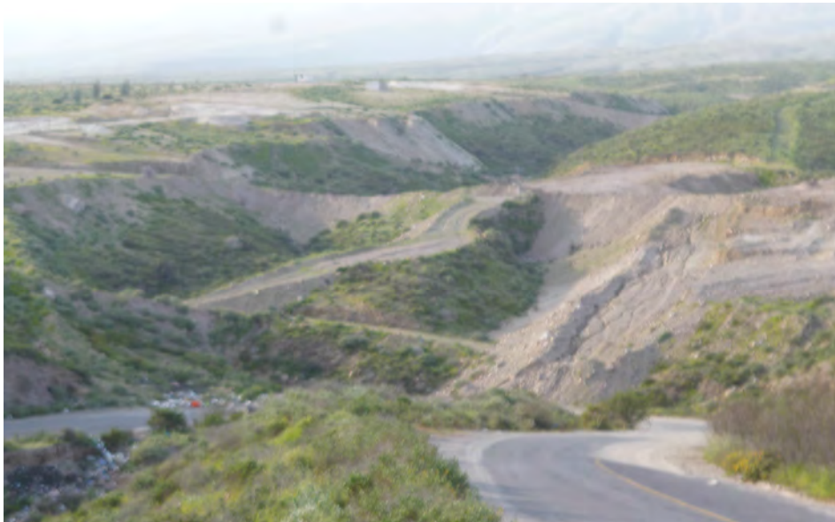
Fotografía 6.3 Vista donde se puede observar la obstrucción de dos cauces de quebradas con el material colocado como terraplén para habilitar vías de acceso hacia la urbanización Villa Real. Vista hacia el noreste.
