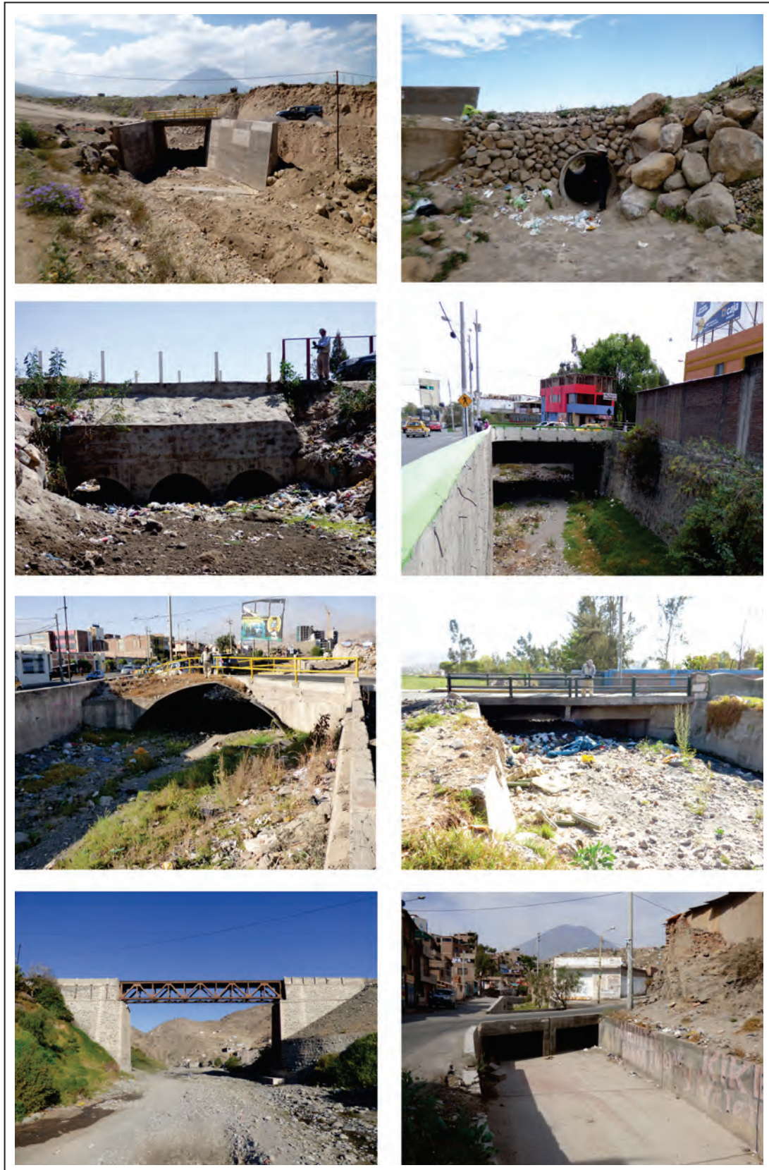
Figura 8.32 Vista de puentes, pontones y alcantarillas de la ciudad de Arequipa, cuyos diseños condicionan desbordes de agua o flujos de lodos/detrítos, ya que estrechan los cauces de ríos y quebradas o porque favorecen la retención de restos de plantas (troncos de árboles), basura y material arrastrado de gran dimensión (bolos, bloques y gravas).
