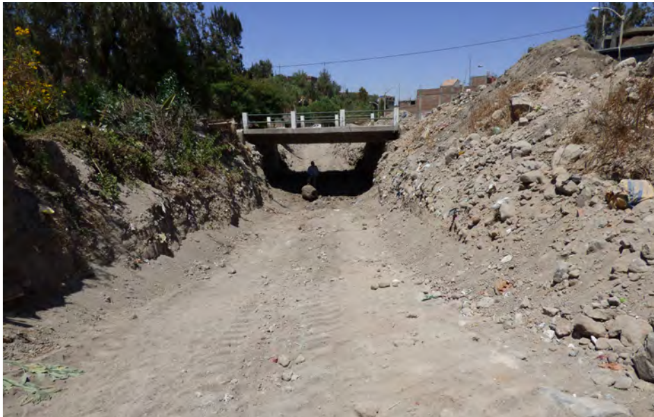
Fotografía 6.10 Vista aguas arriba de la quebrada Pozo Negro, donde se observa la excavación realizada por debajo del puente vehicular.
