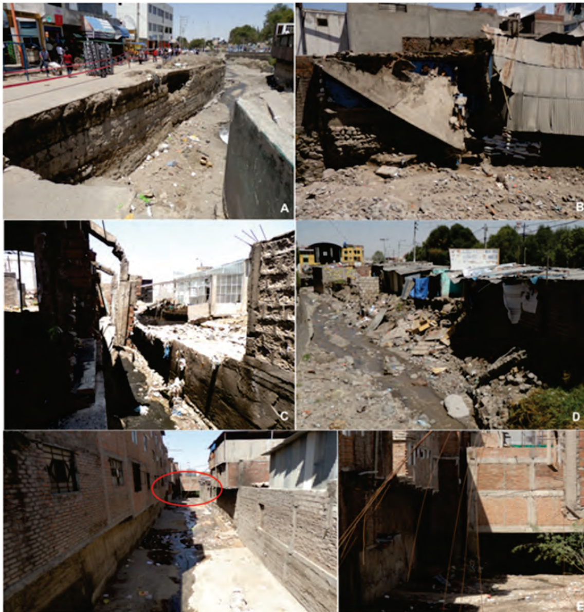
Figura 6.30 a) colapso de muros de contención en la margen izquierda de torrentera, con pérdida de plataforma de la calle Virgen del Pilar, descubriendo un muro antiguo a más de 1 m detrás del actual con 17 m de ancho; b) colapso de muros de los puestos del mercado del Altiplano; c) el cauce de la torrentera se ha estrechado a 4.54 m, por construcción de edificaciones, por efecto del flujo socavó los cimientos del muro de contención en la margen izquierda, generando el colapso de las columnas de la fábrica textil y rebose en ambas márgenes, en el pasaje Victoria; el puente en forma de arco a 11 m aguas abajo tiene un ancho de 3.78 m, el cual estranguló aún más la torrentera; d) en la intersección de la Av. Venezuela con el pasaje Jacinto Ibáñez, en la margen derecha de la torrentera, frente a la urbanización Juan El Bueno, se encuentran ubicadas 6 viviendas, que han invadido el cauce natural de la torrentera; el 08 de febrero de 2015, se incrementó el caudal de la torrentera, se represó el cauce a la altura del puente Vidaurrazaga (letrero de centro comercial), al desfogar erosionó 93 m en su margen derecha; e) cauce de torrentera, invadido por edificaciones.
