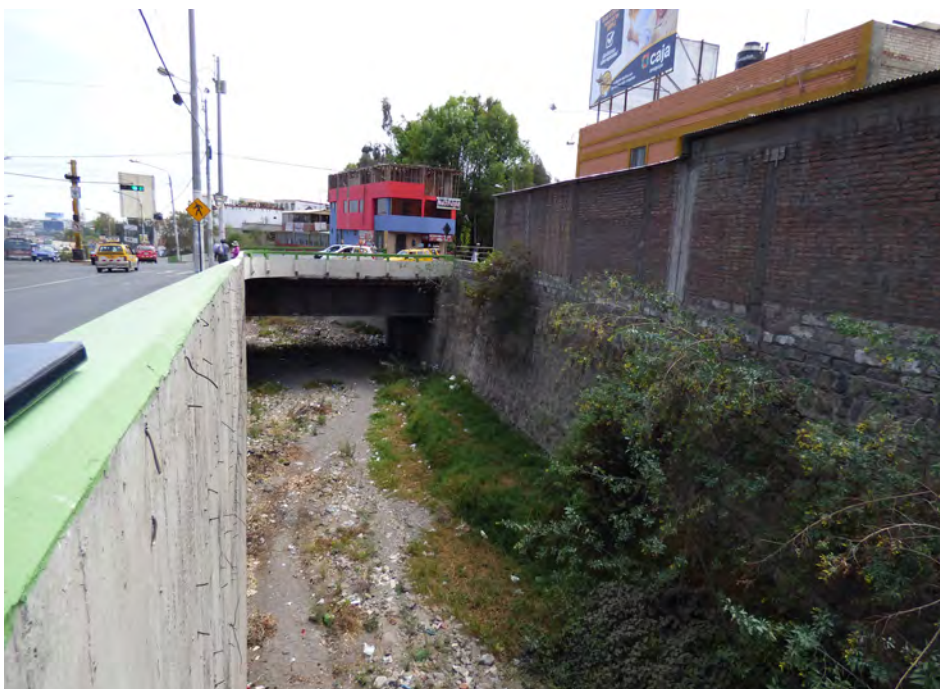
Fotografía 6.8 Quebrada San Lázaro, cuyo cauce está obstruido con un puente vehicular.
