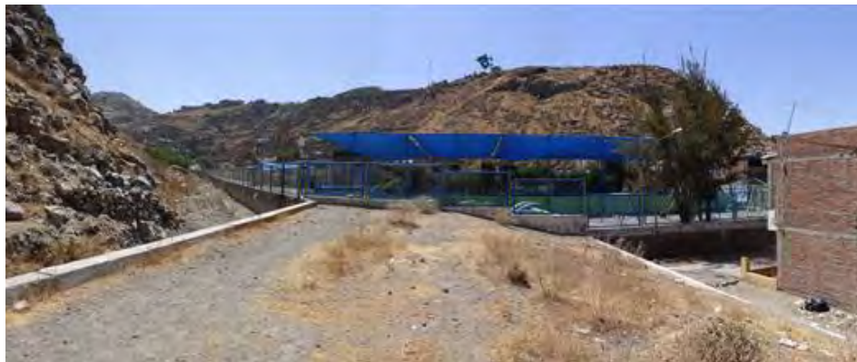
Fotografía 6.14 Vista agua arriba de quebrada seca en la calle Capitán Novoa, donde se puede apreciar la ubicación del muro de concreto, el relleno y la calle (lado derecho de la fotografía). Vista con dirección hacia el sureste.
