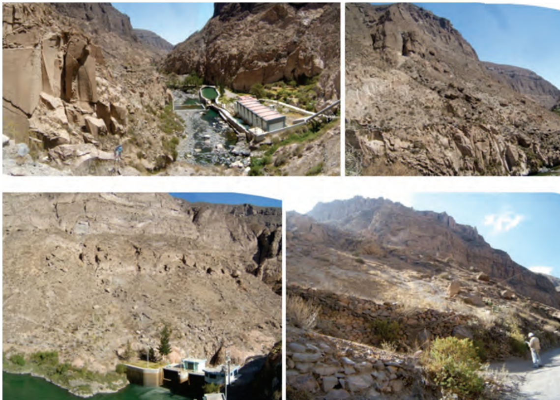
Figura 6.36 Laderas y taludes propensos a caída de rocas y derrumbes en el cañón del río Chili (ambas márgenes) que obstaculizarían el tránsito y afectan las centrales hidroeléctricas en Charcani. (fotografía: Zavala, 2012).
