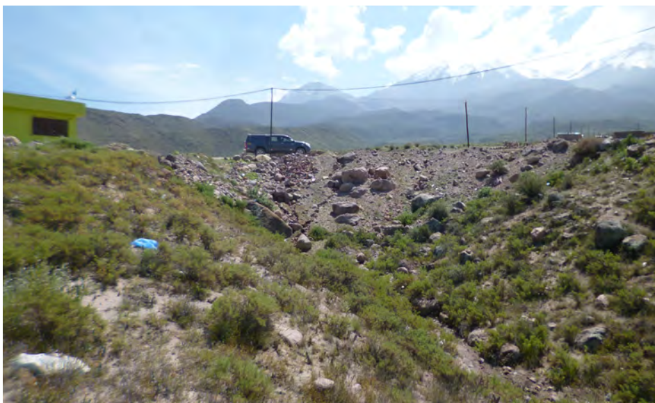
Fotografía 5.32 Vista con dirección hacia el norte, donde se puede observar el cauce de una quebrada seca obstruida con un dique de tierra, localizado en las nuevas zonas expansión urbana del distrito Cayma.
