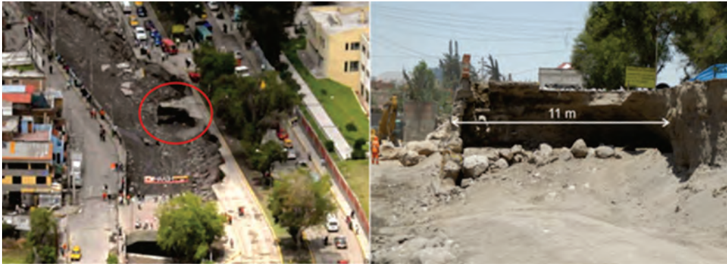
Figura 6.31 Erosión de la vía izquierda de la Av. Venezuela hasta la berma central; por la margen derecha de la torrentera Venezuela afectó aproximadamente 135 m de longitud. El canal se había reducido a un ancho de 11 m.
