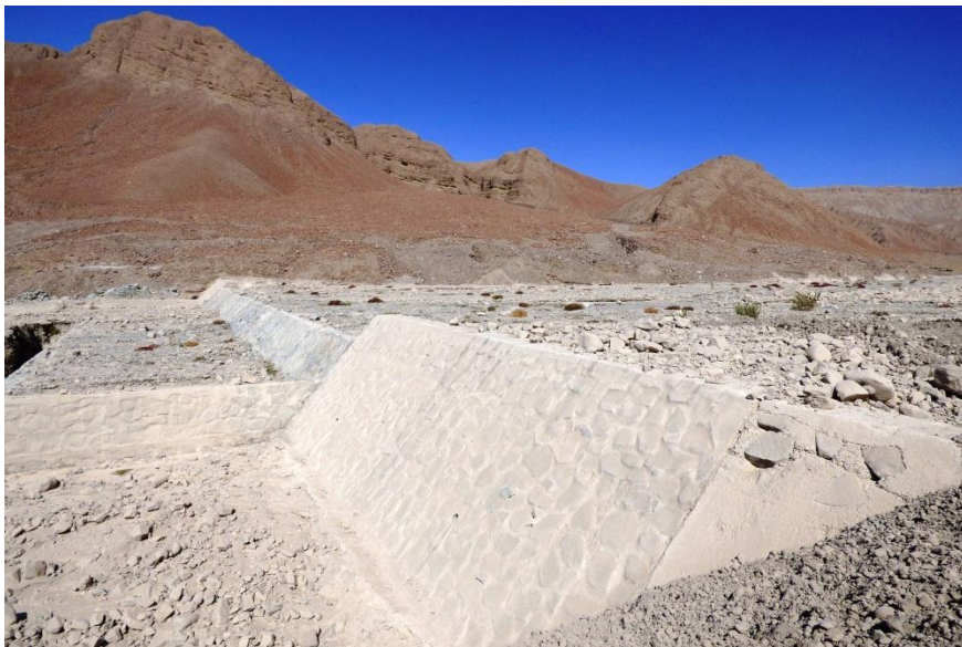
Foto 14. Dique transversal relleno por depósitos de flujos de detritos.
