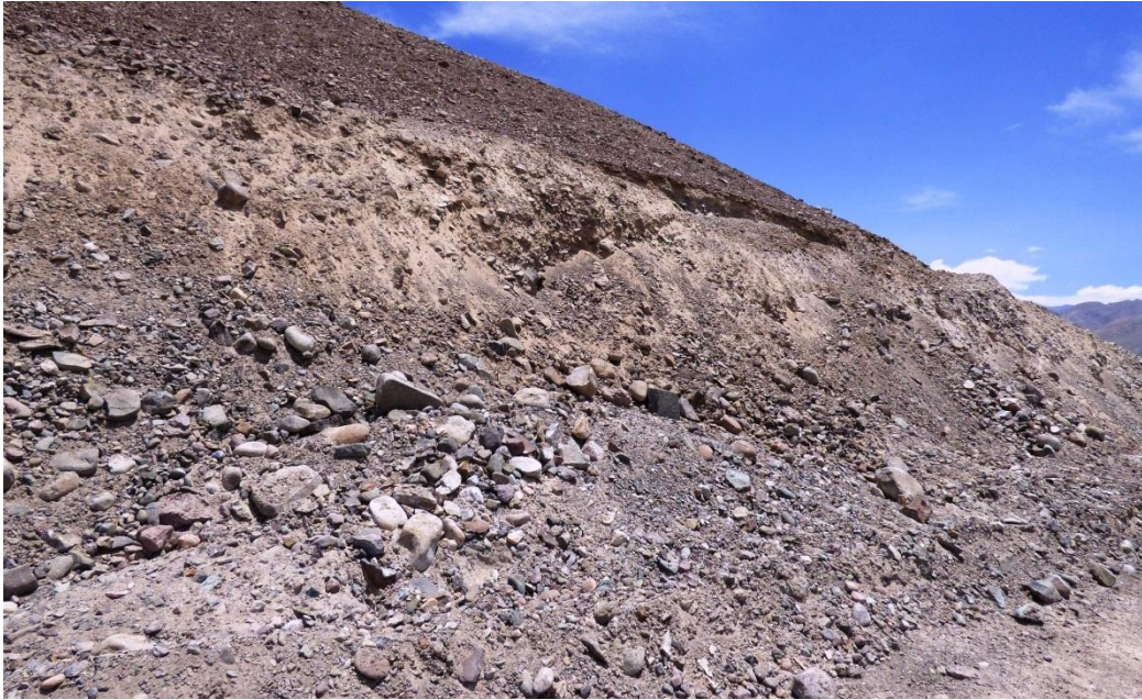
Foto 3. Conglomerados de la Formación Moquegua ubicado en corte de talud realizado en Sector Alto Mirave. Se observa clastos redondeados a subredondeados, soportados en una matriz arenolimososa.
