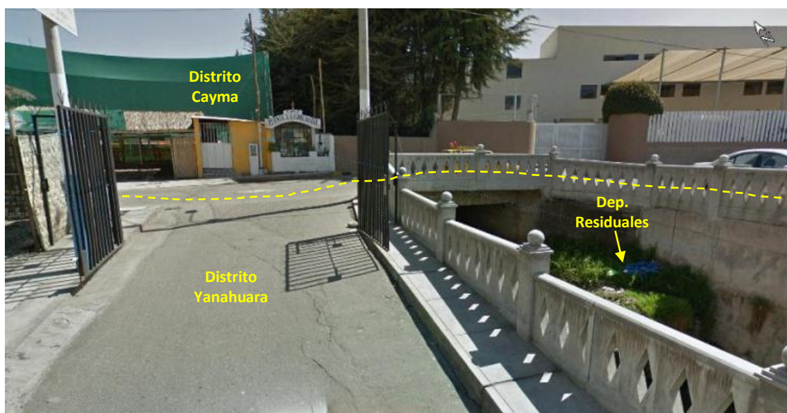
Figura 43. Quebrada Chullo al límite del distrito de Cayma y Yanahuara observándose material residual y muros de concreto.
