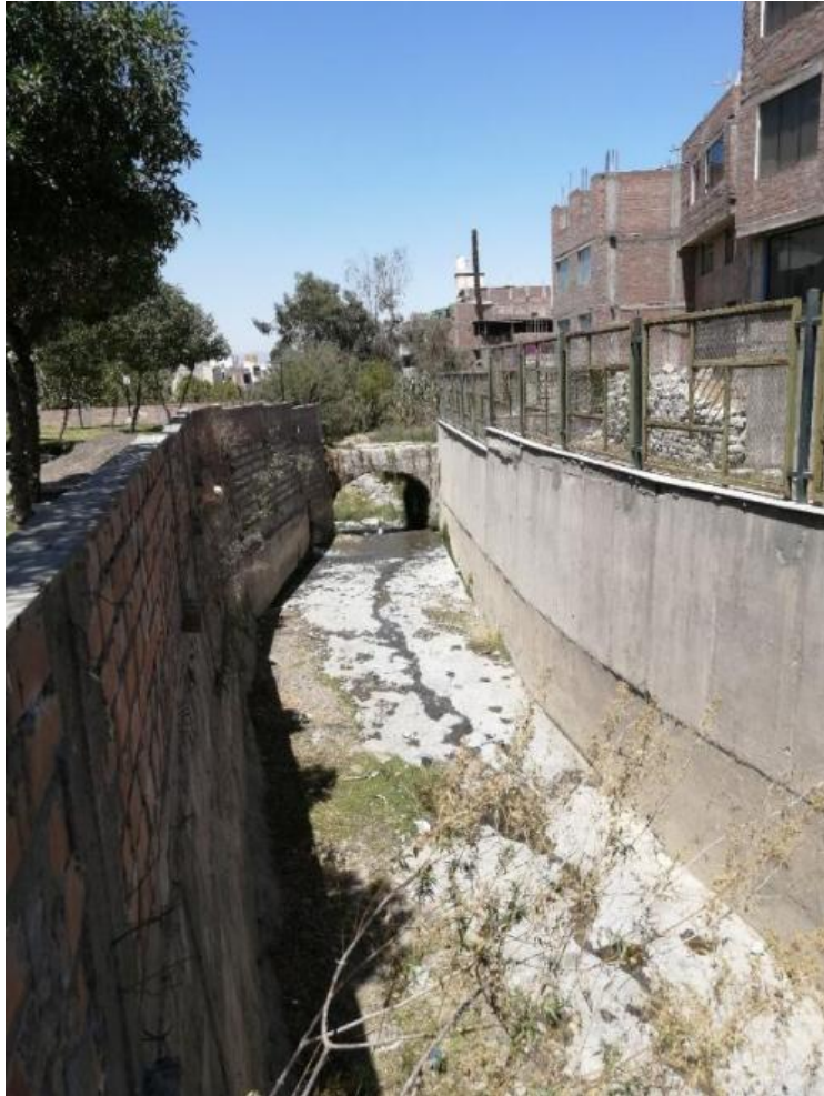
Figura 59. Puente en el sector alto de la quebrada Chullo (Coordenadas UTM WGS84 227127 E, 8187569 N).
