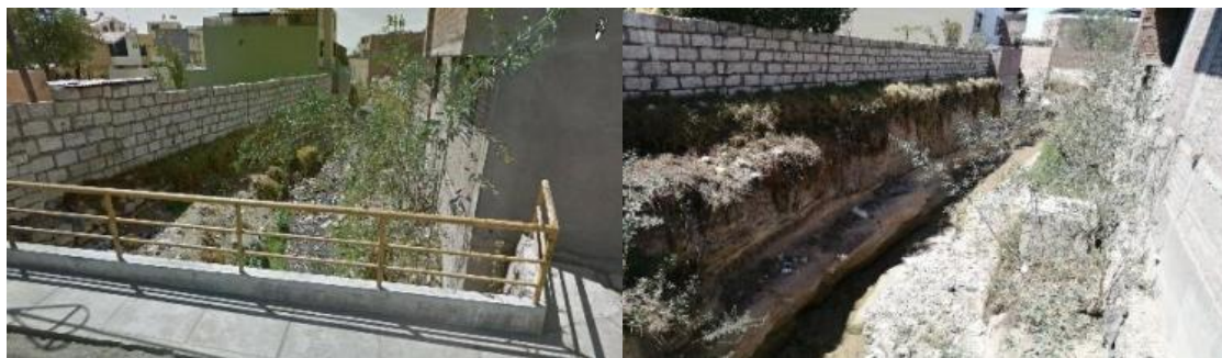
Figura 41. Quebrada Chullo año 2014 (izquierda) y año 2021 (derecha), se observa que el cauce de la quebrada ha erosionado la ladera y socavando el curso del mismo (Coordenadas UTM WGS84 227322 E, 8187219 N).
