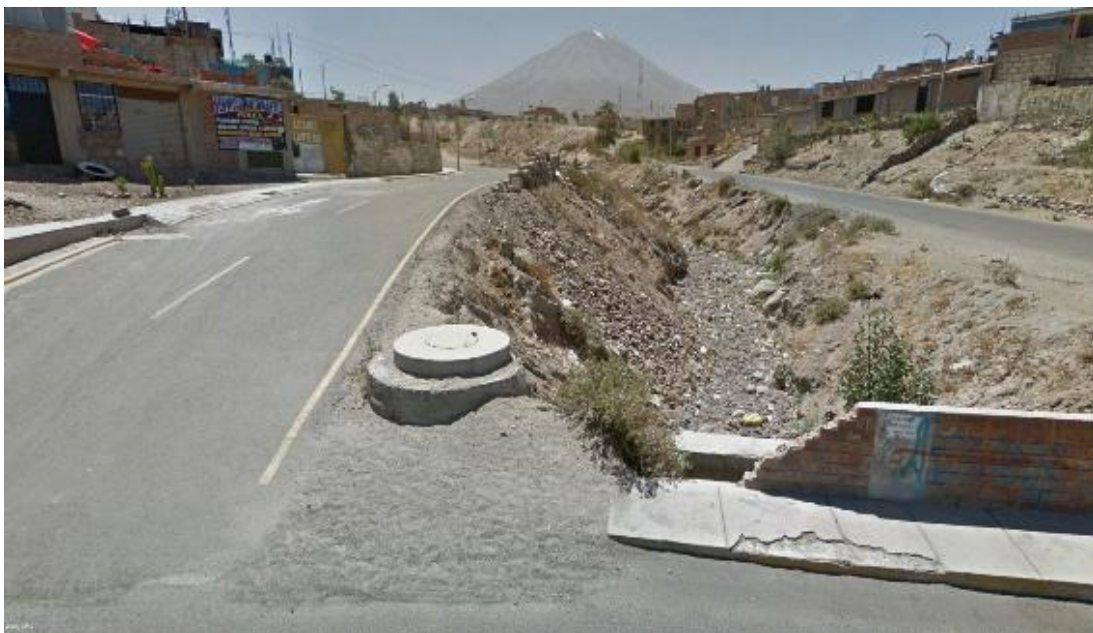
Figura 51. Muros de menos de 1 metro, quebrada Pastoraíz.
