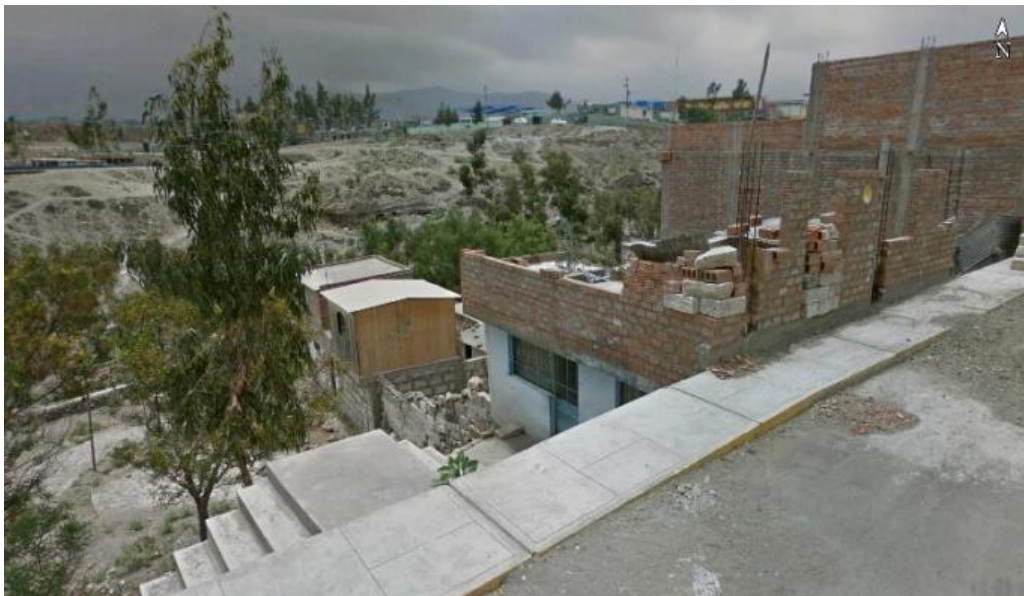
Figura 21. Viviendas de ladrillos y material prefabricado en la quebrada Tributaria.
