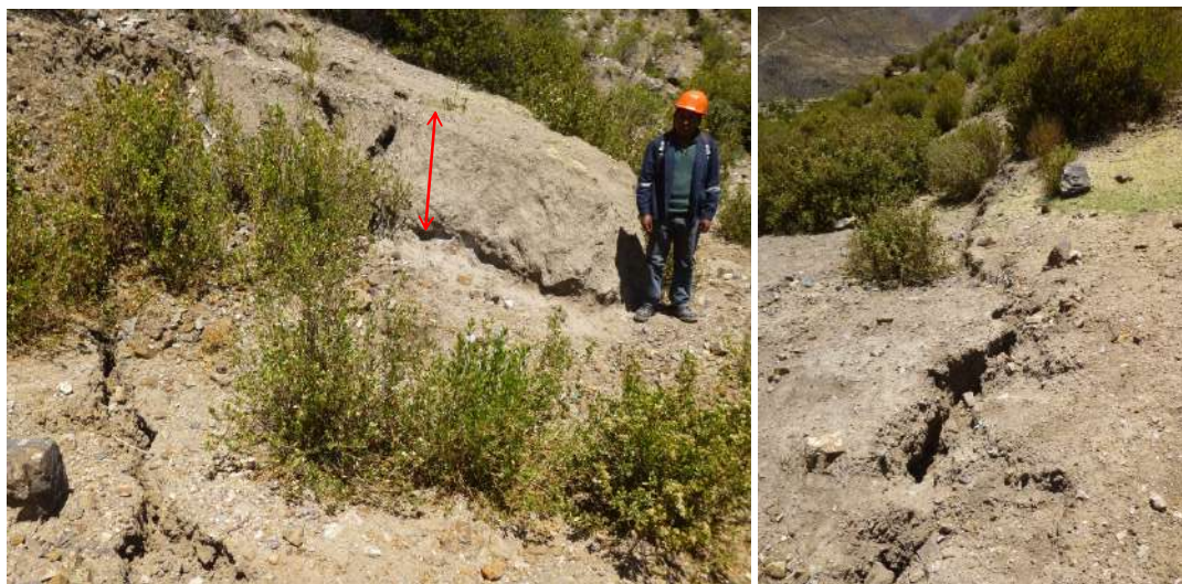
Foto 2.5. Vista de asentamientos y grietas transversales en la parte alta de la comunidad de Tassa.
