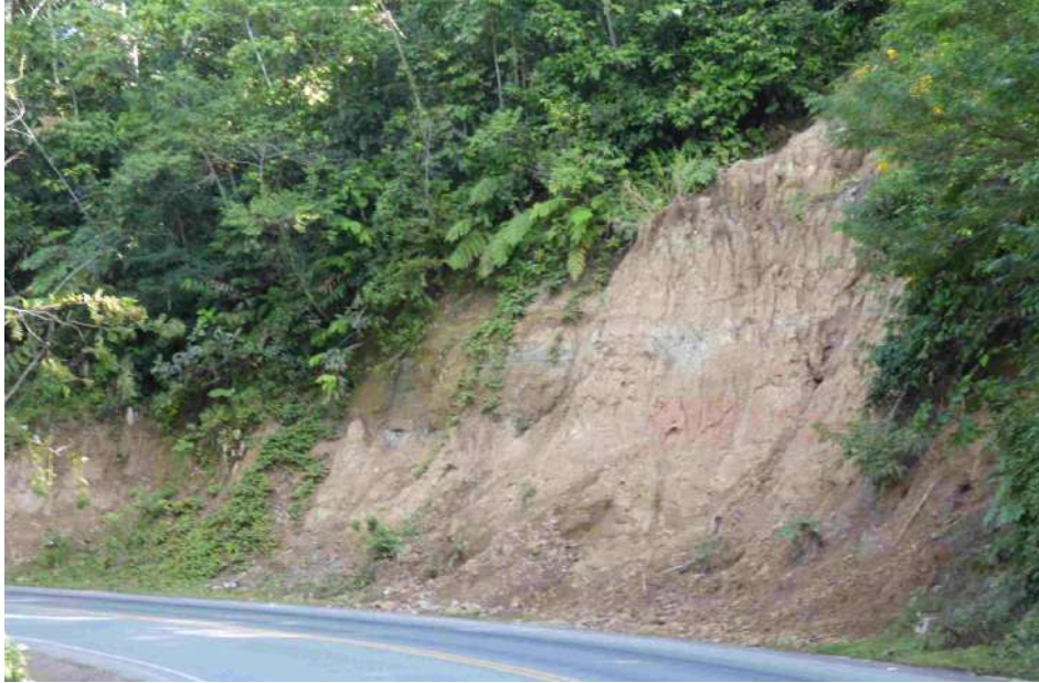
Fotografía 6.4 Derrumbe, tramo de carretera Mazuco km 287+830, distrito Inambari (coordenadas 8569926 N – 358375 E)
