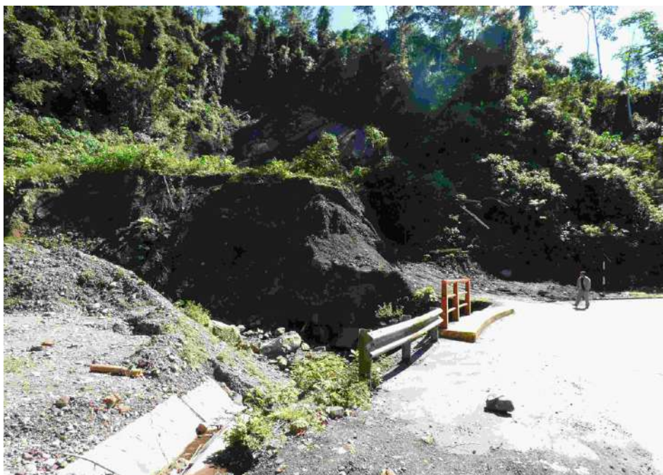
Fotografía 6.8 Deslizamiento traslacional ubicado en la margen izquierda de la quebrada. La masa se desliza con una dirección norte 167^\circ , afectando plataforma de carretera y estructura del pontón (coordenadas UTM: 8541845 N – 349677 E).
