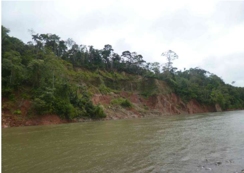
Fotografía 6.9 Erosión fluvial, margen izquierda del río Madre de Dios, afecta secuencias de capas rojas limoarenosas. (coordenadas UTM: 8582445 N – 241110 E)
