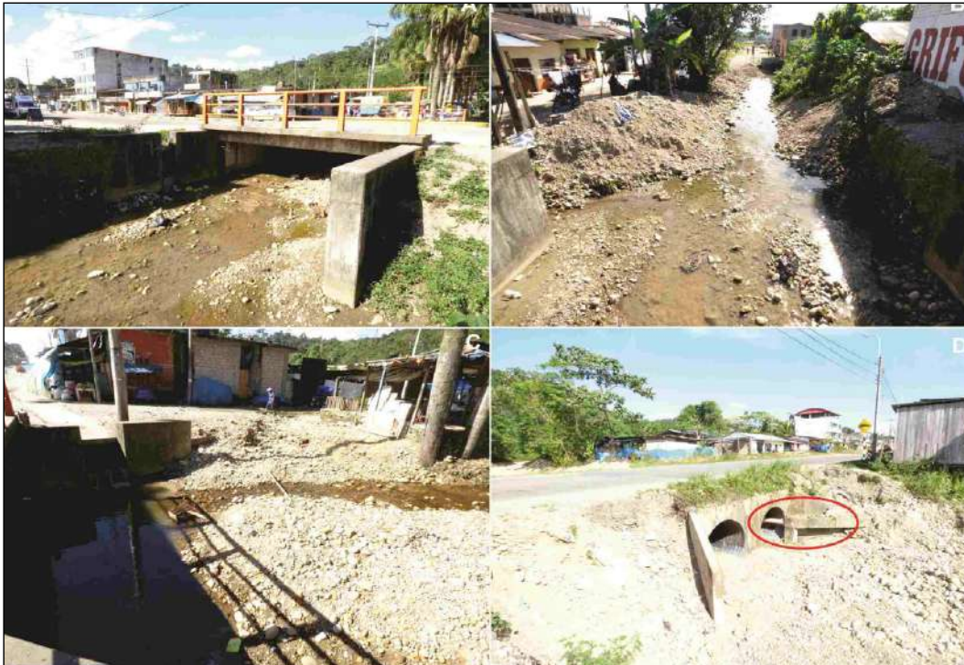
Figura 7.17 Tramo de carretera Interoceánica es cortado por quebradas por las que discurren huacos a consecuencia de lluvias intensas. En enero del 2014 se desbordó y afectó viviendas que se encuentran en ambas márgenes del Jr. Masuko del poblado de mismo nombre. Los colectores de drenaje pluvial también desembocan en estas quebradas (A, B y C). En el km 261+863 se ha colocado dos alcantarillas por donde pasa la tubería de agua potable, marcado por el círculo de color rojo (D).
