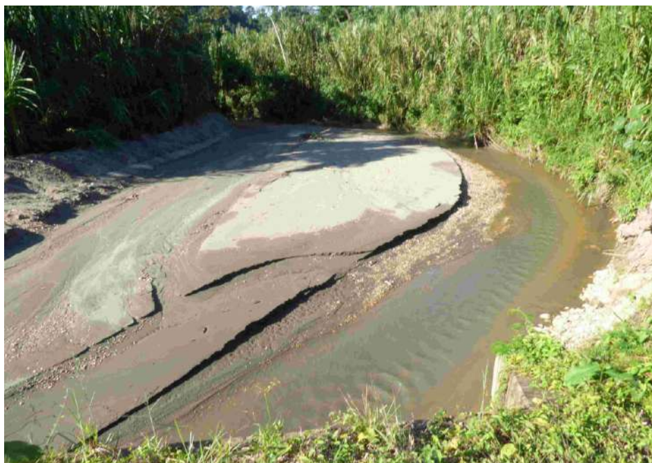
Fotografía 6.7 Flujo de lodo, kilómetro 2.75+100 de la carretera Mazuco-Tambopata (coordenadas UTM: 8564078 N – 353979 E)
