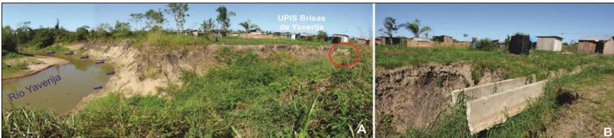
Figura 7.20 A) Erosión fluvial en la margen izquierda del río Yaverija. Aquí se encuentra asentado la UPIS Brisas de Yaverija. En enero del 2014 incrementó el caudal del río, se desbordó hasta la Av. José Olaya (80 m) y afectó aproximadamente 30 viviendas. La zona también es afectada por cárcavas debido a la intensa erosión originada por la evacuación de un colector de drenaje pluvial mal diseñado identificado con el círculo de color rojo. B) Vista más cercana del colector de drenaje pluvial.
