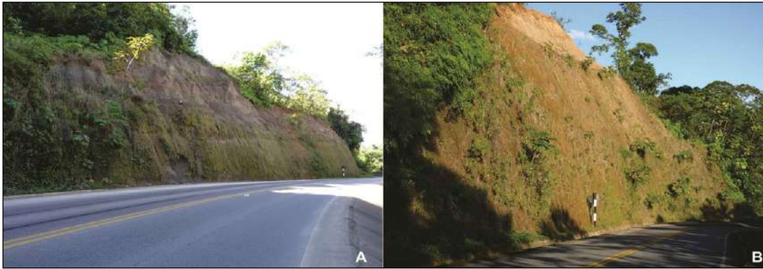
Figura 7.16 Derrumbes en los km 287+830 de 80 m de longitud y 15 m de alto (A), km 277+000 con presencia de filtraciones en talud superior de la carretera interoceánica, sector Santa Rosa (B)
