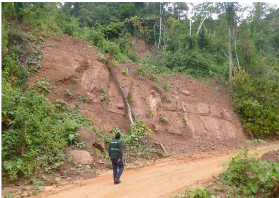
Fotografía 6.3 Derrumbe de talud superior carretera Shintuyo-Santa Rosa km 8+00, distrito Manu (coordenadas UTM 8596434 N – 255511 E)
