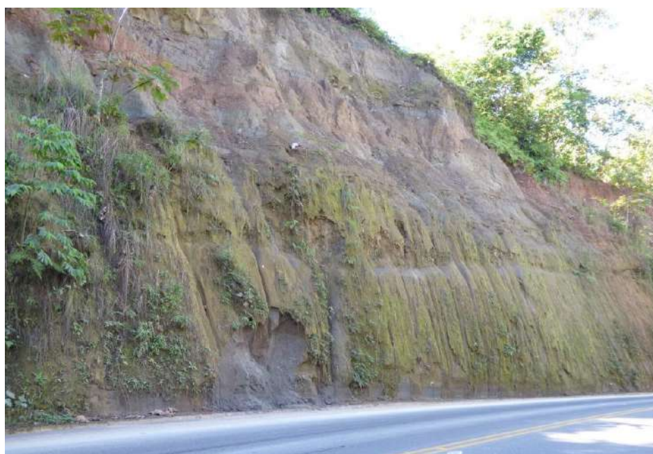
Fotografía 3.5 Imagen tomada con dirección norte. Se observa niveles de lutitas, lodolitas y limoarcillitas de la Formación Ipururo, en el sector Santa Rosa, km 287+800 de la carretera Interoceánica Masuco-Santa Rosa. El depósito inconsolidado obstruye las cunetas.
