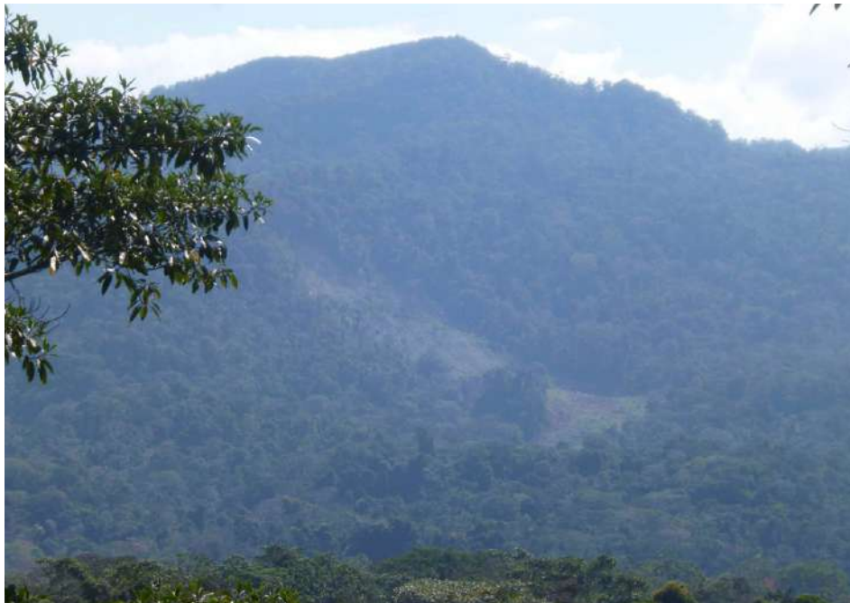
Fotografía 6.1 Derrumbe margen izquierda de la quebrada Olivetti, distrito Manu (coordenadas UTM 8580950 N – 239350 E)
