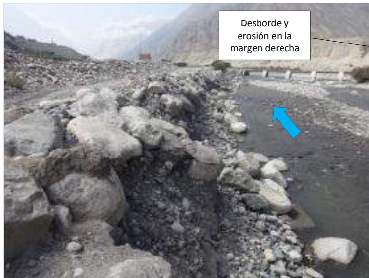
Figura 26. Punto crítico 30, sector Bocatoma Irrigación Pativilca
