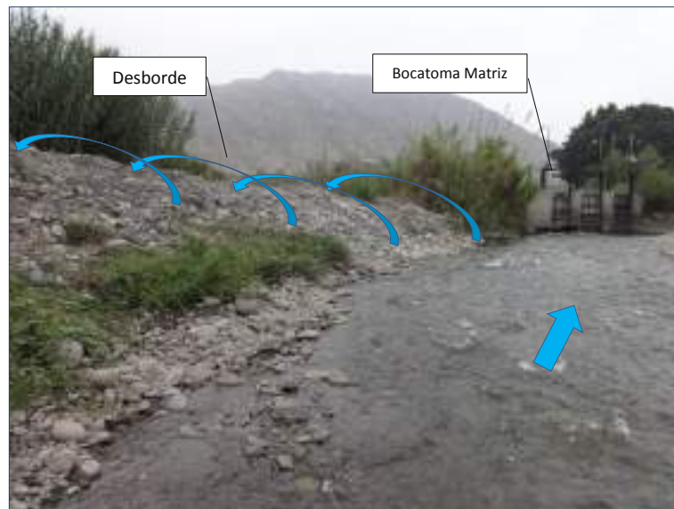
Figura 17. Punto crítico 18, sector Roncador
