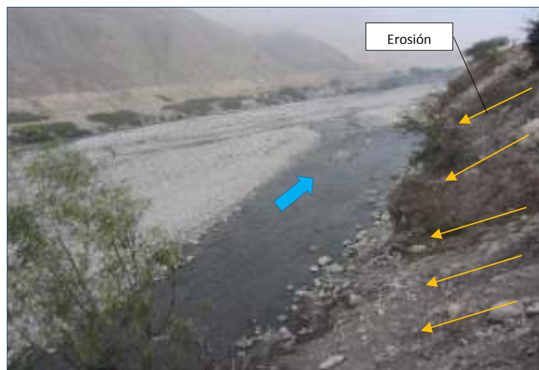
Figura 25. Punto crítico 28 y 29, sector Alpas
