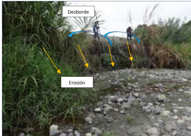
Figura 11. Punto crítico 12, sector Monte Arguy
