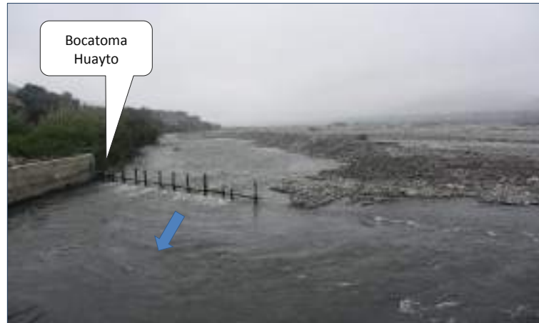
Figura 10. Punto crítico 10 y 11, sector bocatoma Huayto
