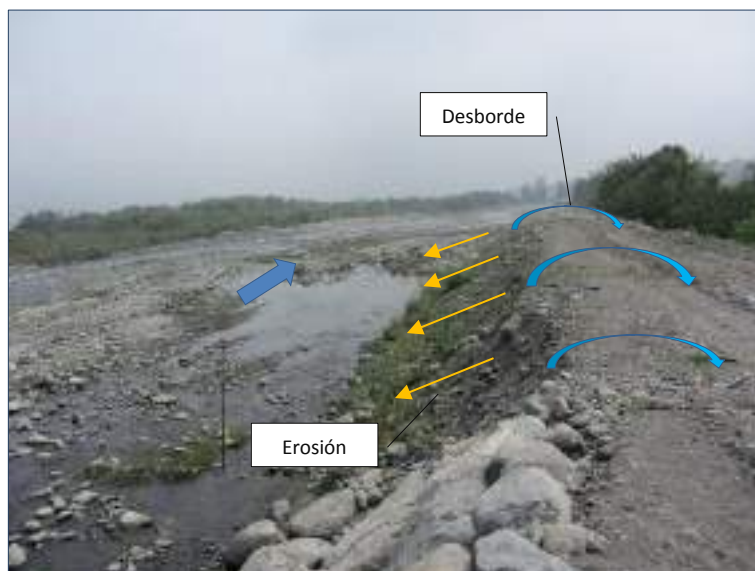
Figura 9. Punto crítico 09, sector Bocatoma Paramonga
