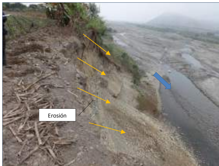
Figura 7. Punto crítico 07, sector Carretería
