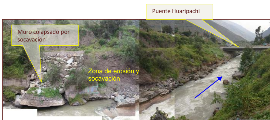
Figura 7. Riesgo a inundación y erosión de puente Huaripachi y Carretera central
