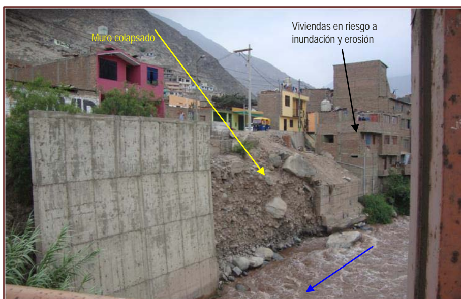
Figura 13. Viviendas en riesgo por inundación-erosión daños en muros de contención
