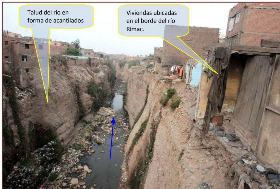
Figura 42. Viviendas en riesgo a erosión y colapso
