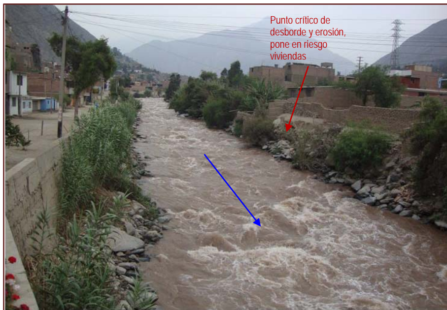
Figura 18. Margen izquierda en riesgo de erosión e inundación
