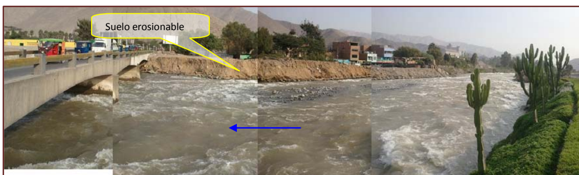
Figura 30. Viviendas y puente Ñaña en riesgo por erosión e inundación
