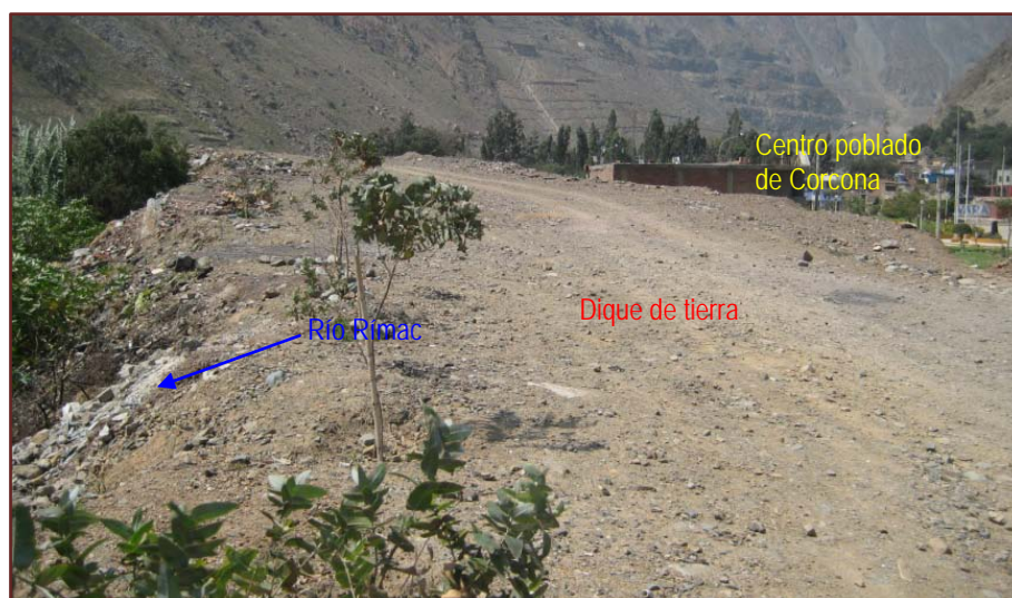
Figura 11. Riesgo de erosión de dique de tierra, que podría ocasionar daños a Corcona
