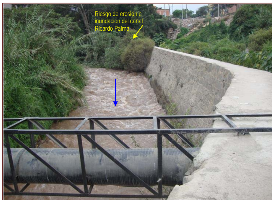
Figura 15. Canal Ricardo Palma en riesgo a inundación
