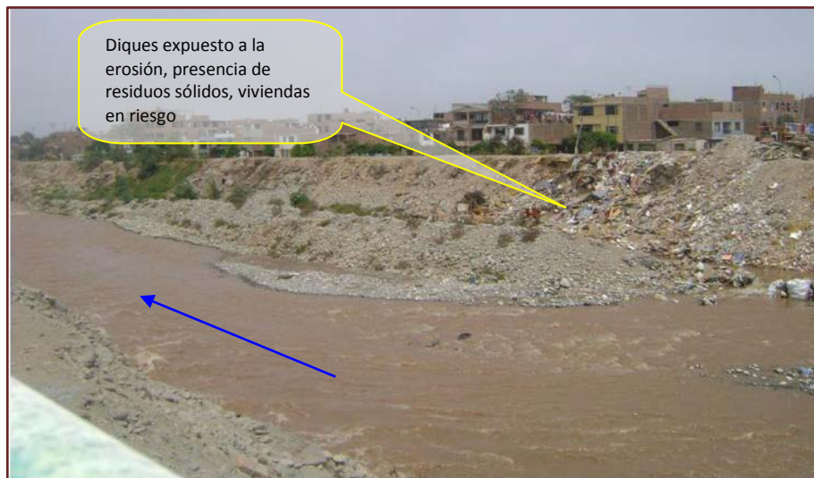
Figura 47. Diques de tierra sin revestimiento expuesto a la erosión
