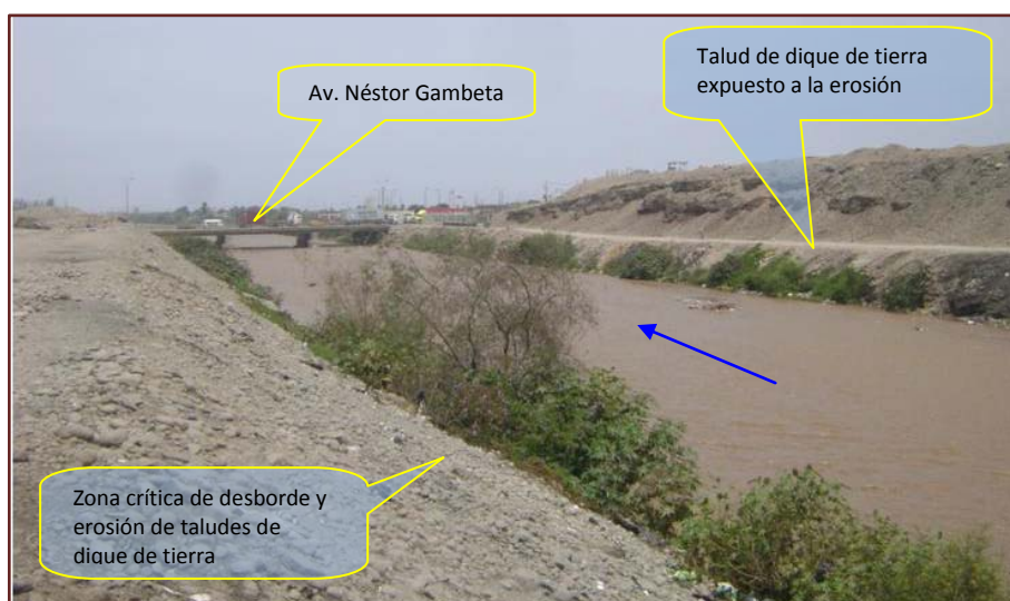
Figura 50. Punto crítico de inundación y erosión, zona Base Naval
