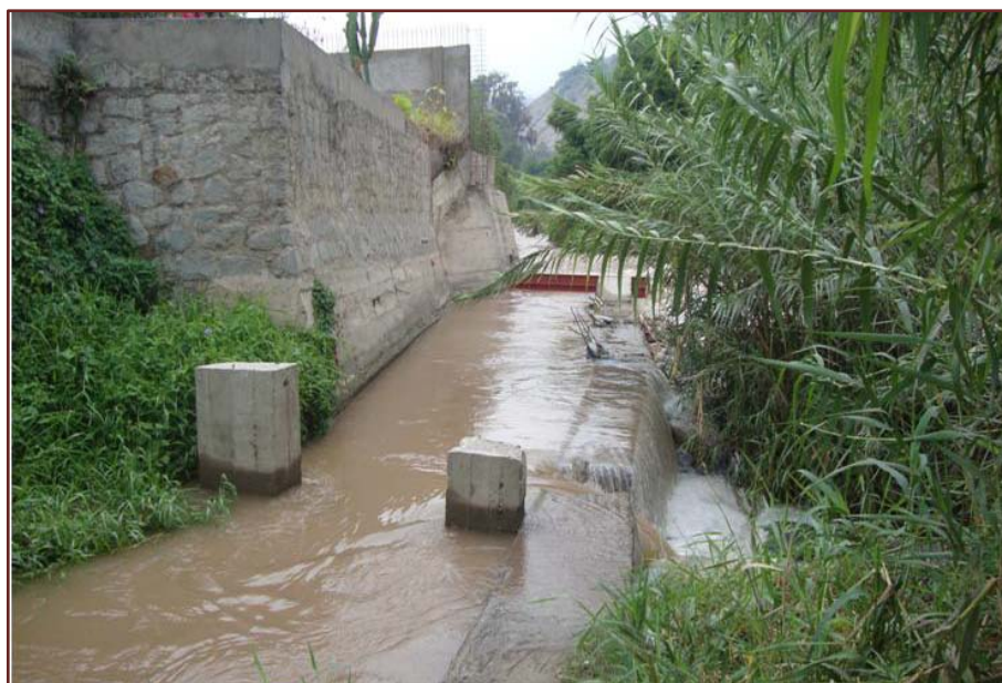
Figura 22. Riesgo por erosión e inundación de bocatoma y viviendas
