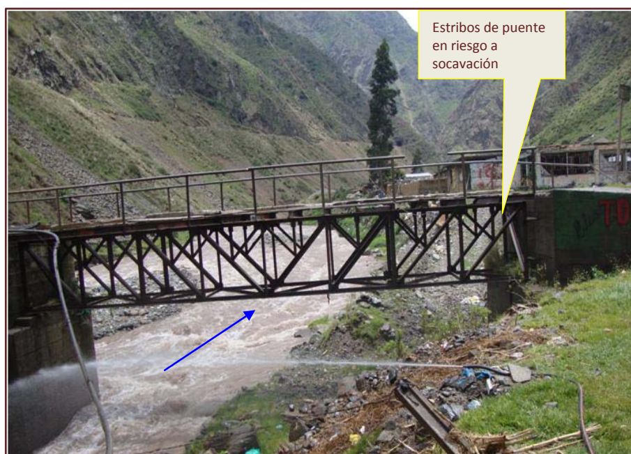
Figura 4. Estribos de puente en riesgo de socavación
