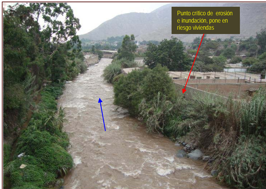
Figura 25. Riesgo de erosión e inundación de viviendas, aguas abajo del puente Los Ángeles
