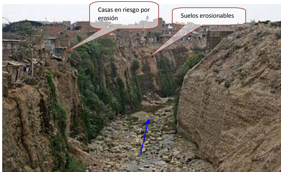
Figura 40. Viviendas en riesgo a erosión
