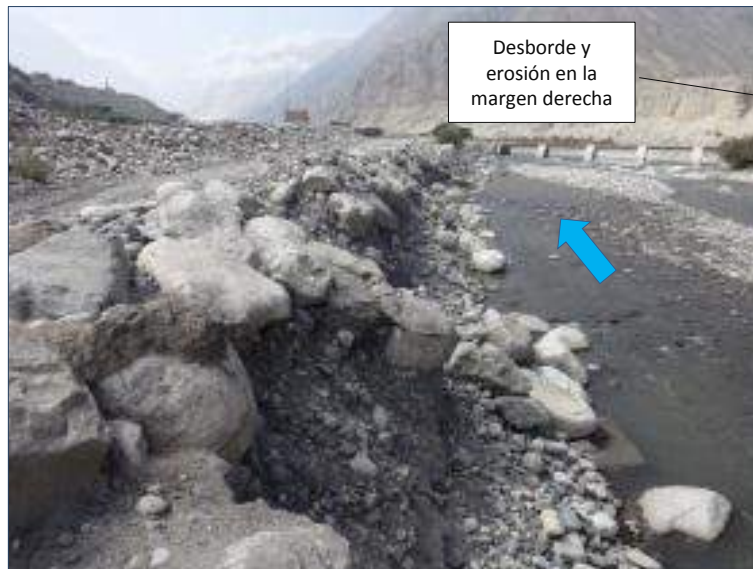
Figura 26. Punto crítico 30, sector Bocatoma Irrigación Pativilca
