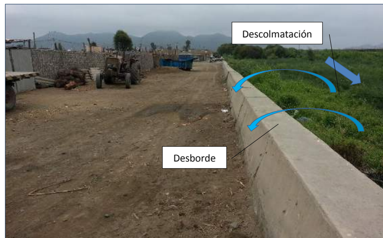
Figura 2. Punto crítico 02, riesgo de inundación en C.P. Simón Bolívar
