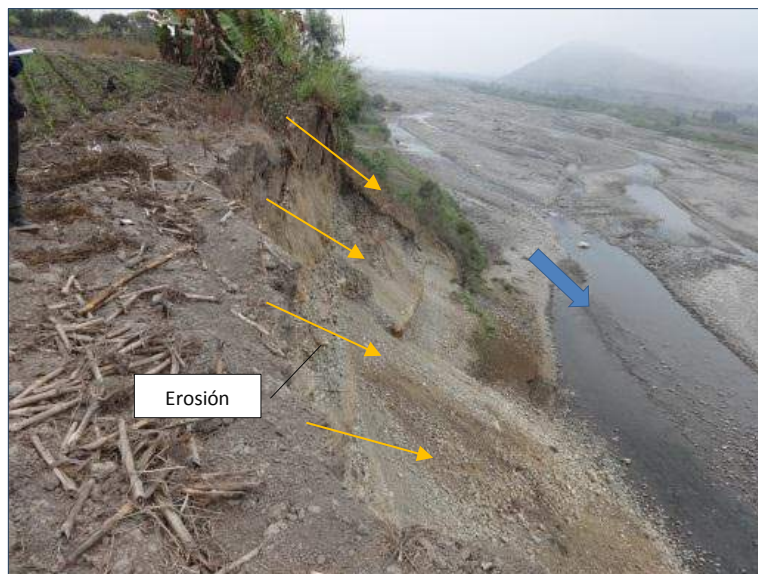
Figura 7. Punto crítico 07, sector Carretería
