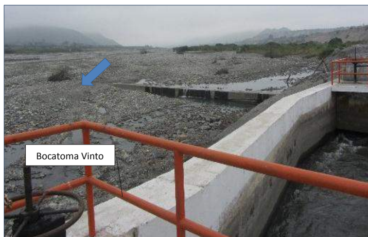
Figura 19. Punto crítico 20, sector Vinto
