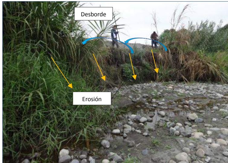
Figura 11. Punto crítico 12, sector Monte Arguy
