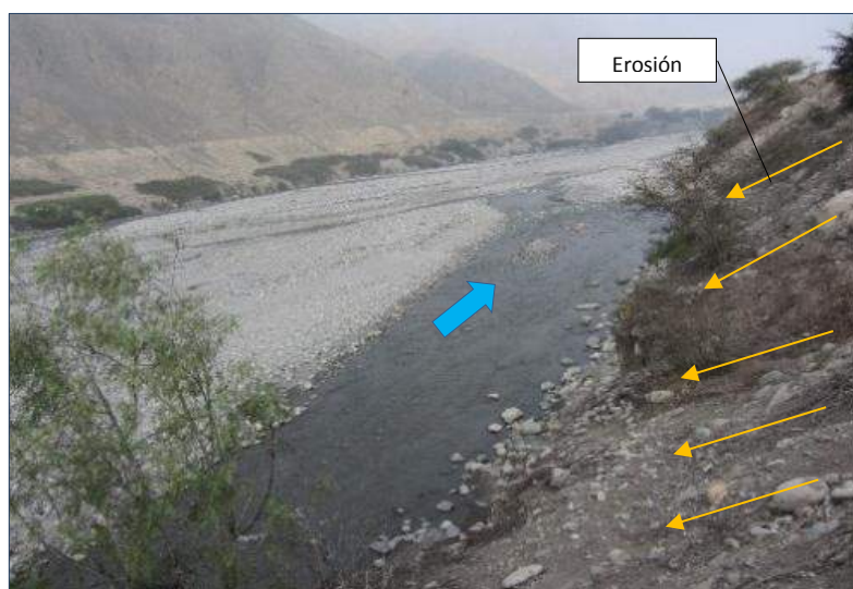
Figura 25. Punto crítico 28 y 29, sector Alpas
