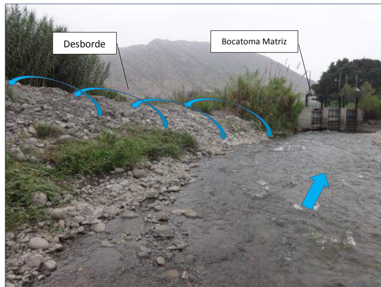
Figura 17. Punto crítico 18, sector Roncador
