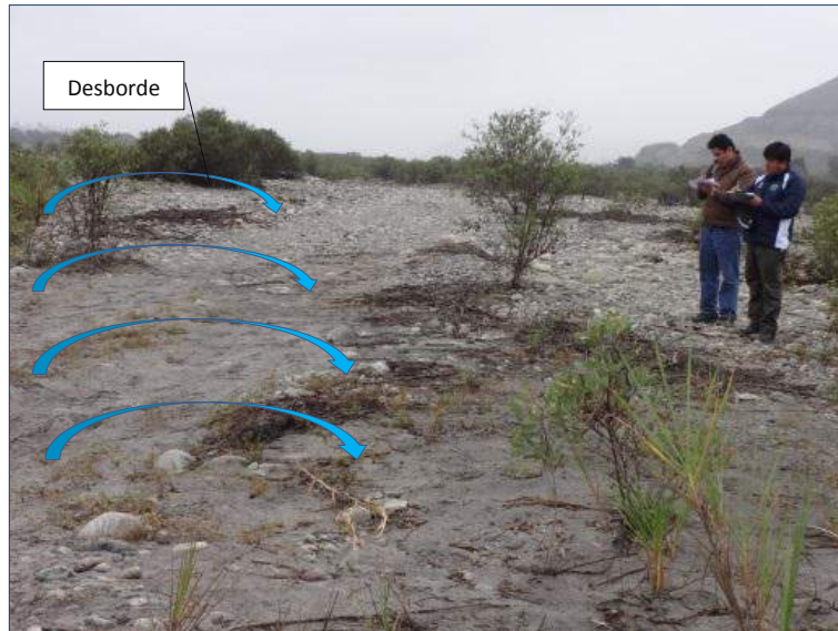
Figura 13. Punto crítico 14, sector Monte Potao
