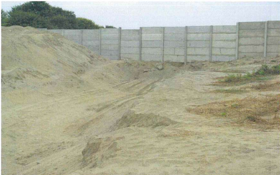
Fot.2.08. Interrupción del cauce norte con una pared de concreto, a, aproximadamente, unos 3 Km. aguas debajo de la carretera Panamericana.
