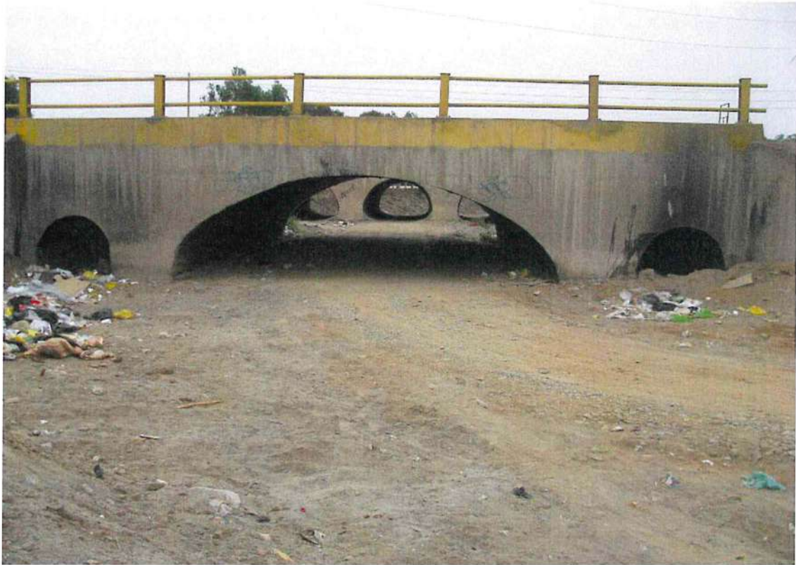
Fot.2.11. Puente alcantarilla en la carretera Panamericana de donde empezaría un hipotético canal que condúzcalas aguas al mar en reemplazo del cauce norte.
