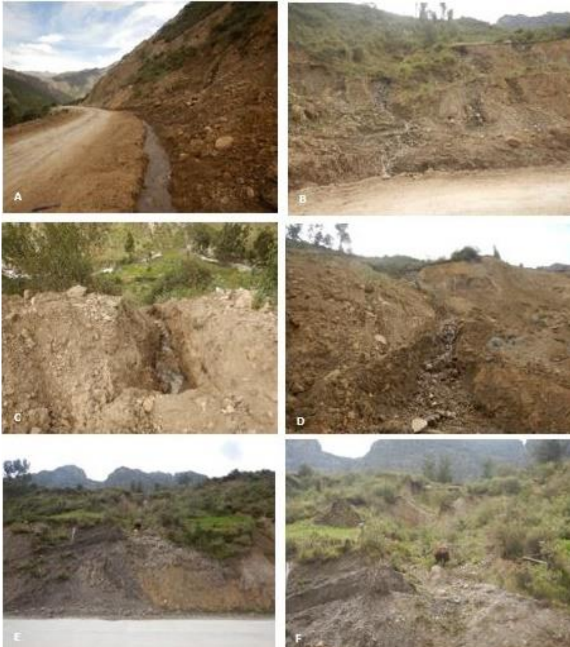
Figura 24. Vista de emanaciones de agua en diferentes puntos de la zona de (A, B, C y D) y colapso de canal de concreto 15 m y tubería de derivación de agua (E y F).
