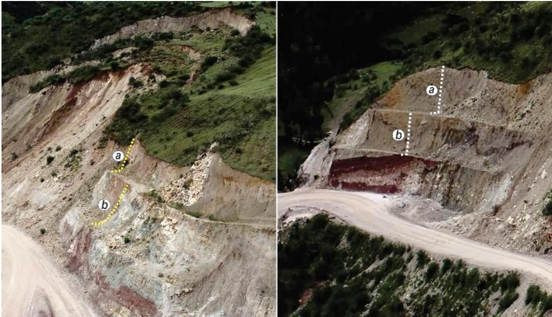
Figura 21. Vista de medidas correctivas (banquetas) erosionadas.
