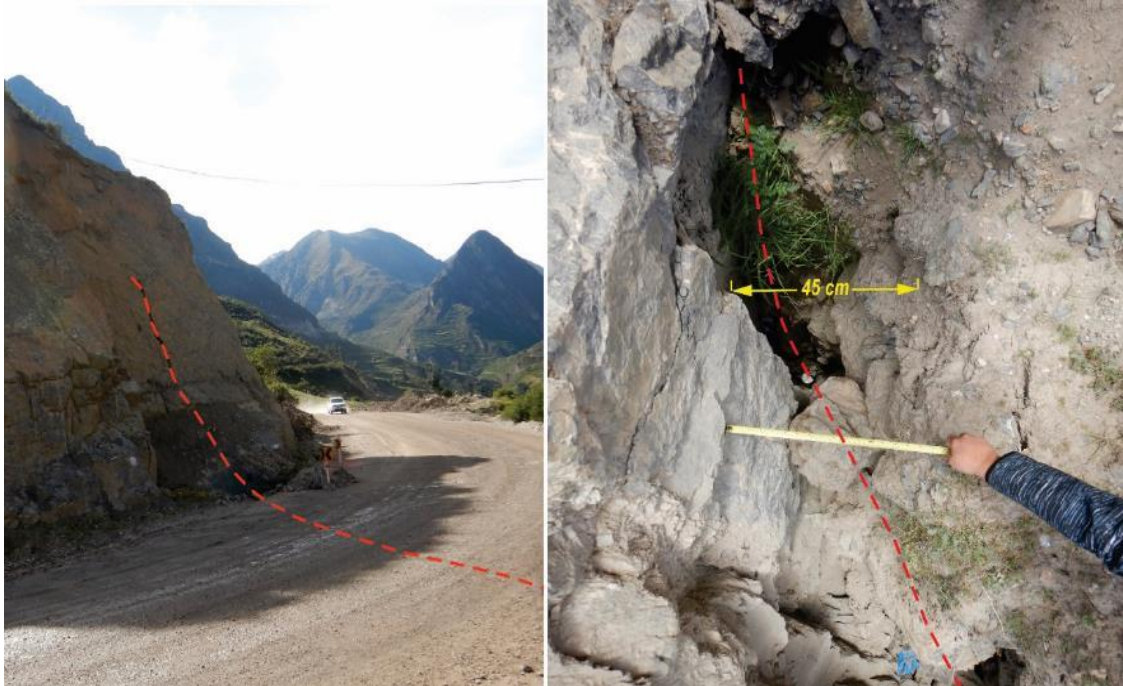
Figura 16. Agrietamiento en carretera, al momento del deslizamiento, el cual llegó a medir 45 cm; la cual fue sellada; a 1 m de la carretera se visualiza el agrietamiento, con un poco de variación (línea entrecortada de color rojo).
