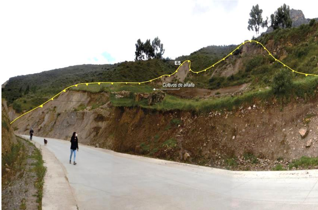
Figura 23. Vista del deslizamiento rotacional ( E5 ), que se desplaza en dirección sur; por donde emana agua subterránea por el cuerpo del evento
