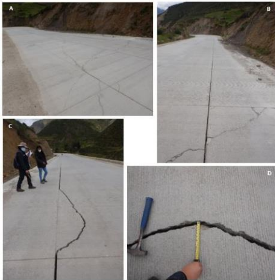
Figura 25. Vista de agrietamiento en vía pavimentada, por el movimiento del cuerpo del deslizamiento (A, B, C y D).
