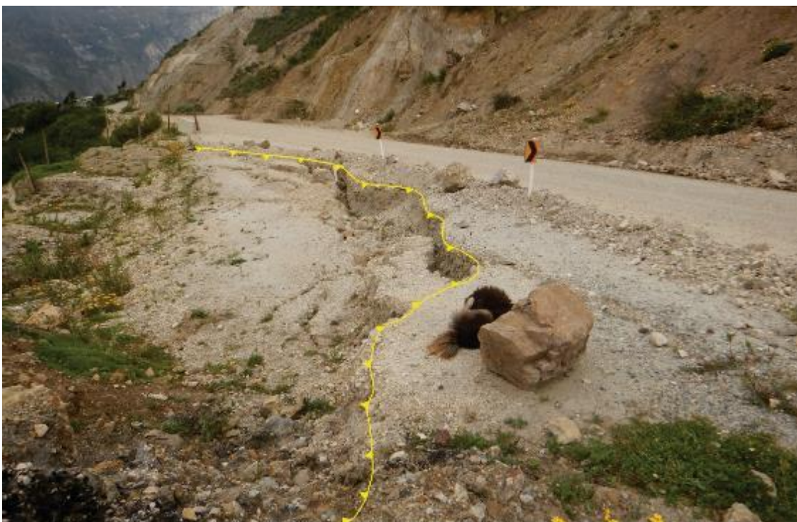
Figura 22. Vista del deslizamiento ( E4 ), con agrietamientos en 2.6 m de la vía,
