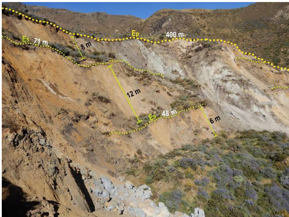
Figura 14. Vista de escarpes múltiples Ep (principal) de forma muy irregular y continua con una longitud de 400 m y salto de 8 m; saltos secundarios (Es) de forma irregular y discontinua con longitudes de 71 m, 48 m y saltos verticales de 6 y 12 m.
