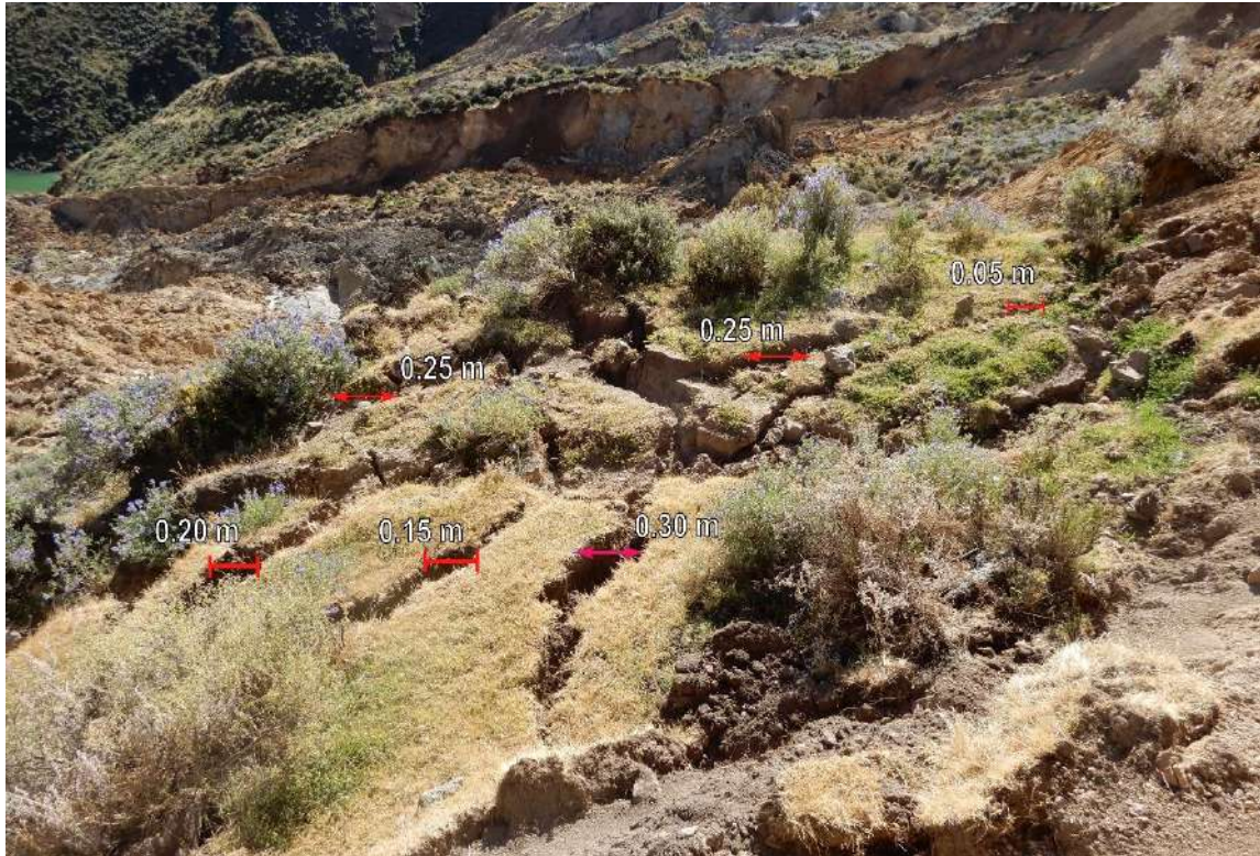
Figura 15. Grietas transversales en la cabeza del deslizamiento con aperturas que varían entre 0.05 y 0.30 m, longitudes entre 2 a 30 m y profundidades visibles que varían entre 0.05 a 0.15 m. Coordenadas referenciales: UTM WGS84 Zona 18S 284534 E, 8839166 N.
