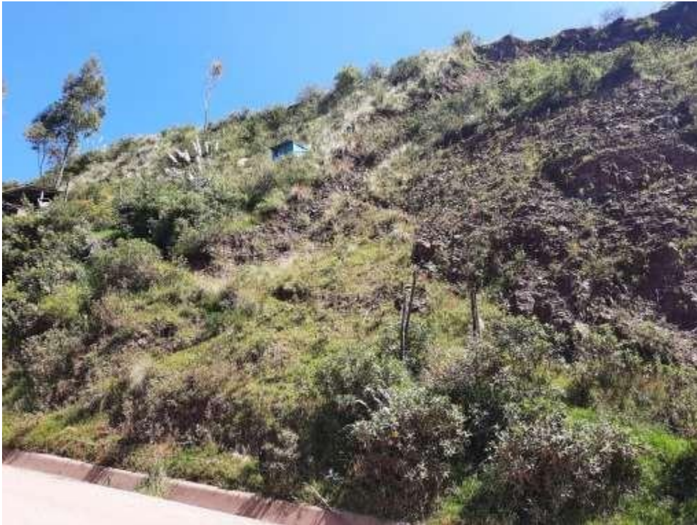
Fotografía 8: Depósitos de deslizamiento suspendido en el corte de carretera CU-117
