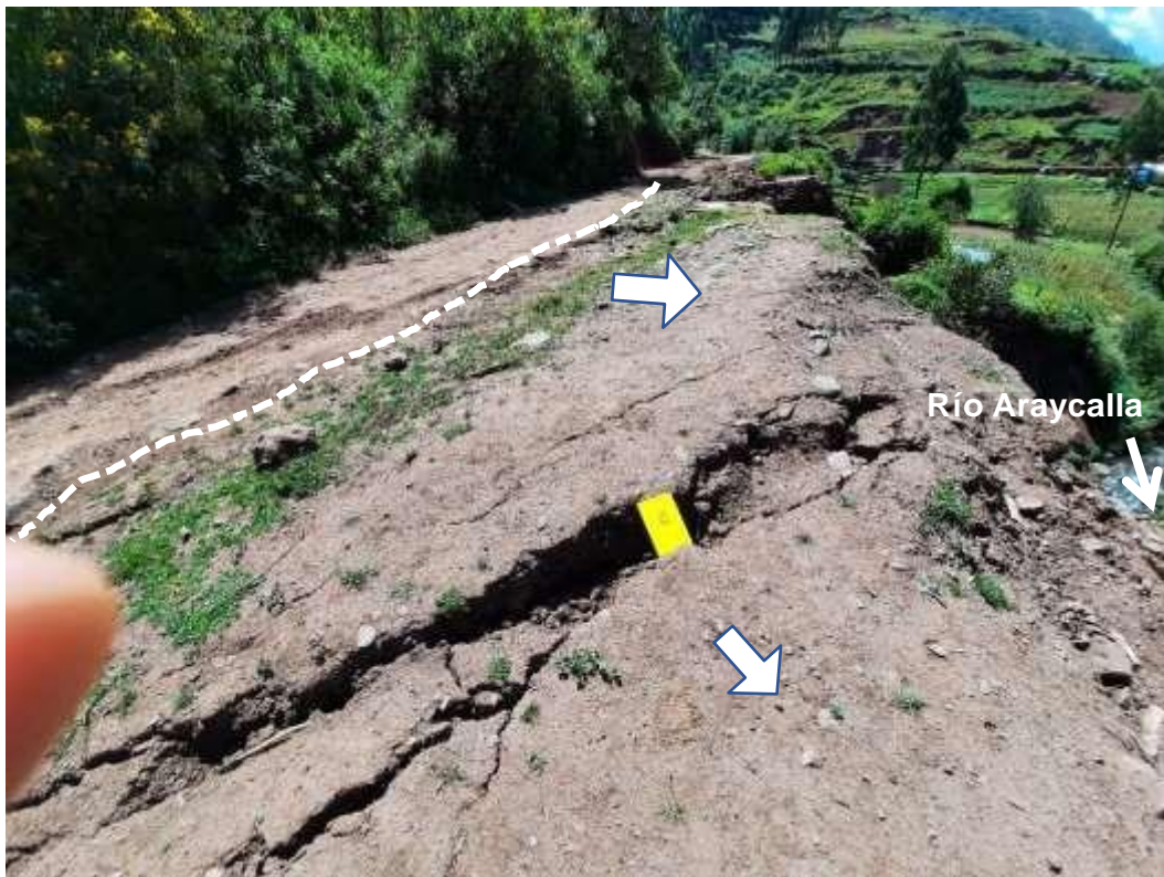
Fotografía 10. Agrietamientos con saltos de 20 cm y >10 cm de apertura, en el flanco izquierdo del derrumbe reactivado (lado derecho del deslizamiento reactivado).
