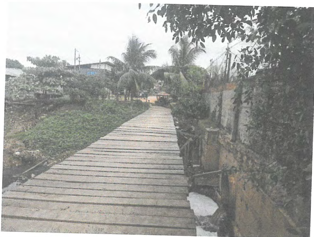
Foto N.º 31, desague expuesto al aire libre.
