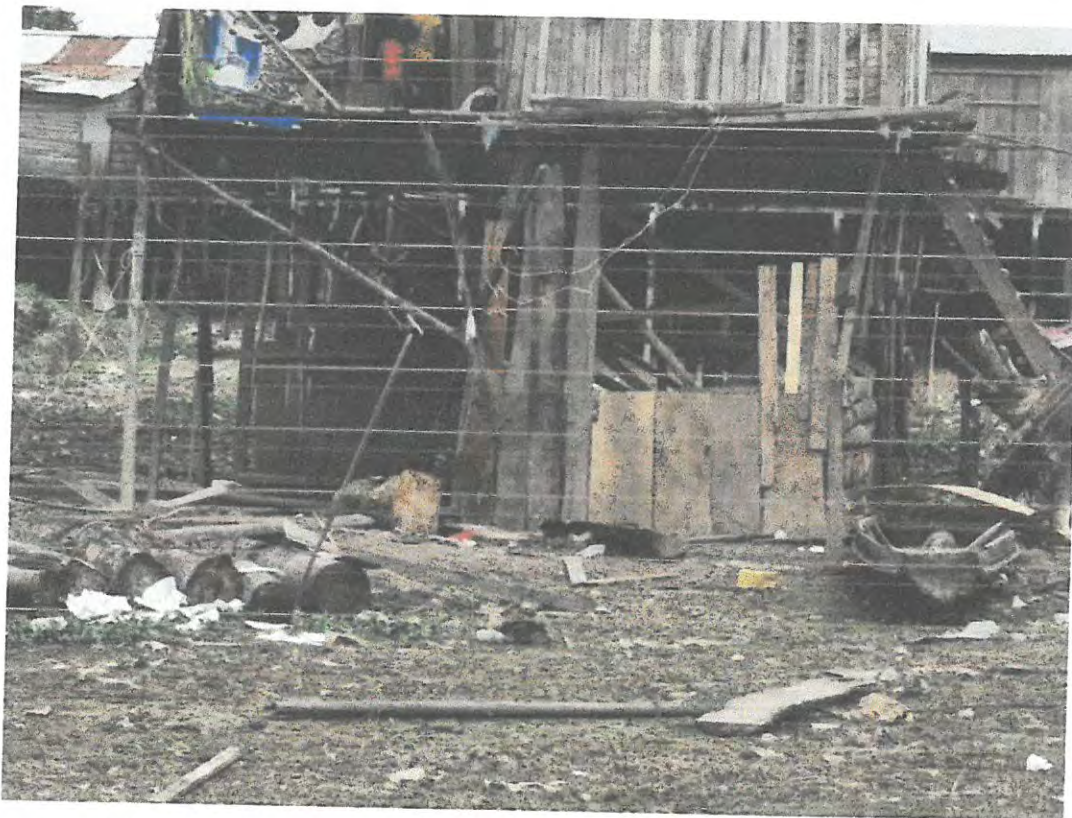
Foto N.º 27, casas de maderas de 1 piso con techos de calaminas y en el suelo residuos de madera.
