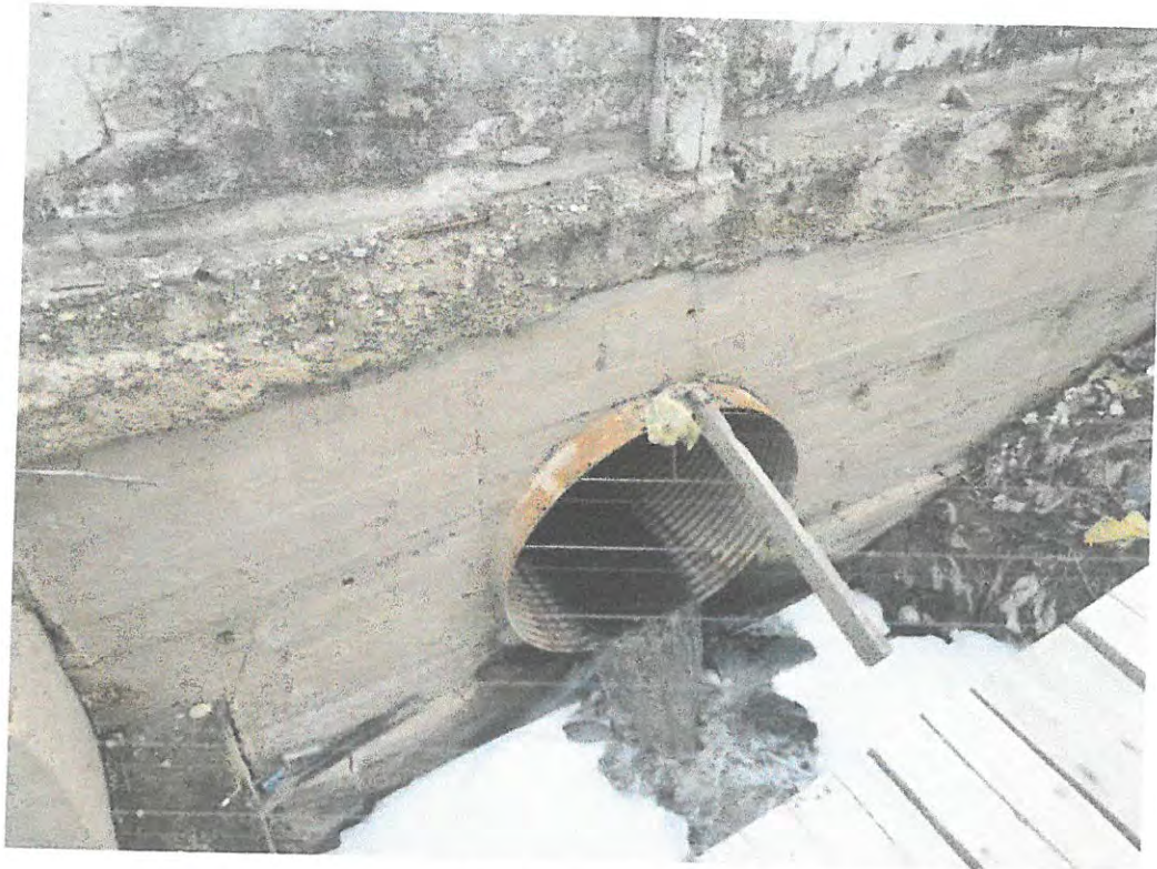
Foto N.º 29, desagüe expuesto al aire libre con desperdicios inorgánicos alrededor.
