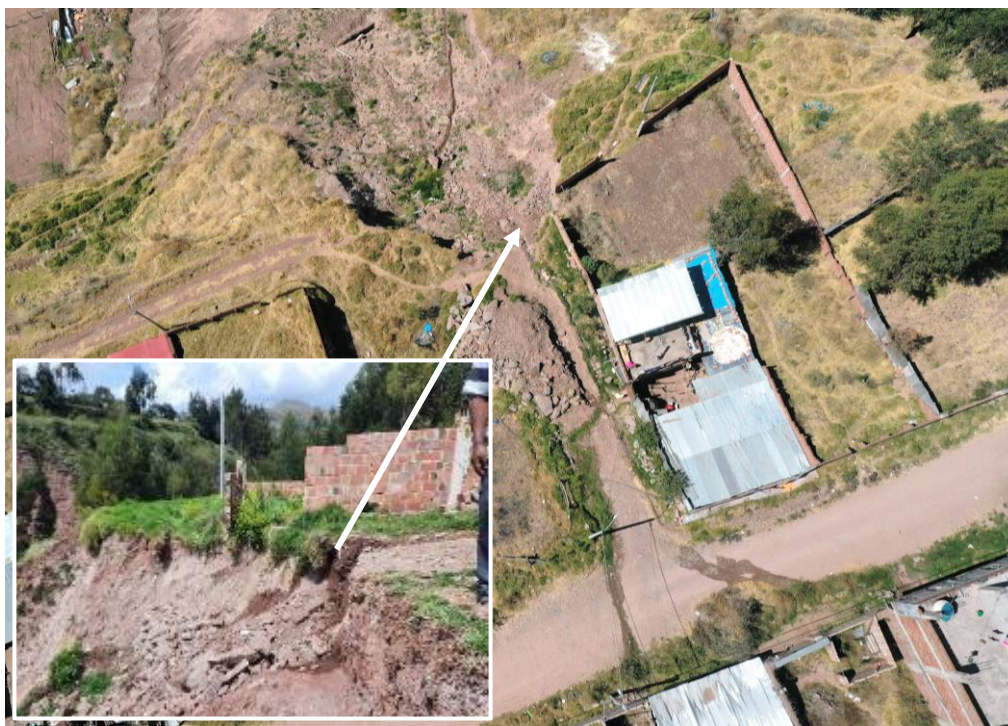
Fotografía 7: Vista de la cabecera del deslizamiento de Pfacchayoq e infraestructura destruida (muro de ladrillos, trocha de 2 m de ancho). Además de aguas residuales domésticas que discurren sobre la cabecera principal del deslizamiento de Pfacchayoq.
