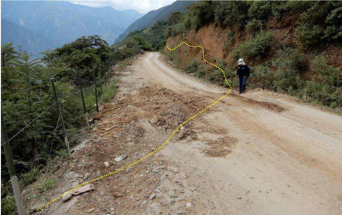
Figura 7. Delimitada con línea amarilla discontinua, se aprecia los rastros de agrietamiento ocurrido en la carretera Chaguas – Pataz, sector La Salvación
