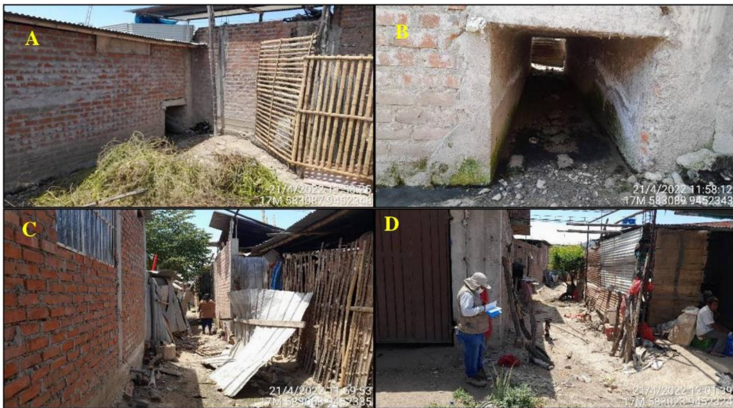
Figura 28.- Recorrido de aguas pluviales a través de canal antiguo (115 m de longitud) de drenaje ubicado en la parte posterior de viviendas situadas entre los Jr. La Colmena y Los Algarrobos, en épocas de precipitaciones el agua proveniente de la calle San Martín de Porres, alcanza alturas de 0.50 – 0.80 m en este sector, causando inundaciones pluviales hasta su desembocadura en la carretera Malingas – Chulucanas, tal como se muestra en las fotos A, B, C y D.
