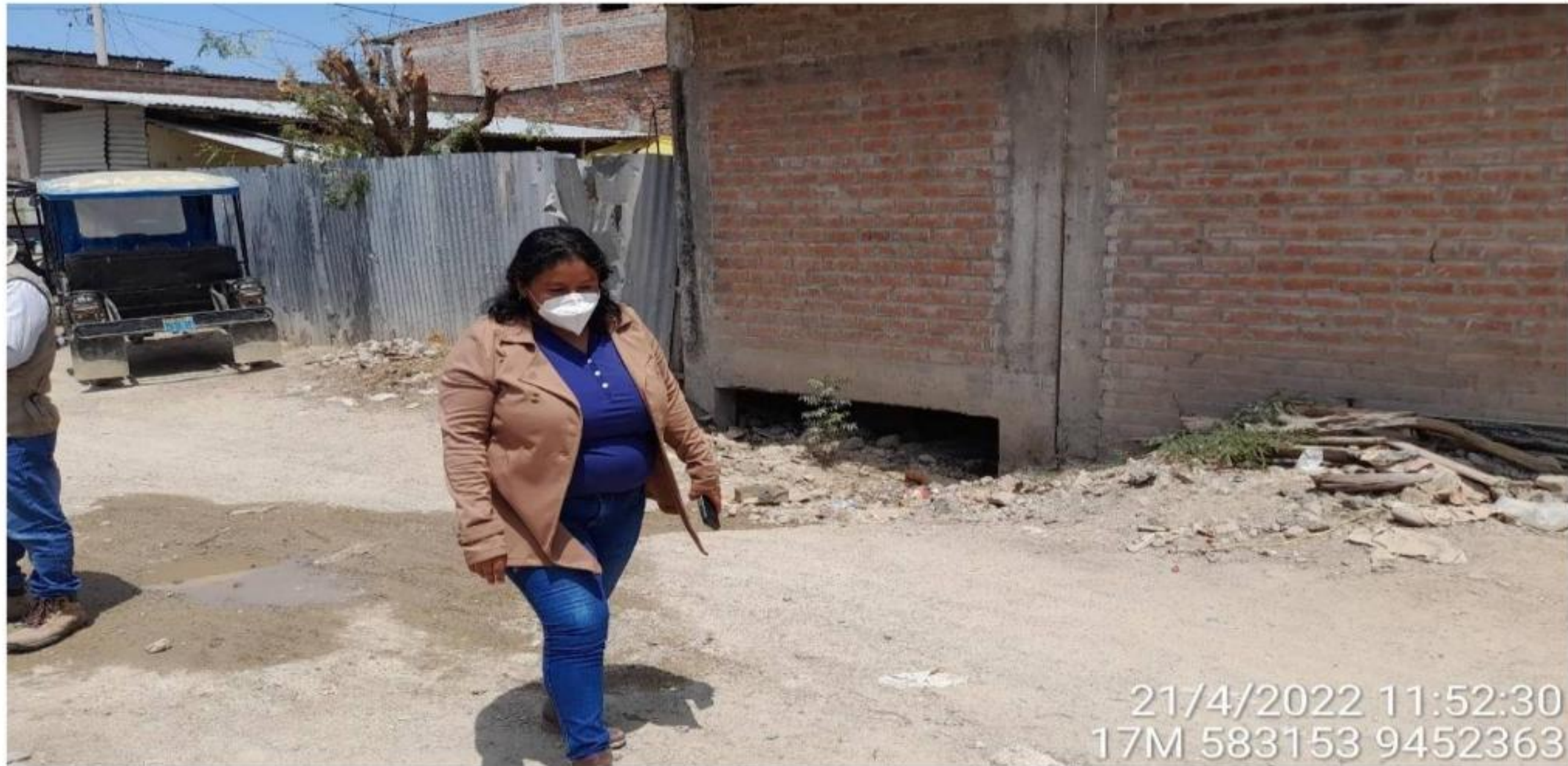
Figura 27.- Canal de drenaje antiguo ubicado en la calle San Martín de Porres donde una vivienda se ubica sobre su cauce
