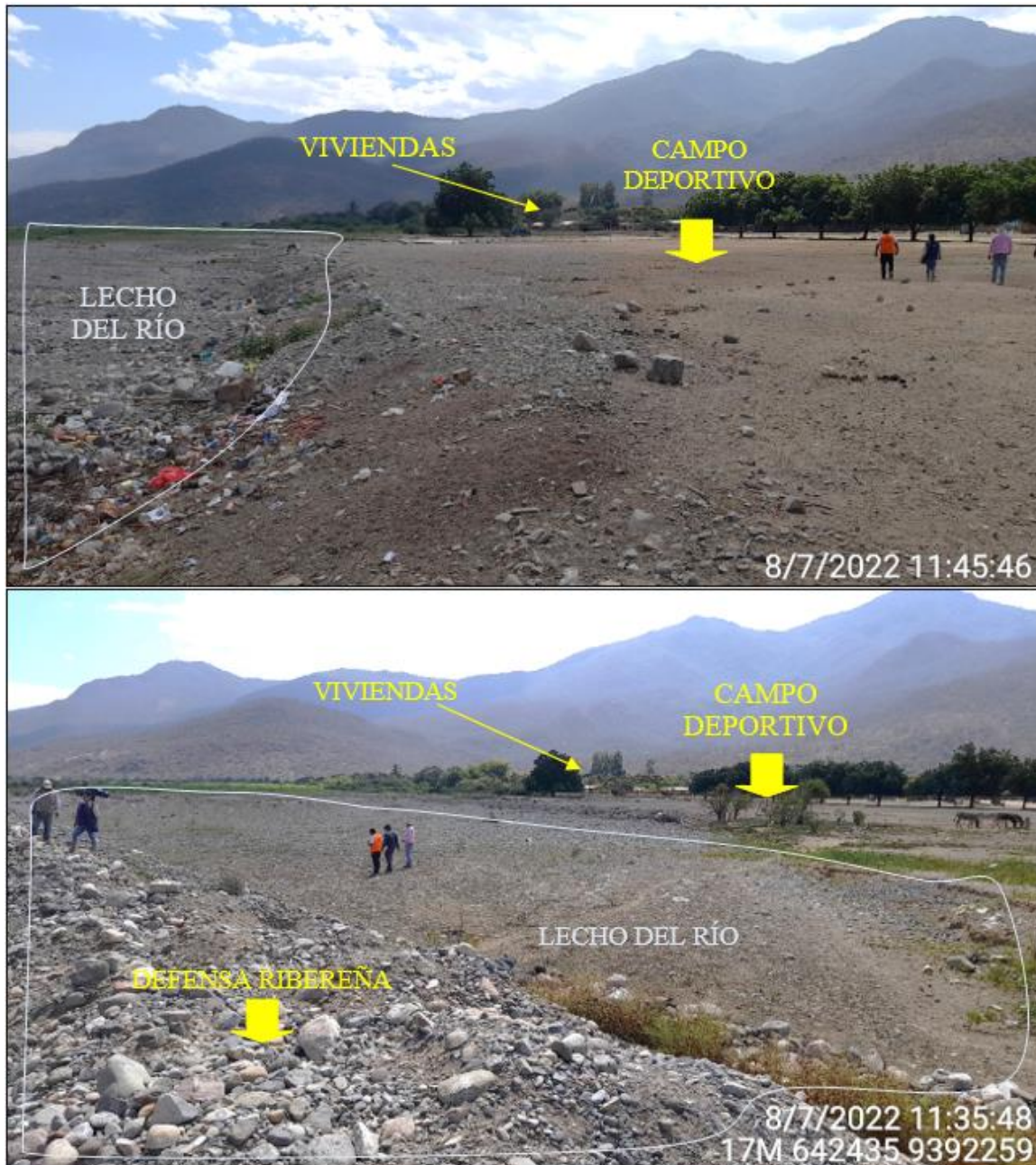
Figura 19.- Defensa ribereña precaria en el margen derecho del río Huarmaca que se ha conformado con la acumulación de material, sin embargo, podría colapsar y afectar las viviendas, campo deportivo y zonas agrícolas de acuerdo con los efectos ocurridos en los años 2017, 2019 y 2021
