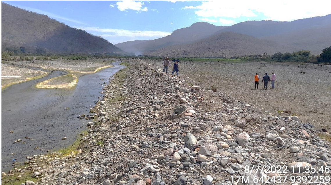
Figura 20.- Defensa ribereña en el margen derecho del río Huarmaca que probablemente podría ser afectada ante el incremento del caudal en temporada de lluvias, generando inundaciones en el caserío Mamayaco
