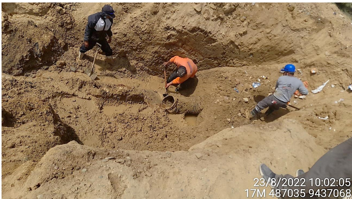
Figura 19.- Ruptura de tubería de drenaje que produjo colapso de un buzón de desagüe y deslizamiento en las inmediaciones del Cerro Llorón, las aguas evacuadas tienen caudal constante y son aguas aparentemente limpias
