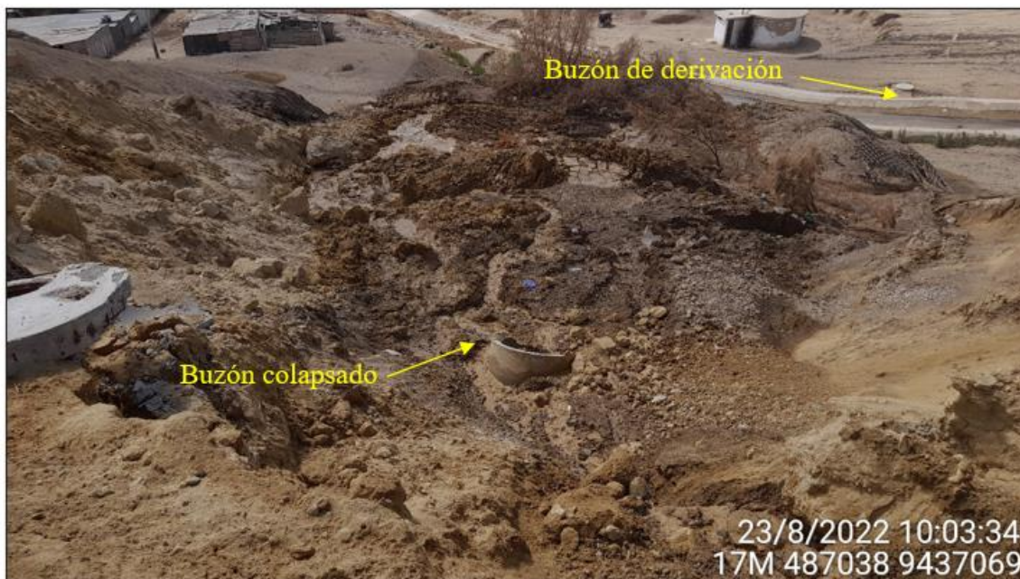
Figura 20.- Colapso de buzón de captación de agua en la ladera del cerro Llorón que drenaba agua hacia el buzón de derivación ubicado en la parte baja y finalmente hasta la red de desagüe principal del distrito de Paíta
