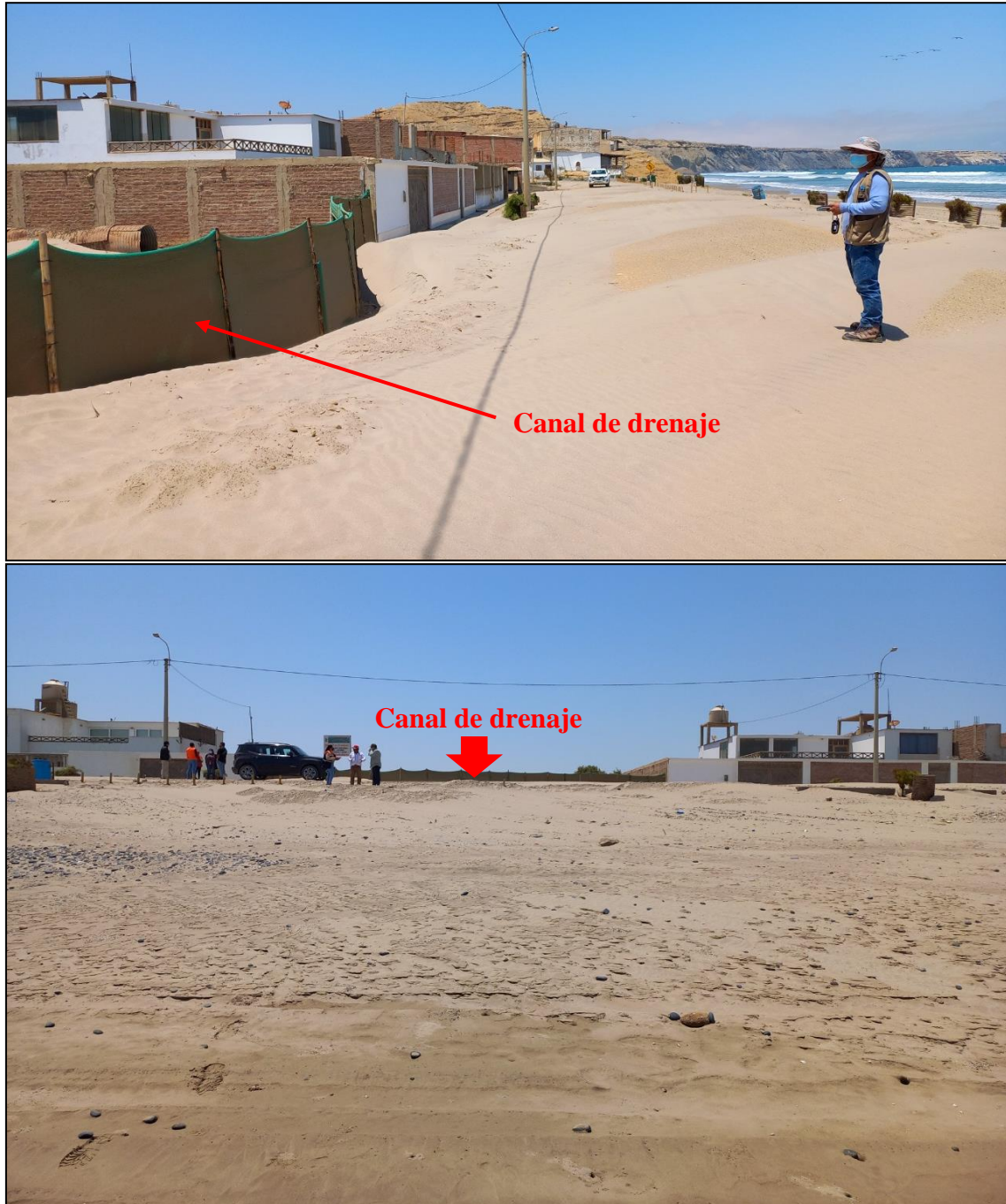
Figura 28.- Ubicación de canal de drenaje conformado con lozas de concreto que se ubica detrás de malla verde, la imagen superior muestra que ha sido obstruido por la construcción de la vía de acceso y la imagen inferior ha sido capturada desde su antigua desembocadura en el mar
