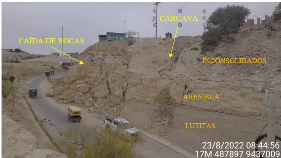
Figura 15.- Caída de rocas en la ladera ubicada en la parte baja del A.H. Vista al Mar cuyos bloques desprendidos afectan la vía asfaltada de la Av. 9 de Octubre, viviendas contiguas al talud y postes de tendido eléctrico
