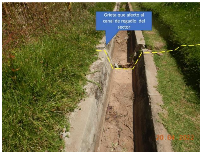
Figura 8: Grieta tensional en dirección perpendicular al deslizamiento que afecta al canal de regadío del sector.
