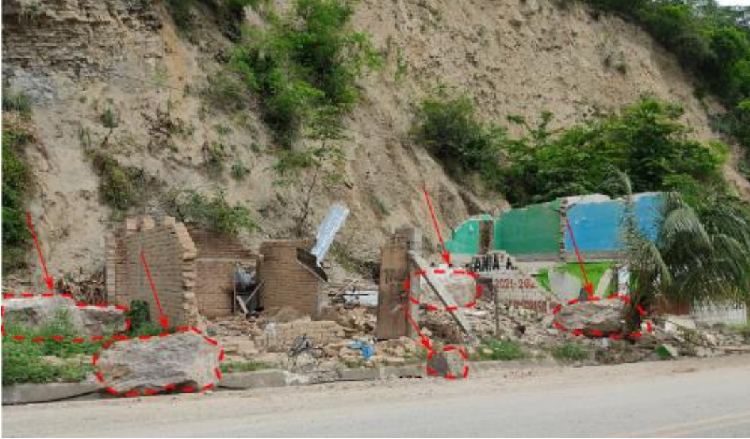
Figura 11. Bloques con tamaños mayores a los 3.00 m destruyeron viviendas y afectaron cunetas de drenaje de la vía principal.
