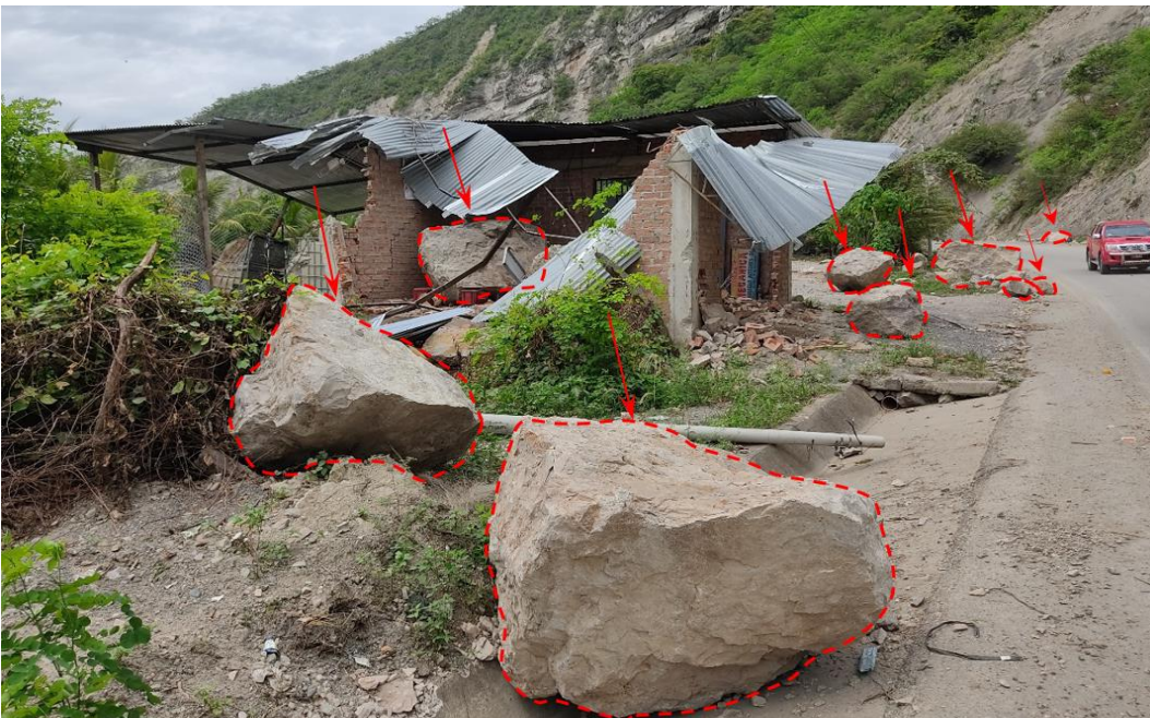
Figura 12. Bloques con tamaños mayores a los 2.00 m destruyeron almacén de venta de combustible afectaron cunetas de drenaje de la vía principal.
