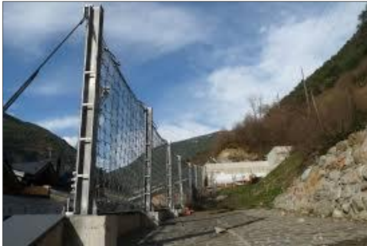
Figura 35. Ejemplo de barrera estática construida para protección de caída de rocas
