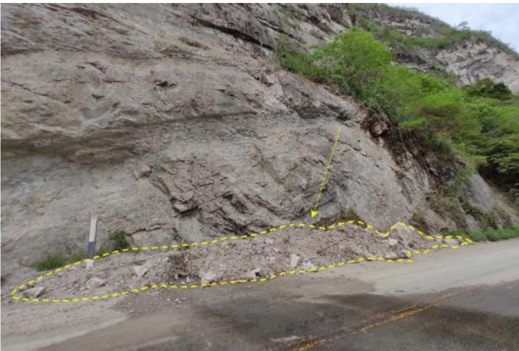
Figura 16. Material caído (fragmentos de roca) que originó la colmatación de las cunetas de drenaje, afectando la vía asfaltada.
