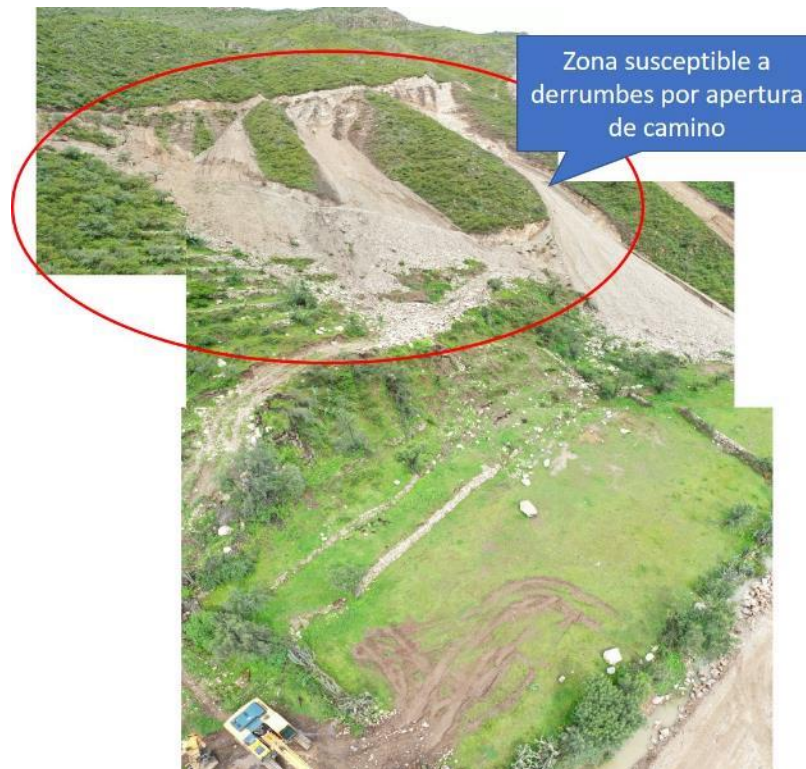
Figura 5. Vista a la margen derecha, se aprecia el vertimiento de material a la ladera, proveniente de la apertura de camino, los cuales son altamente potenciales a la generación de derrumbes.
