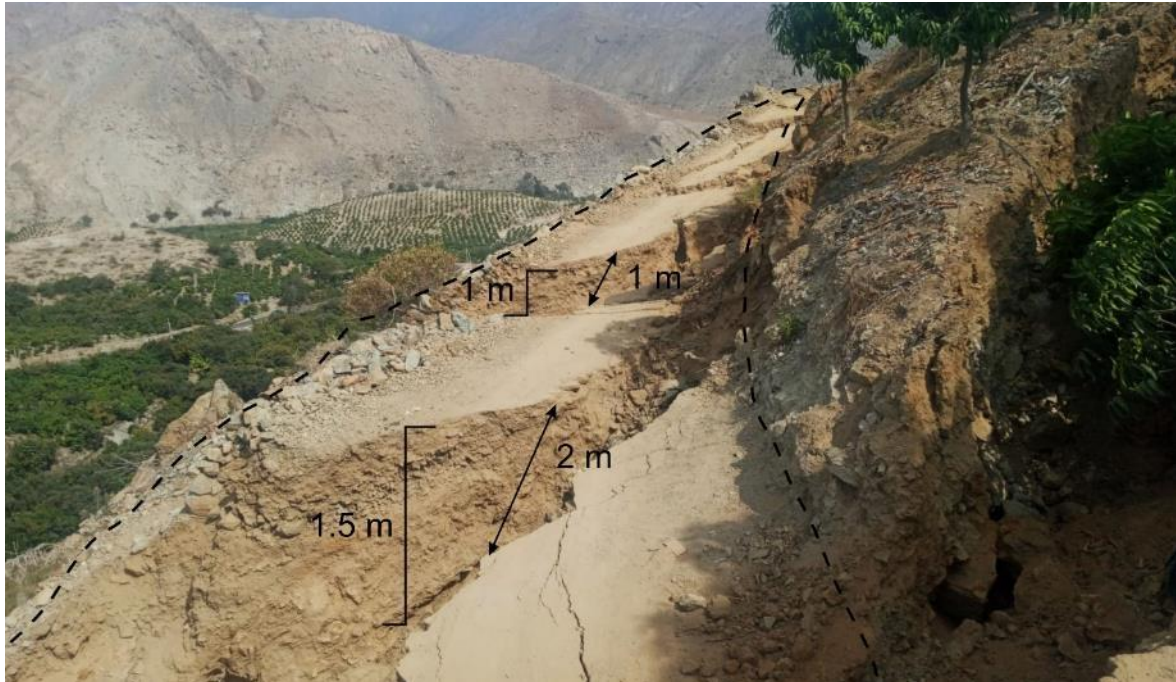
Figura 23. Tramo de 58 m de largo de la trocha carrozable afectada.
