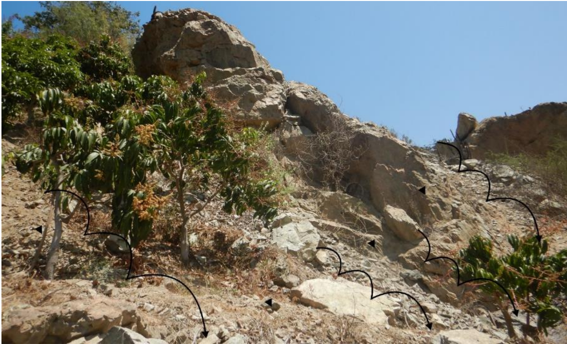
Figura 18. Vista de rocas en la parte inferior del deslizamiento DRA.
