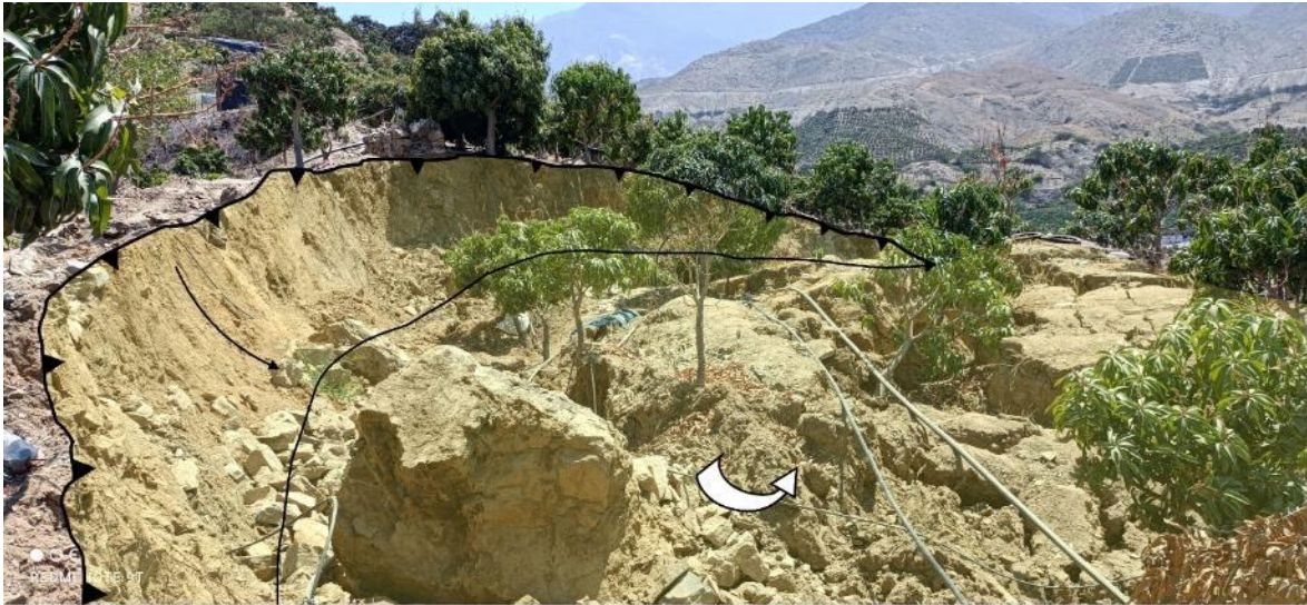
Figura 13. Escarpe visto desde el flanco derecho del deslizamiento.
