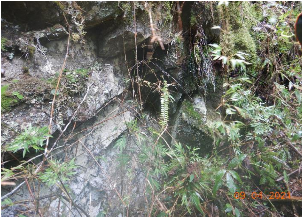
Figura 7. Bloques sueltos dispuestos a caer desde la ladera del cerro.
