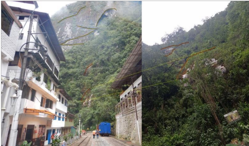
Figura 3. Vista tomada en coordenadas E 768107; N 8544511; Sector Media Naranja, se aprecia en la ladera bloques rocas sueltas propensas a ceder y el fracturamiento del macizo rocoso.
