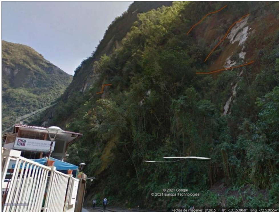
Figura 5. Vista tomada en coordenadas E 768000; N 8544528. Sector Media Naranja, en la ladera se aprecia la roca fracturada (señal color rojo). En la parte baja se aprecia la reja del parque de niños y la construcción del Poder Judicial que fue afectado por la reactivación de caída de rocas (extraído de Google Earth).
