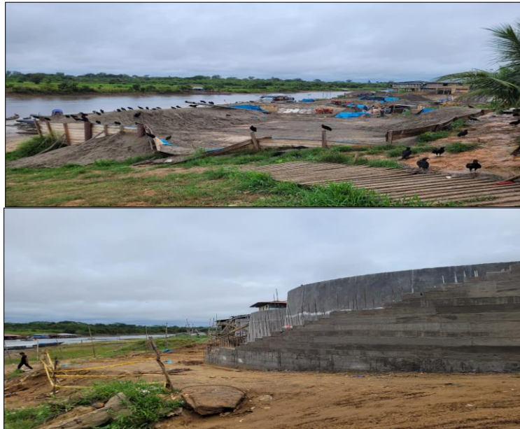
FIGURA N°03: OBRAS VULNERABLES REALIZADAS EN LAS RIBERAS DEL RÍO CABALLOCOCHA POR PARTE DE LA MUNICIPIALIDAD PROVINCIAL DE MARISCAL RAMON CASTILLA, CON EL FIN DE MITIGAR LOS DAÑOS CAUSADOS POR LA EROSION PRESENTE EN LA ZONA.
