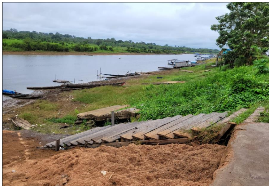
FIGURA N°02: ZONA AFECTADA POR EROSION EN LA RIBERAS SE ENCUENTRA LA LOCALIDAD DE CABALLOCOCHA
