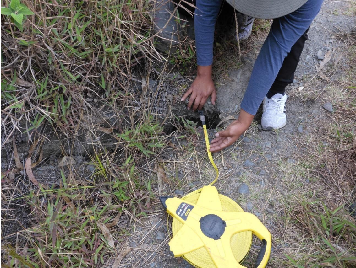
Figura 21. Agrietamientos en el sector de Pampa Tuana (UTM E: 450994, N: 8415410)
