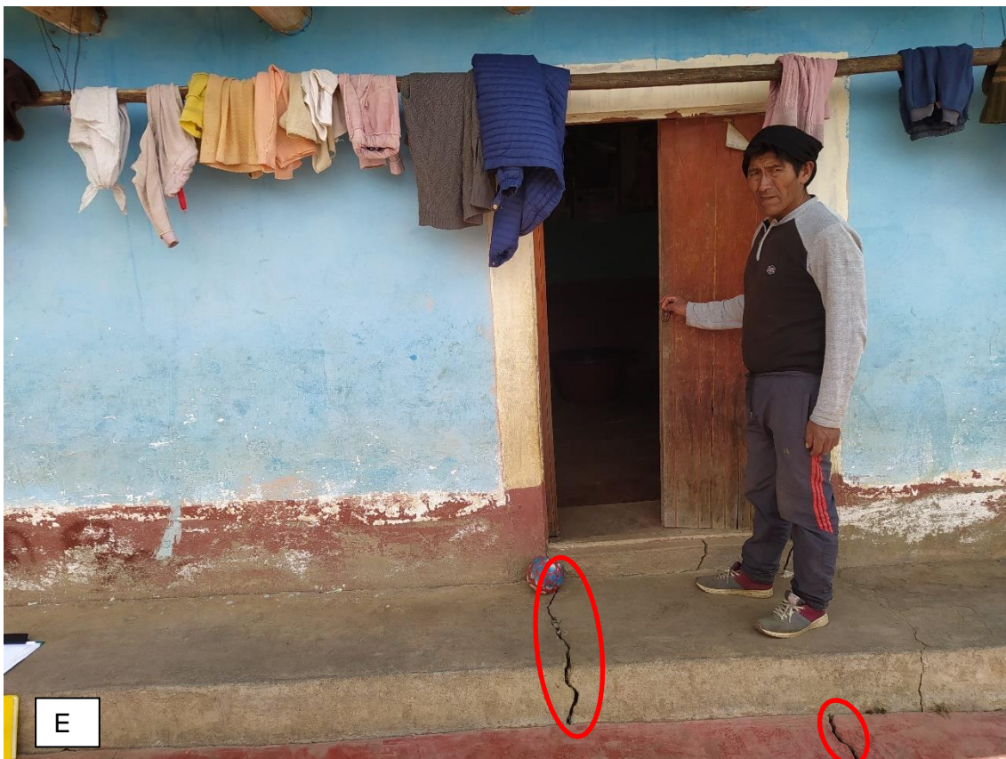
Figura 13: Vivienda con agrietamientos en las coordenadas UTM E:450643, N:8413460.
