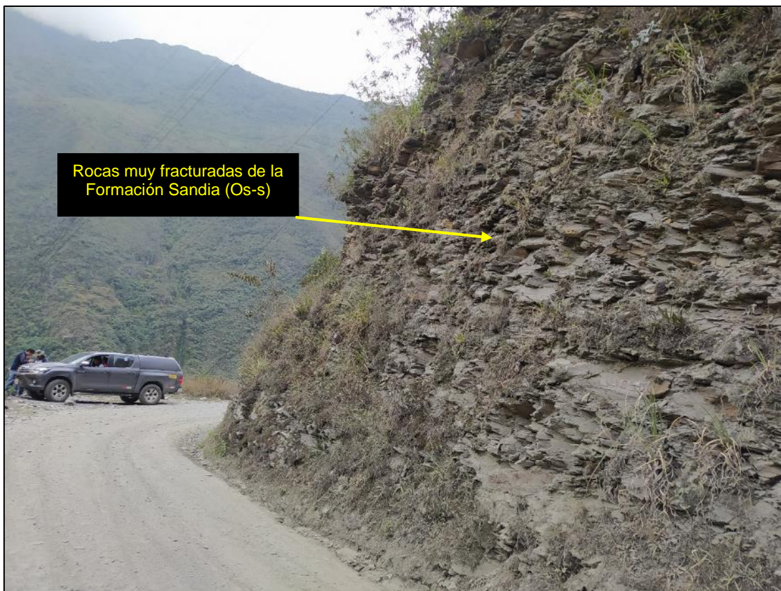
Figura 2. Afloramiento rocoso fracturado de la Formación Sandia, corte de talud en el cerro Japuna, margen izquierda del río Sandia (coordenadas UTM E: 449770, N: 8415925).
