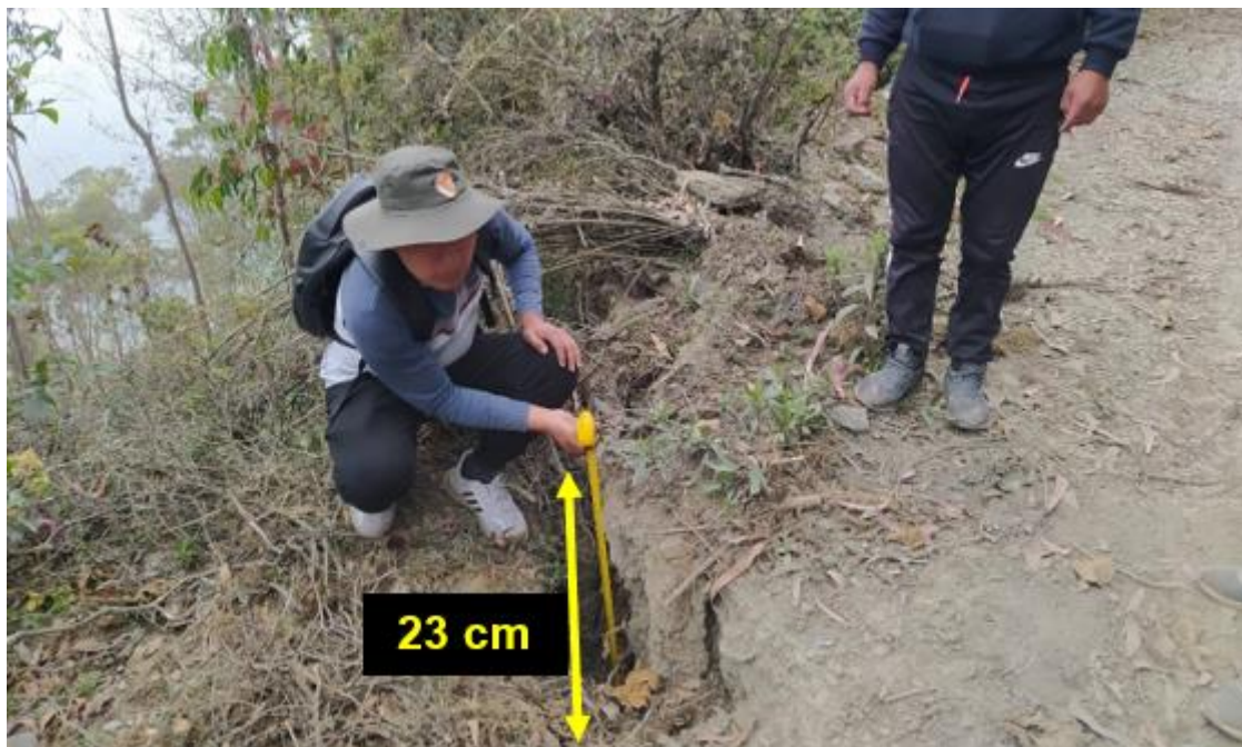
Figura 11. Agrietamientos en la carretera Suara - Ccajuna (UTM E: 450441, N: 8413451).
