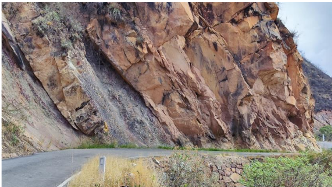
Fotografía 2: Se observa un macizo rocoso de areniscas medianamente a muy fracturadas, intercaladas con lutitas, muy fracturadas y ligeramente meteorizadas. Coordenada UTM WGS-84, 18S: E: 170044; N: 9242015; altitud:1554 m s.n.m.
