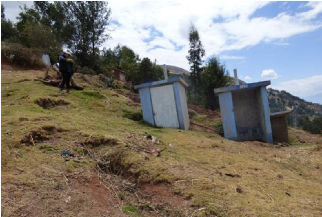
Fotografía 8. Vista de los baños de servicio público, donde se evidencia una inclinación de la infraestructura por el movimiento lento del terreno, ubicado con coordenadas UTM (WGS 84): 574516.148 E; 8541940.940 N
