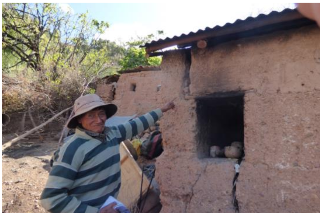
Fotografía 10. Vista de vivienda cuya pared presenta grietas con 8 cm de abertura y una longitud de 2 m, producto de los sismos ocurridos en el año 2020, ubicado con coordenadas UTM (WGS 84): 574476.422 E; 8542143.179 N
