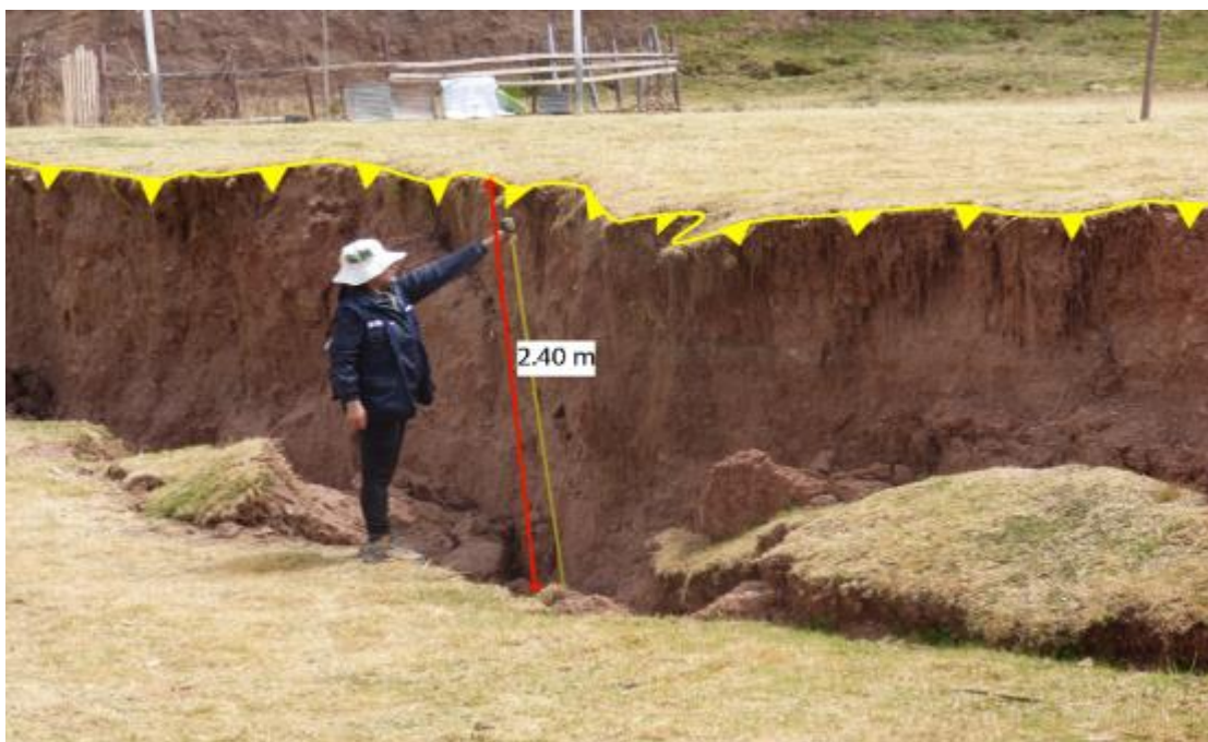
Figura 11. Vista del escarpe principal de forma irregular y continua con una longitud de 140 m, con un salto de hasta 2.40 m.
