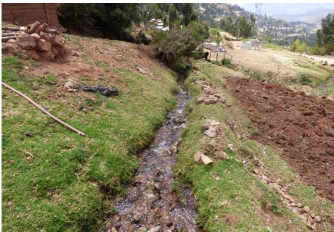
Fotografía 7. Vista del canal de riego, el cual se encuentra sin revestimiento permitiendo la infiltración del agua al suelo.
