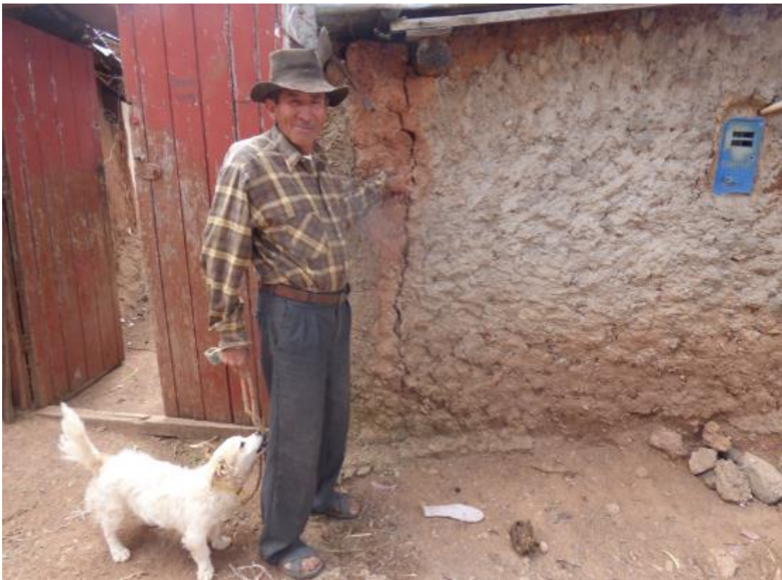
Fotografía 9. Vista de vivienda cuya pared presenta grietas con 2 cm de abertura y una longitud de 2 m, ubicado con coordenadas UTM (WGS 84): 574537.816 E; 8541943.949 N.
