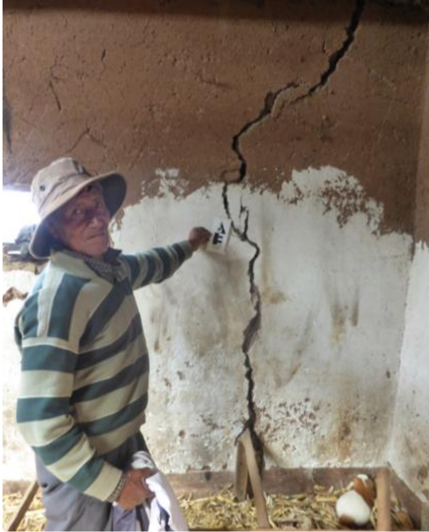
Fotografía 11. Vista de vivienda cuya pared presenta grietas con 4 cm de abertura y una longitud de 2.5 m, producto de los sismos ocurridos en el año 2020, ubicado con coordenadas UTM (WGS 84): 574452.948 E; 8542203.370 N
