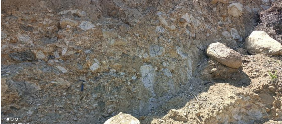
Fotografía 4. Vista de los depósitos coluvio deluviales en la ladera afectada por el deslizamiento.
