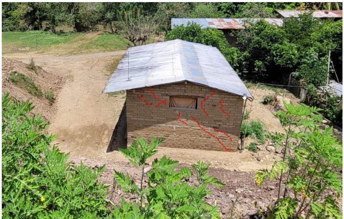
Figura 12. Vivienda afectada (con grietas en la pared, líneas rojas discontinuas).
