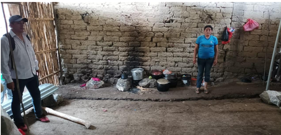
Fotografía 6. Detalle del tipo de materiales de construcción de una vivienda en peligro.
