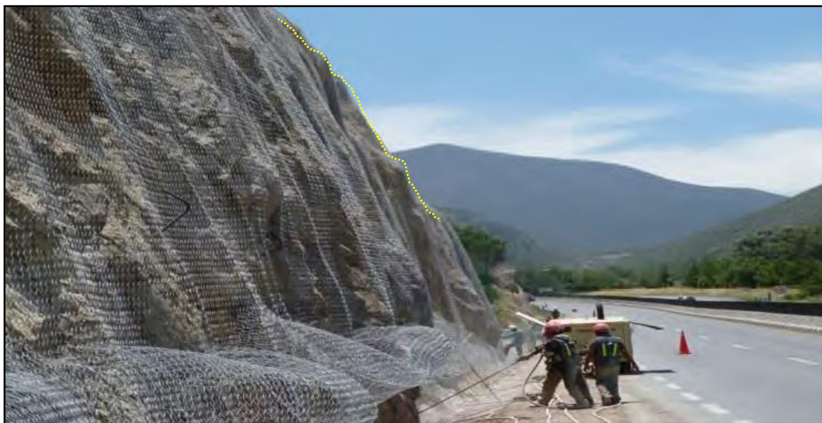
Figura 76. Mallas de protección con anclajes para caída de rocas o derrumbes tanto en detritos como roca alterada, (Vilches, 2021)
