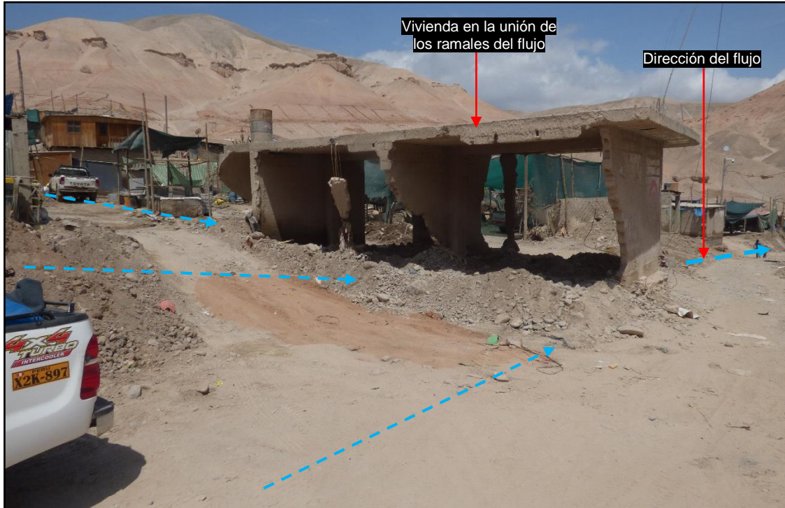
Figura 48. Vivienda ubicada en el cauce de la quebrada, punto en el que se unen los ramales; únicamente se mantienen los muros dispuestos en la misma dirección del flujo, (coordenadas UTM WGS84: 692608E, 8234978N)
