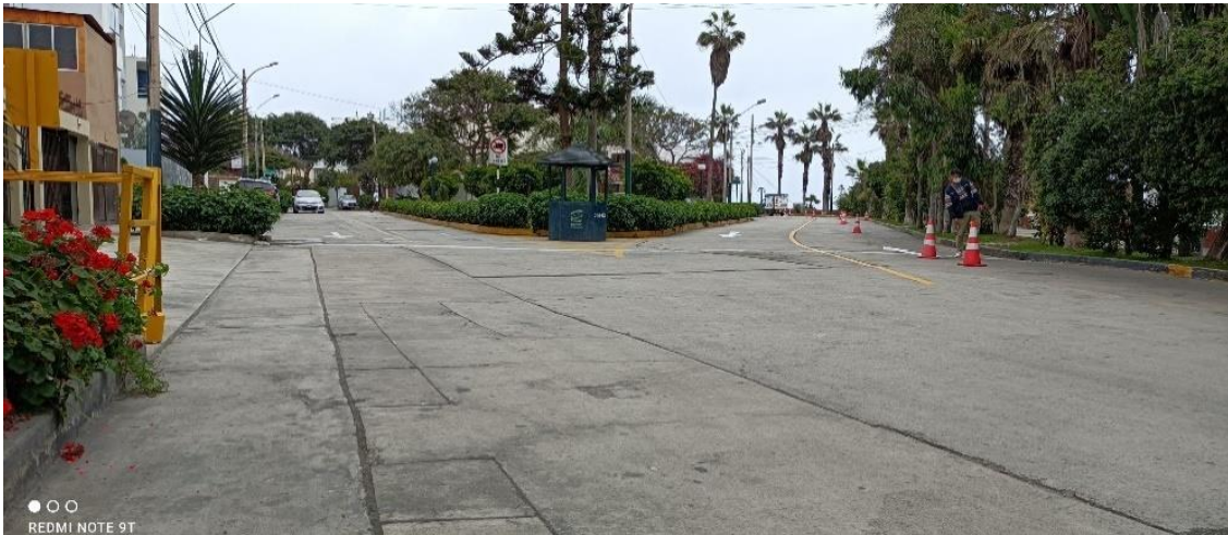
Figura 290. Grietas longitudinales de 34 m de largo.
