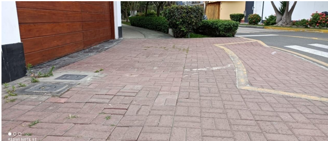
Figura 313. Hundimientos inventariados sobre antiguas cárcavas.
