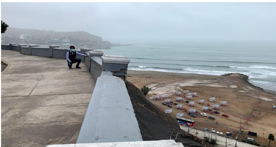
Figura 367. Muro inclinado en Malecón Costa Sur.
