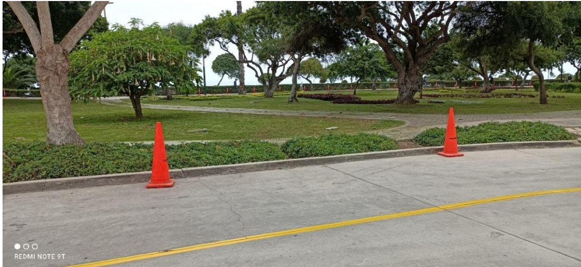
Figura 308. Grietas longitudinales con aberturas de pocos centímetros.
