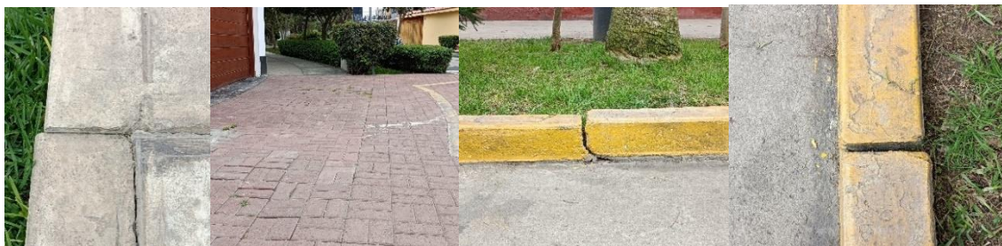
Figura 289. Grietas y desplazamientos de hasta 7 cm.
