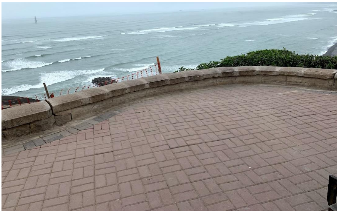
Figura 346. Grietas en muros de malecón Souza.
