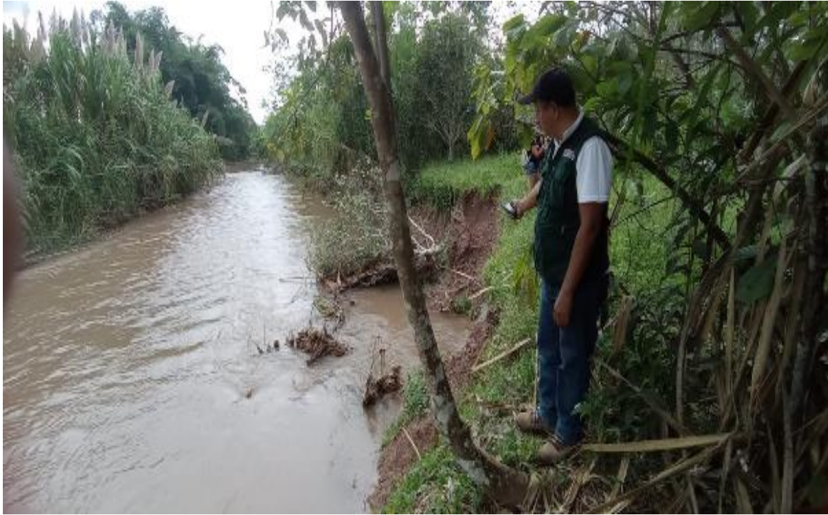
FIGURA N°02: TRAMO CRÍTICO EN EL RIO ANDA, SE OBSERVA LA EROSION DEL TALUD DE LA MARGEN DERECHA
