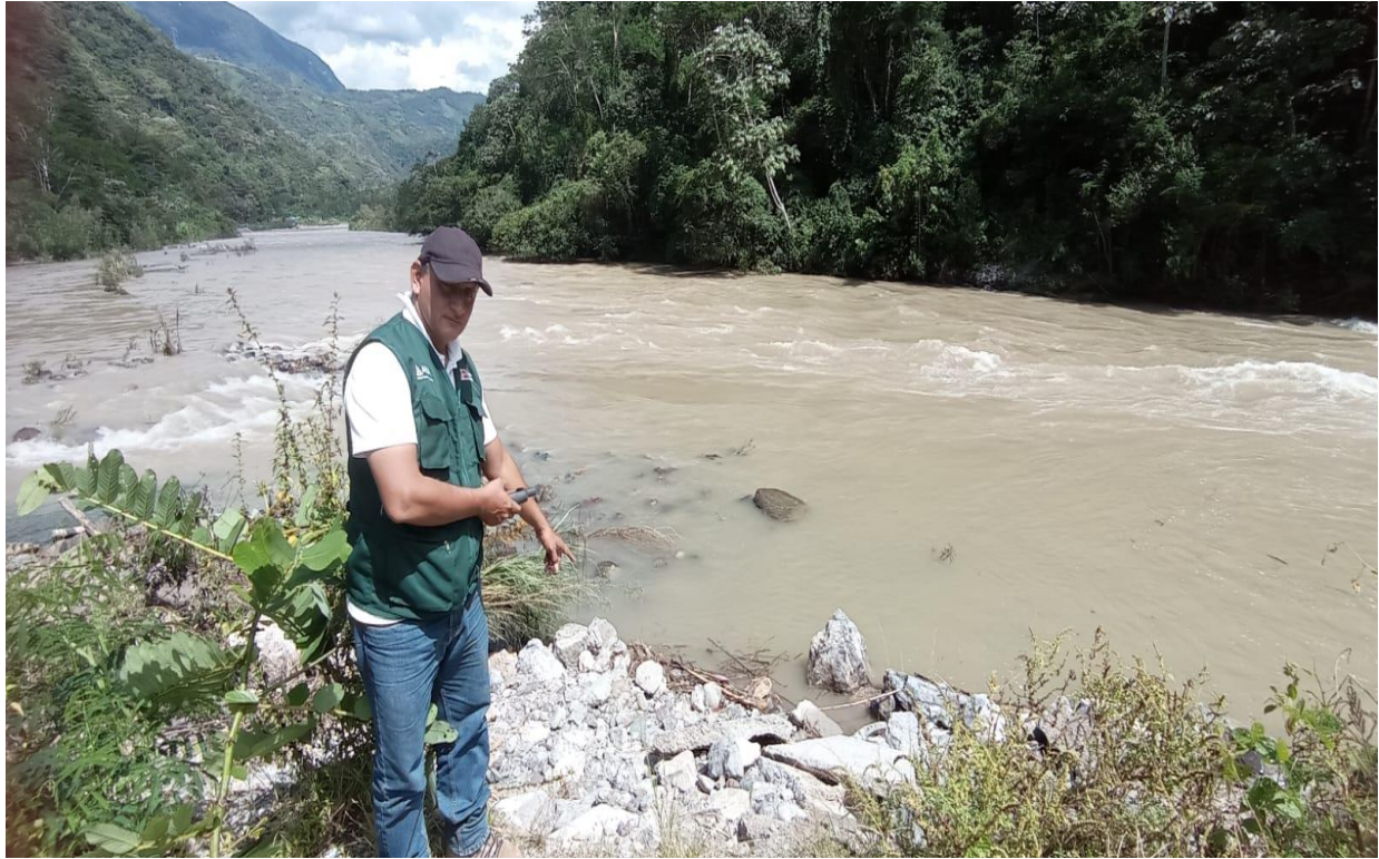
FIGURA N°02: TRAMO CRÍTICO EN EL RIO HUALLAGA, SE OBSERVA LA EROSION DEL TALUD DE LA MARGEN DERECHA
